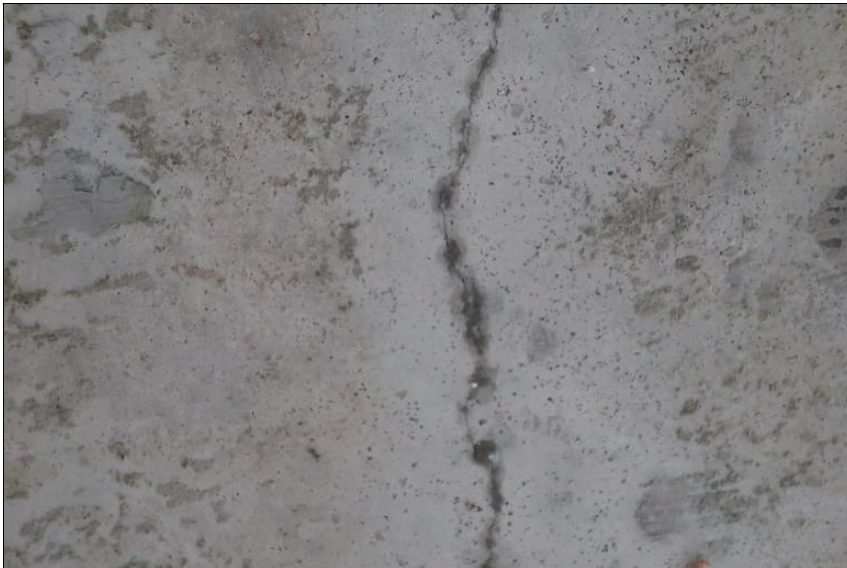
detail zavlhlé trhliny na spodním líci nosníku
