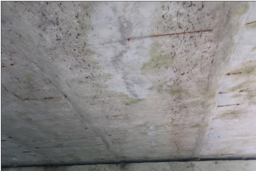
nepravidelné zavlhlé trhliny na spodním líci 2. nosníku 1. pole u O1 jsou charakteristické pro mrazový rozpad
