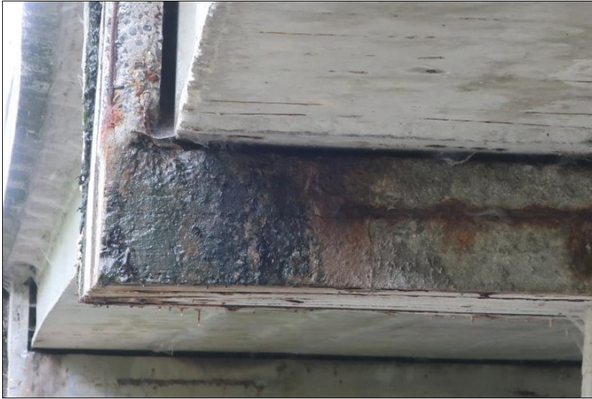
výrazné průsaky z úložné spáry pod 10. nosníkem u P2 ve 2. poli
