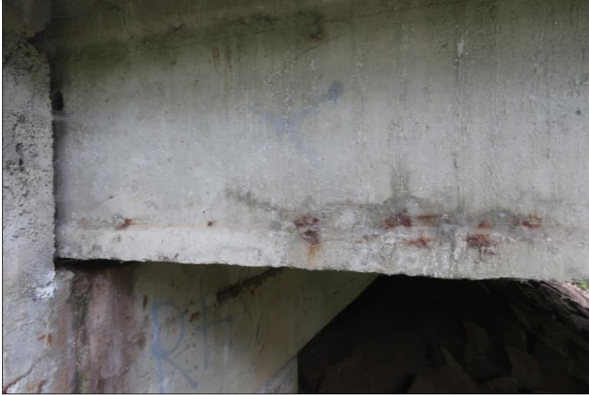
zavhlé trhliny kopírující trajektorii předpínací výztuže na vnějším boku 10. nosníku
