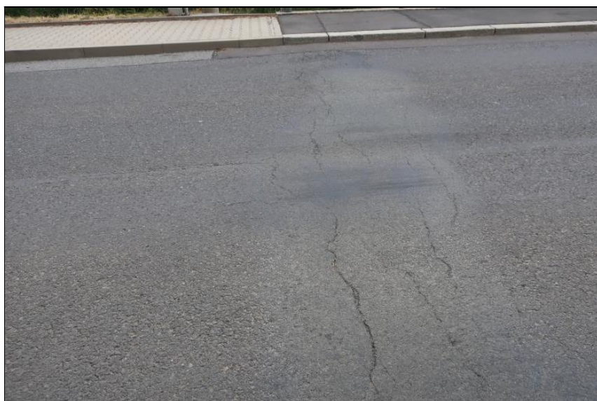
příčné trhliny v krytu vozovky nad opěrou O1
