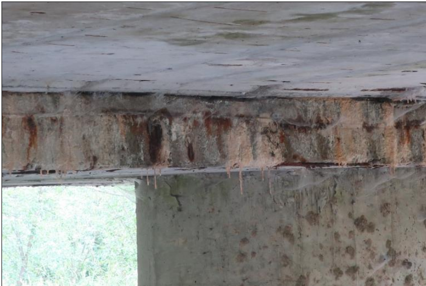
průsaky s výluhy pojiva jsou v celé délce stativa P2
