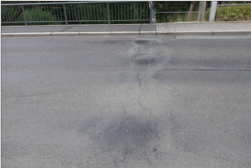
trhliny v krytu vozovky na d O3
