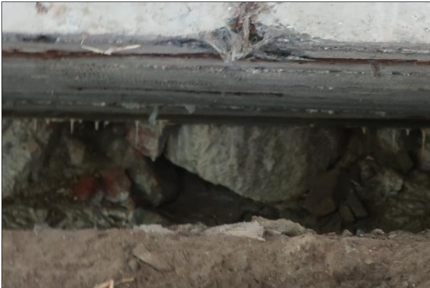
na spodním líci úložné prahu opěry 1 je v oblastech nedostatečné tloušťky krycí vrstvy obnažená korodující výztuž
