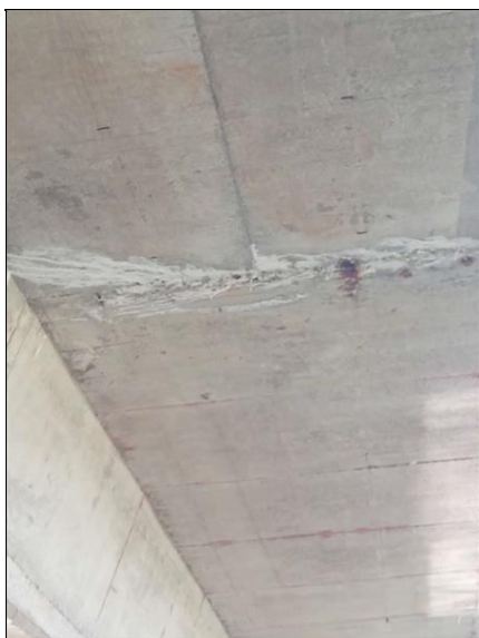
Průsaky v podhledu chodníku.
