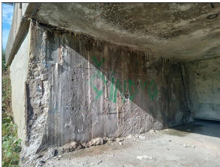
Degradace betonu, průsaky a výluhy na závěrné zídce !
