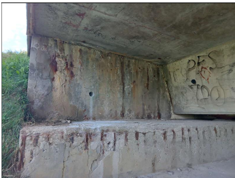
Poškozená závěrná zídka a úložný práh.
