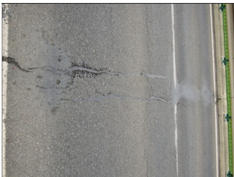
dtto - porucha v místě dilatační spáry nad pilířem
