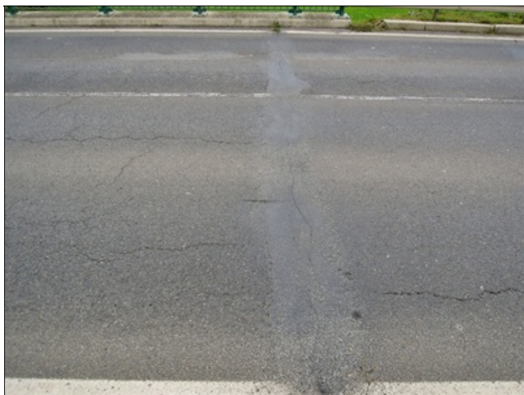
poruchy - trhliny - ve vozovce v ploše i příčná v místě dilatační spáry nad opěrou O8 - vyspravovaná, znovu se tvoří
