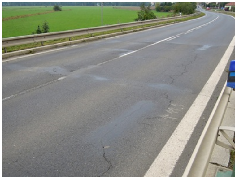
poruchy ve vozovce na přechodové oblasti za opěrou 8
