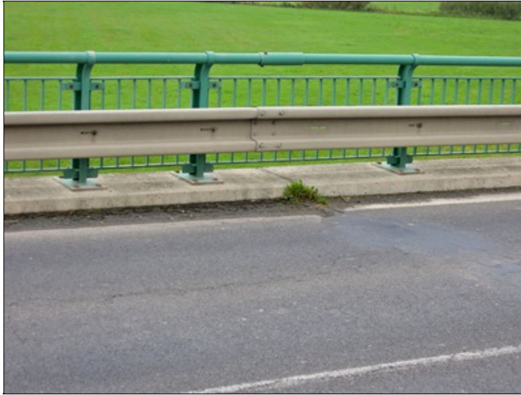
bezodtokové místo u levého obrubníku nad pilířem P4 v místě dilatační spáry
