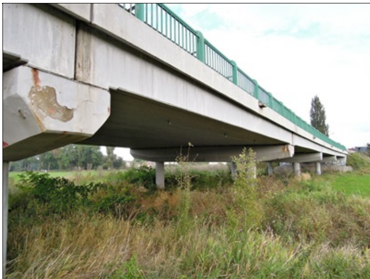
levá strana mostu, v popředí P5, ve 4.poli patrné trubičky odvodnění izolace na spodním líci konstrukce
