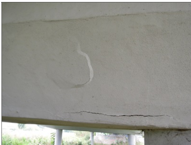
typická lokální porucha sanace a krycí vrstvy v místě korodující výztuže
