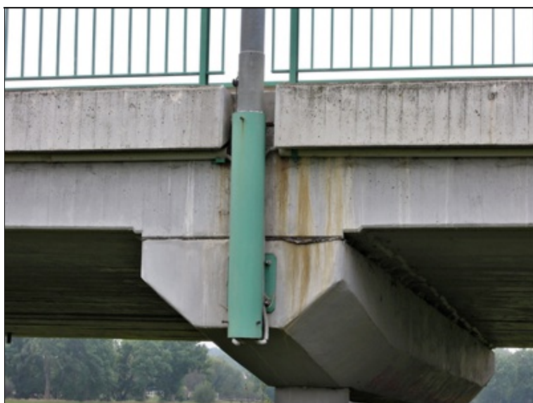
slabé zatékání na pravý bok konstrukce a pilíře pod římsou v místě vybrání pro sloup VO
