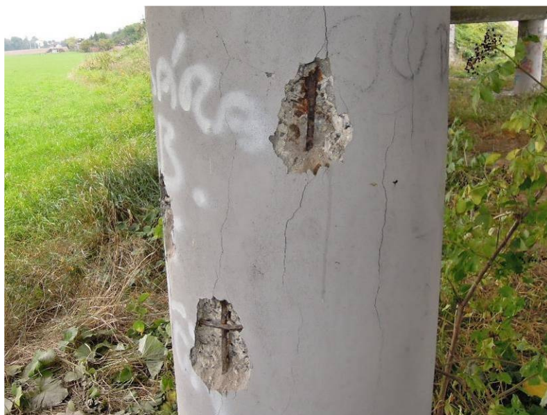
dtto - po odstranění krycí vrstvy v místech trhlin zastižena svislá betonářská výztuž - silná povrchová koroze - lokální oslabení do 10 % plochy
