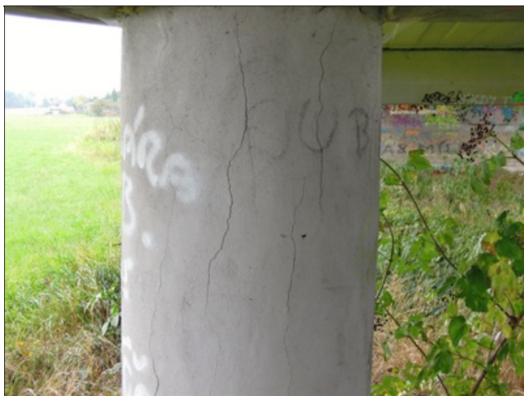
typické svislé trhliny na sloupu pilíře v místech korodující výztuže
