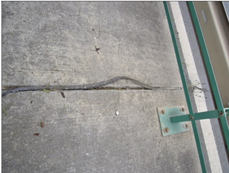
již nefunkční těsnění spar v chodníku
