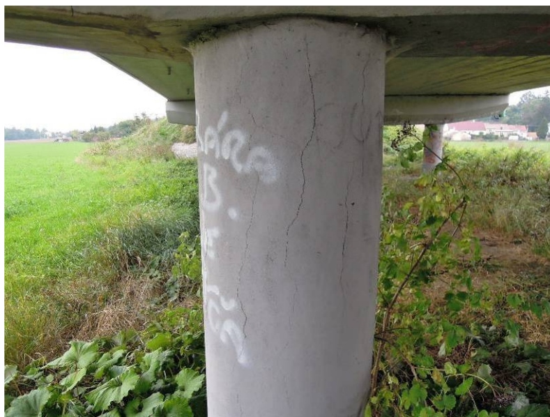
OV1 - typ a) - P6, levý sloup - výrazné svislé trhliny
