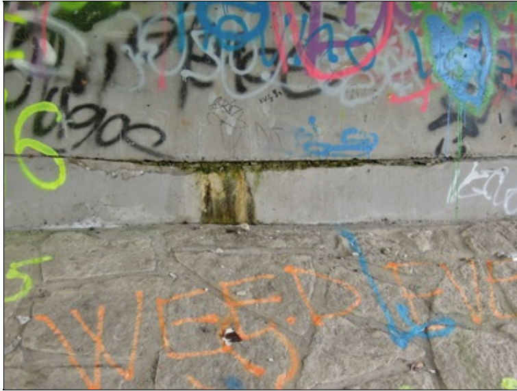
lokální průsak ve střední části opěry OP8 z horizontální spáry
