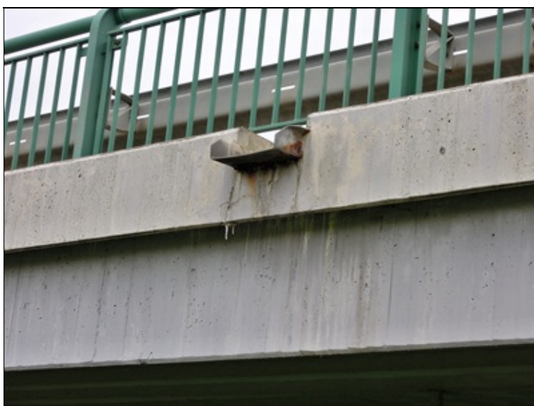
dtto, detail chrliče, průsaky kolem chrliče, trhliny v římse s výluhy - nejhorší stav, ostatní chrliče menší průsak i poruchy v římse
