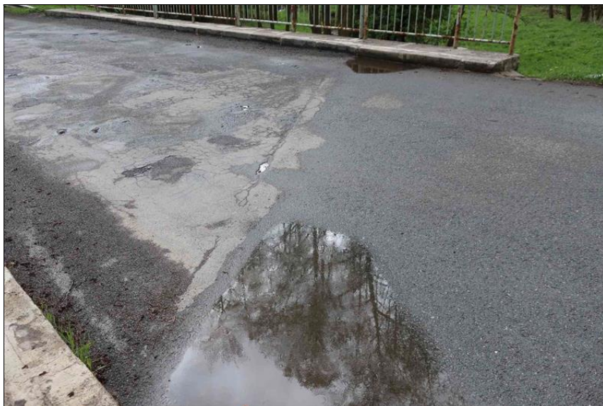
na předmostí jsou podél říms na vozovce kaluže
