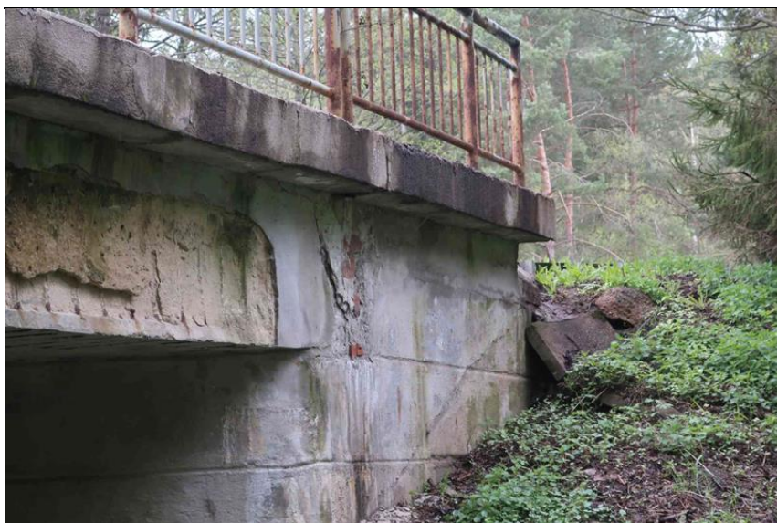
DTTO - rozpad dobetonávky čela 8. nsoníku
