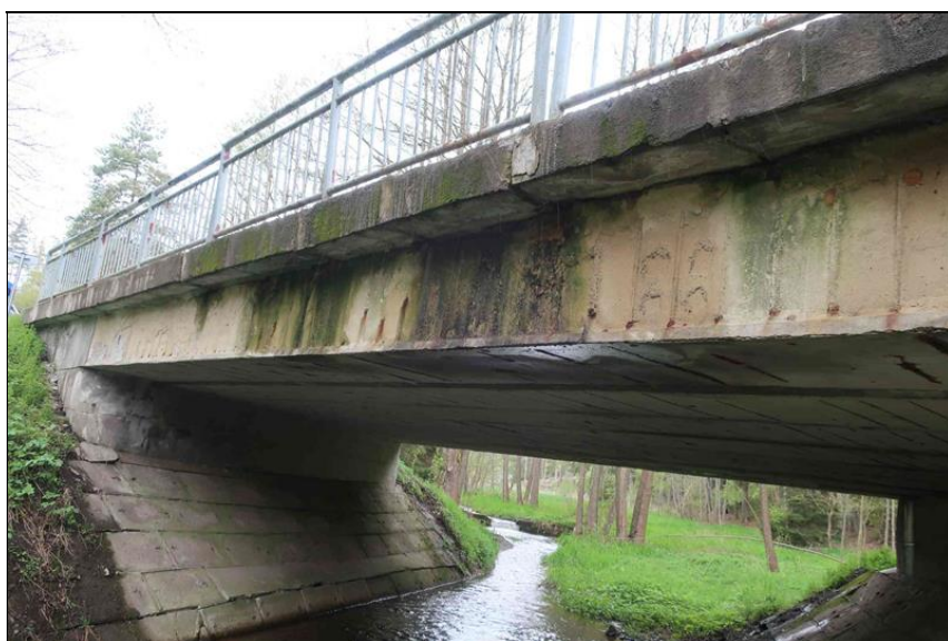
průsaky na vnějším boku 1. nosníku
