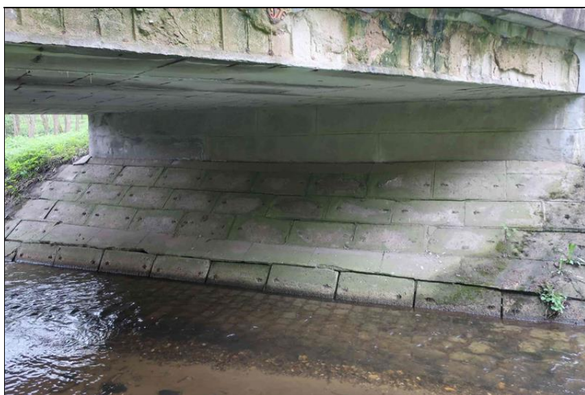
poruchy spárování zpevnění koryta/svahu pod opěrou
