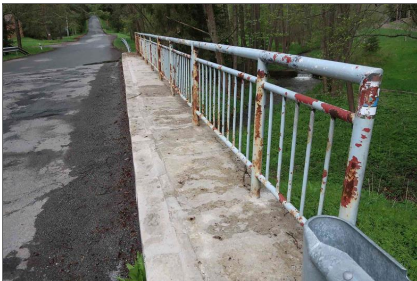
koroze sloupků zábradlí
