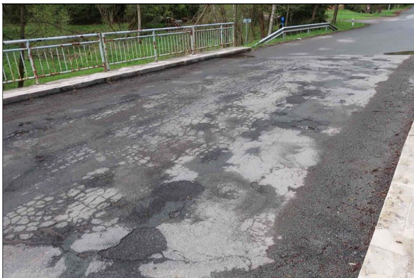
rozpad krytu vozovky
