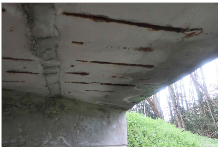
koroze konstrukční výztuže na spodním líci 1. nosníku u O1
