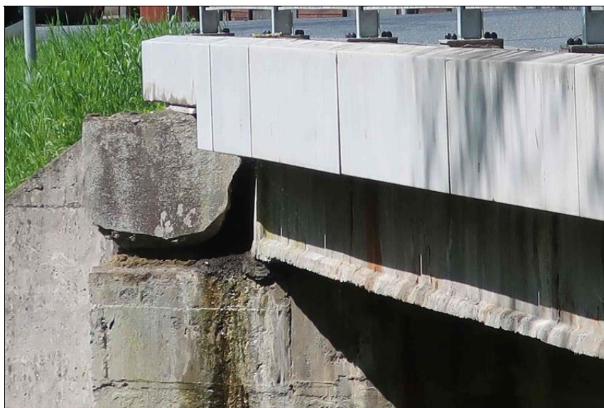
uvolněný betonový blok vně levého bloku 1. nosníku na O3, blok hrozí zřícením degradace betonu úložného prahu v oblastech průsaků
