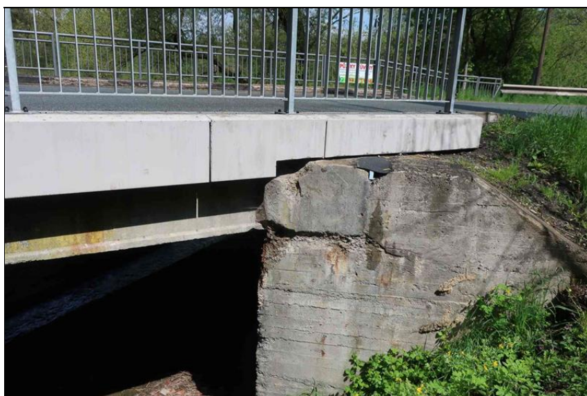
částečně uvolněný betonový blok vně vnějšího bloku 10. nosníku na O3 degradace betonu úložného prahu v oblastech průsaků
