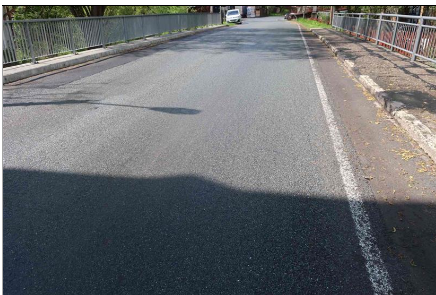
deformace krytu vozovky
