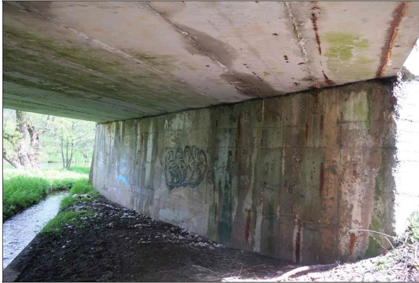
pohled na líc opěry 1 intenzivní průsaky
