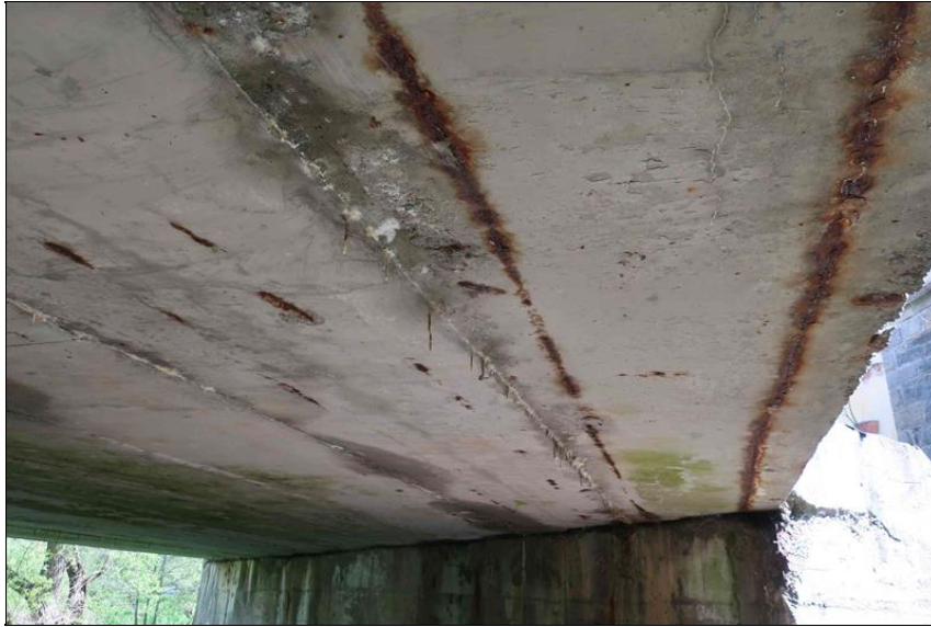
intenzivní průsaky sparami mezi nosníky
