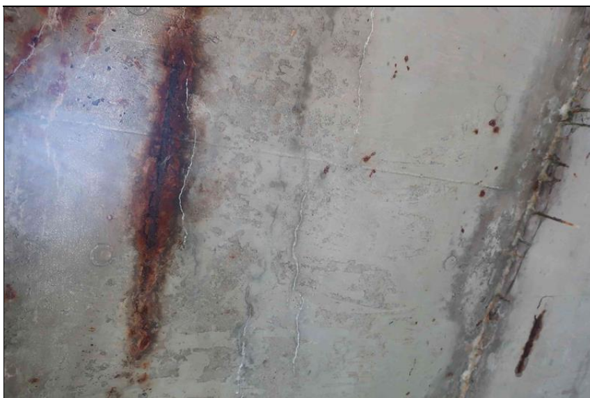
korodující konstrukční výztuž na spodním lici nosníku podélné trhliny na spodním lici nosníku jsou typické pro zaplnění dutiny nosníku zateklou vodou
