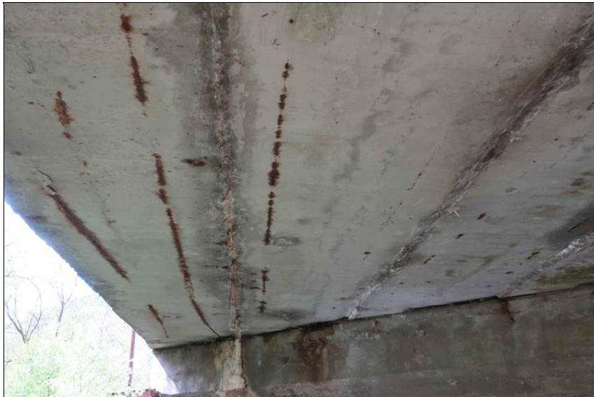
intenzivní průsak s výluhy pojiva sparou mezi nosníky podélné trhliny na spodním líci nosníků kopírující trajektorii předpínací výztuže
