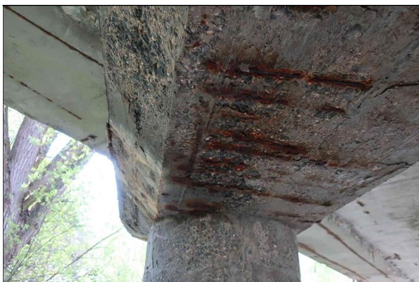
intenzivní koroze výztuže na spodním líci stativa P2 v oblasti nejvýraznějších průsaků
