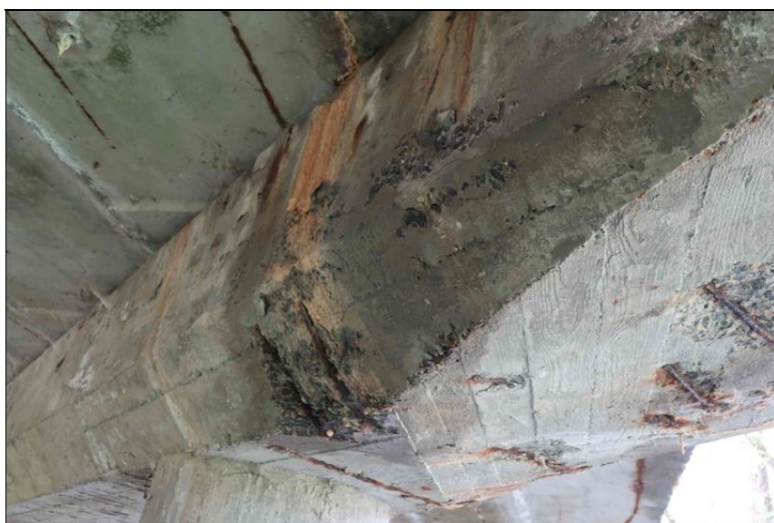
degradace betonu a intenzivní koroze obnažené betonářské výztuže na líci stativa P2
