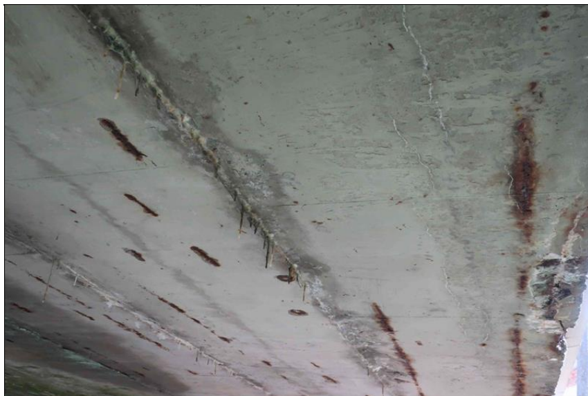
podélné trhliny s výluhy pojiva na spodním líci nosníků kopírují trajektorii předpínací výztuže stopy po průsacích s výluhy pojiva na spodním líci spar mezi nosníky
