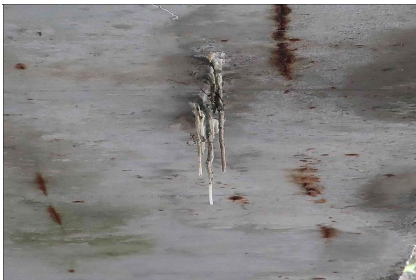
typický jev stopy po intenzivních průsacích trhlinou, která kopíruje trajektorii předpínací výztuže
