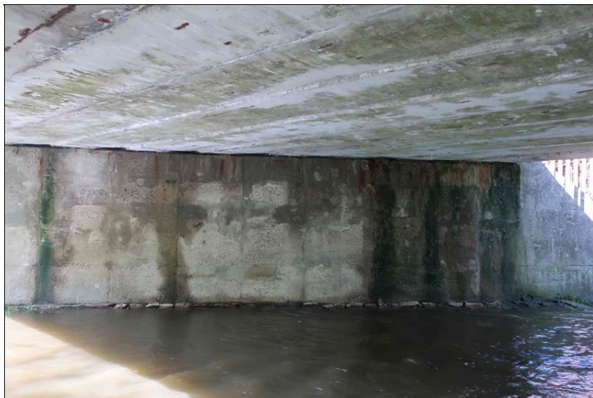
intenzivní koroze betonářské výztuže úložného prahu v oblastech průsaků na lici O2
