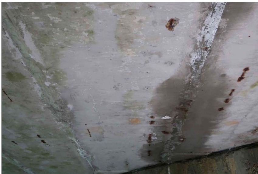
intenzivní průsak sparou mezi nosníky v oblasti uložení na O3
