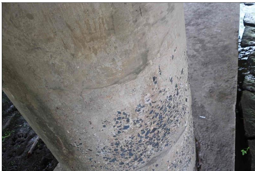
hloubková degradace betonu na líci stojky P2
