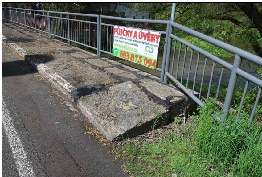
deformace krytu pravého chodníku nad O1
