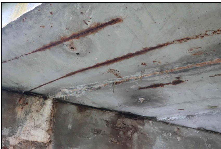
výrazné průsaky z dutin nosníků výrazné průsaky s výluhy pojiva na líci stativa P2 intenzivní koroze betonářské výztuže nosníků
