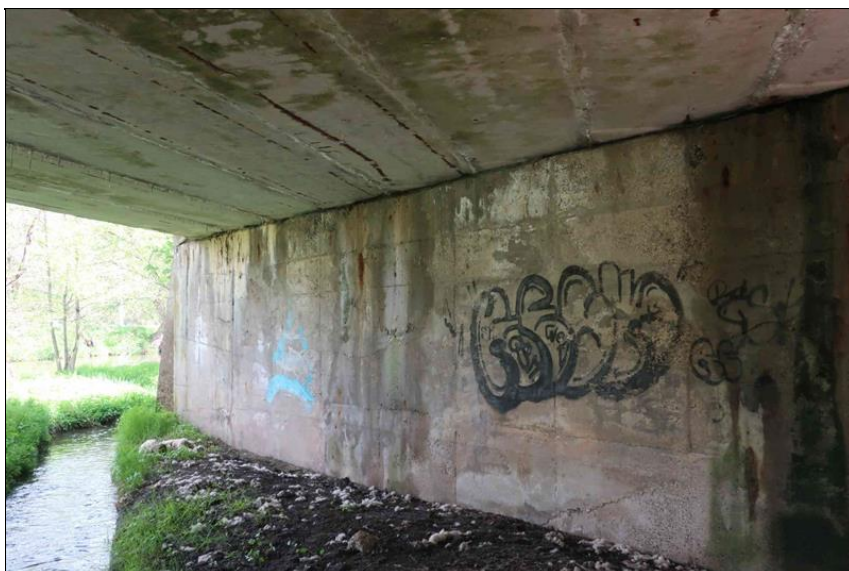
výrazné průsaky na lici O3
