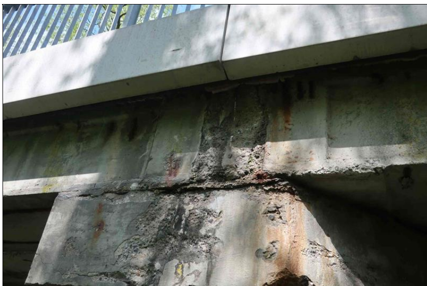
uložení 1. nosníků na levou konzolu stativa P2 hloubková degradace betonu dobetonávky mezi nosníky koroze obnažených částí kotev předpínací výztuže
