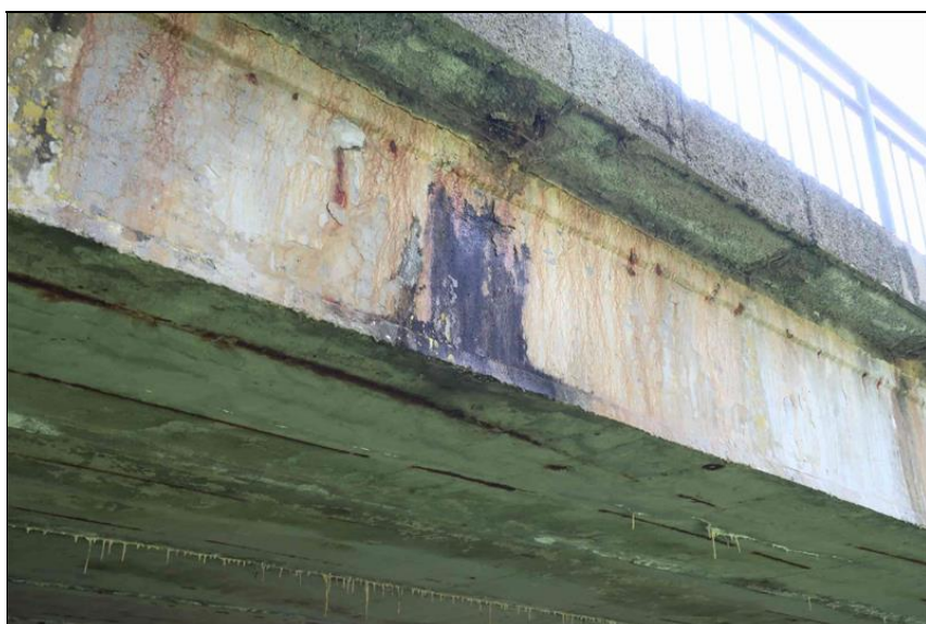
výrazné průsaky se stopami koroze na vnějším boku 10. nosníku v 1. poli
