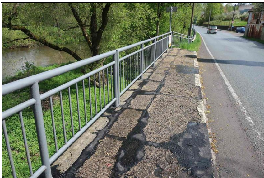
hloubková degradace krytu pravého chodníku
