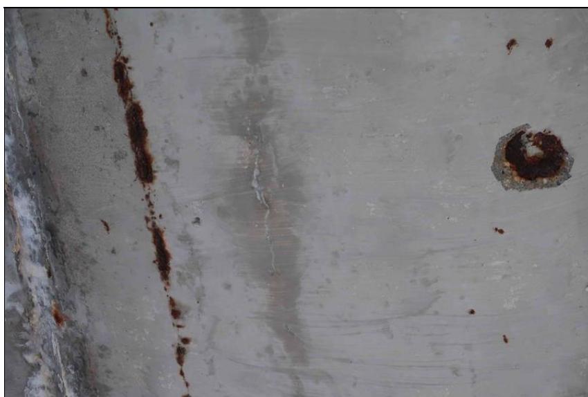
podélná zavhlá trhlina na spodním líci nosníku kopíruje trajektorii předpínací výztuže
