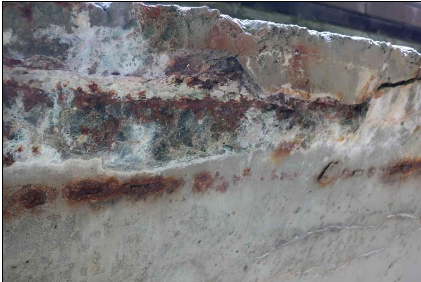
stopy po silných průsacích do nosníku odražená krycí vrstva nad korodující výztuží nosníku došlo k obnažení předpínací výztuže
