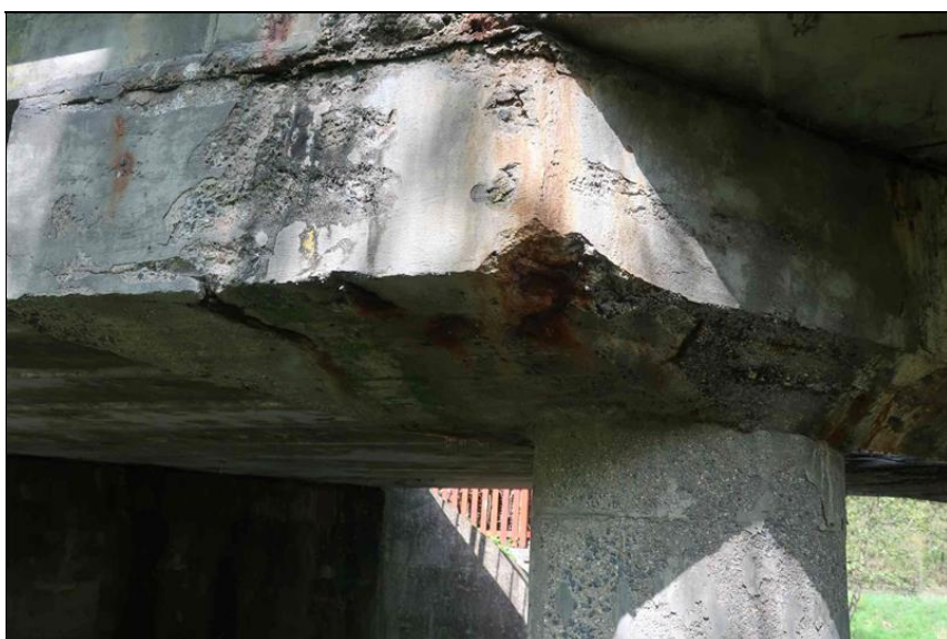
degradace betonu a intenzivní koroze dotčené výztuže v oblastech průsaků na bocích a spodním líci stativa P2
