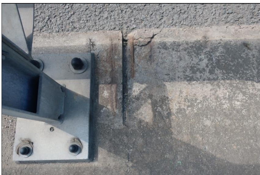
ojediněle obnažená výztuž římsy
