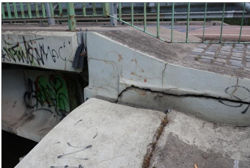
stopy po sedání přechodové oblasti před O1
