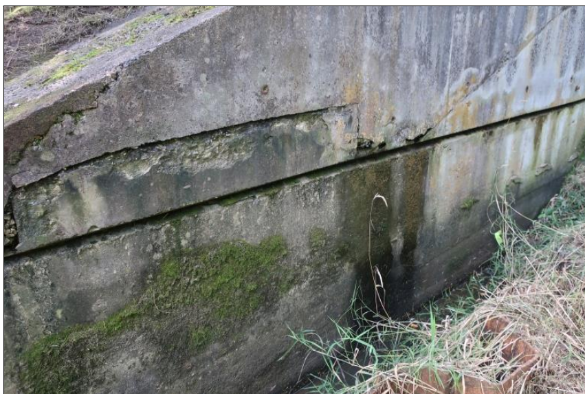
průsaky pracovními sparami pravého křídla O1
