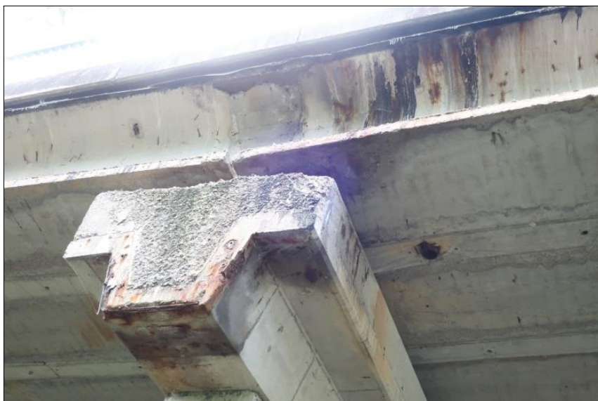
pohled na pravé čelo P2 v oblastech průsaků
