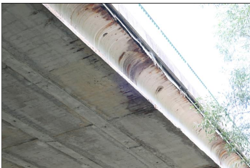
intenzivní koroze konstrukční výztuže na vnějším boku a spodním líci 9. nosníku ve 2. poli
