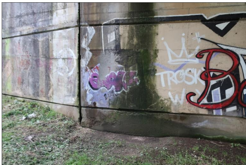
intenzivní průsaky na lici O1 jsou v poloze mezi 8. a 9. nosníkem, resp. vně 1 nosníku
