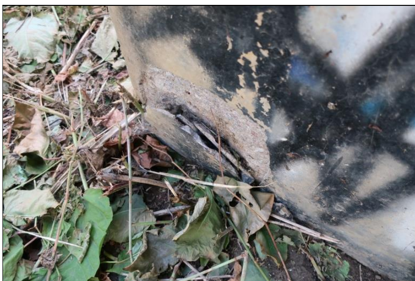
DTTO - v místě stékající vody dochází k separaci krycí vrstvy nad korodující výztuží
