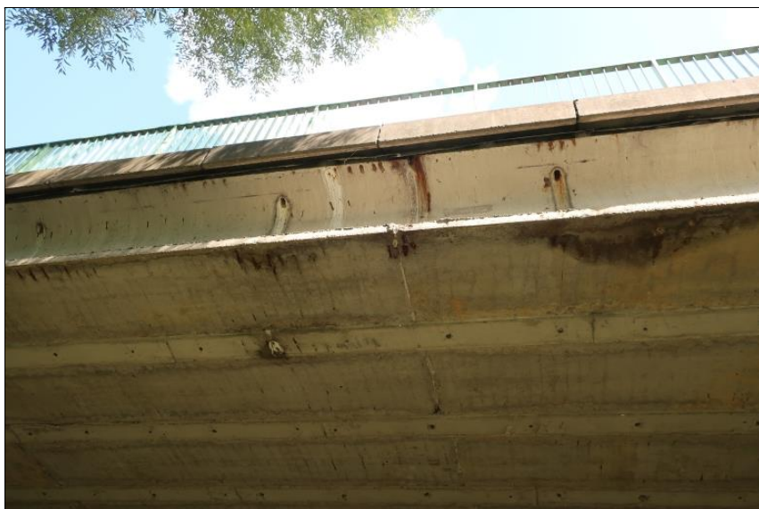
1. nosník v 1. poli koroze konstrukční výztuže v oblastech průsaků
