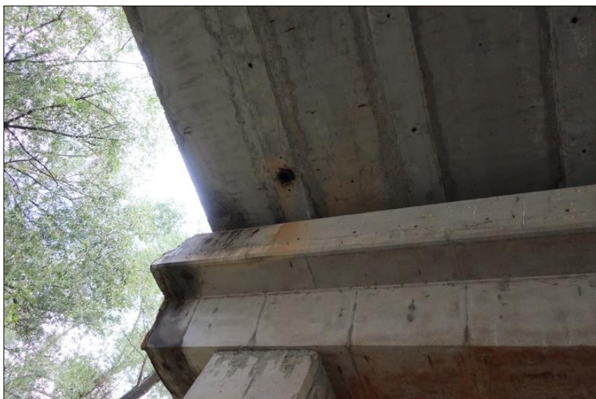
průsak na boku stativa P2 nulový přesah svodu odvodňovače
