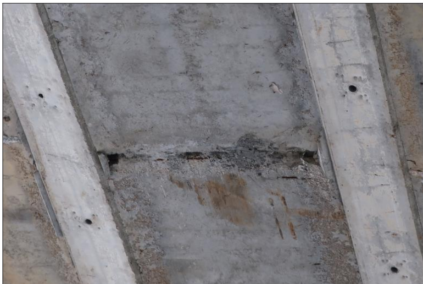
drobné poruchy výplně spáry mezi korálky
