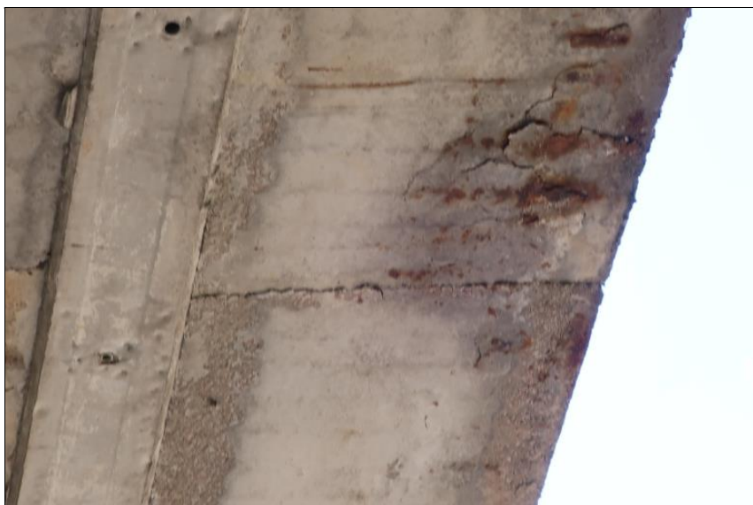
separace krycí vrstvy nad korodující výztuží
