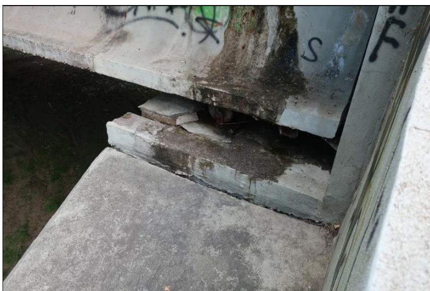
odražená krycí vrstva ÚP O1 před ložiskem 1. nosníku v oblastech průsaků
