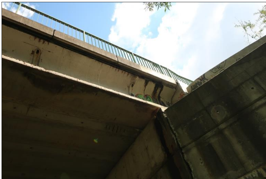
průsak vně 1. nosníku
