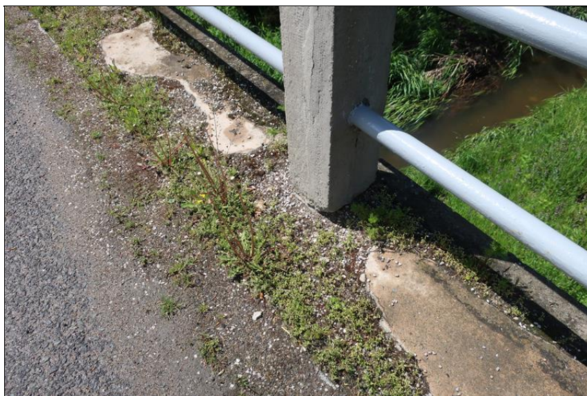
hloubková degradace betonu římsy
