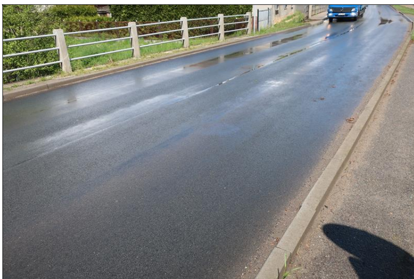
deformace krytu vozovky (vyjeté koleje)
