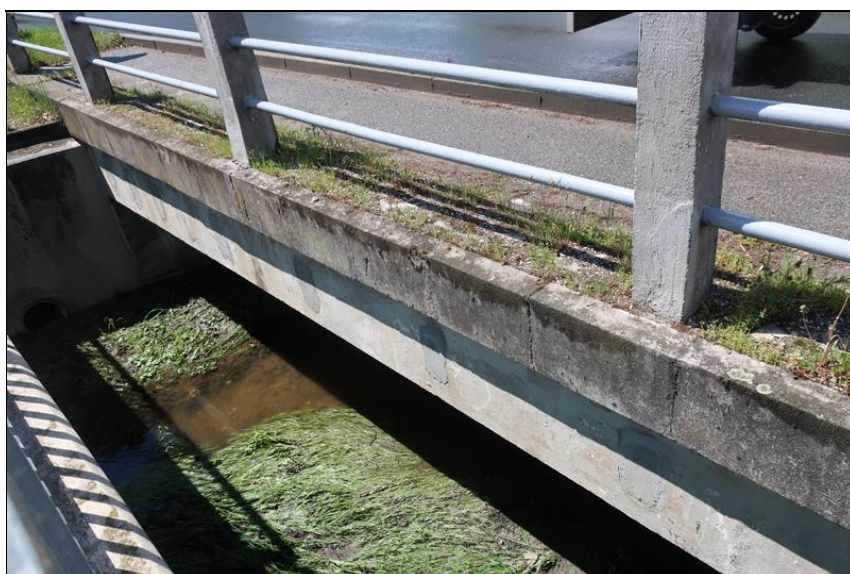
beton je na horním líci pravé římsy hloubkově degradován
