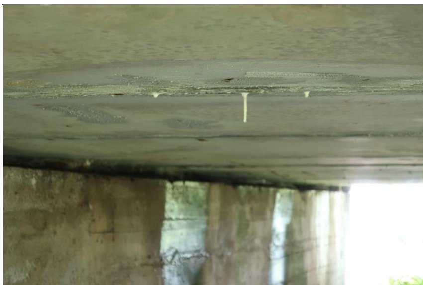
detail průsaku s výluhem pojiva sparou mezi nosníky
