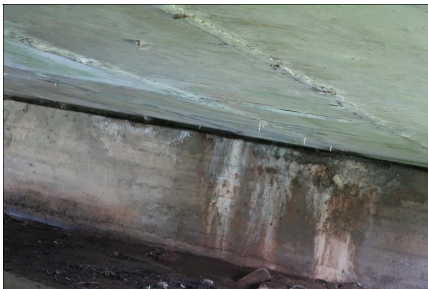
průsaky sparou mezi nosníky u O1
