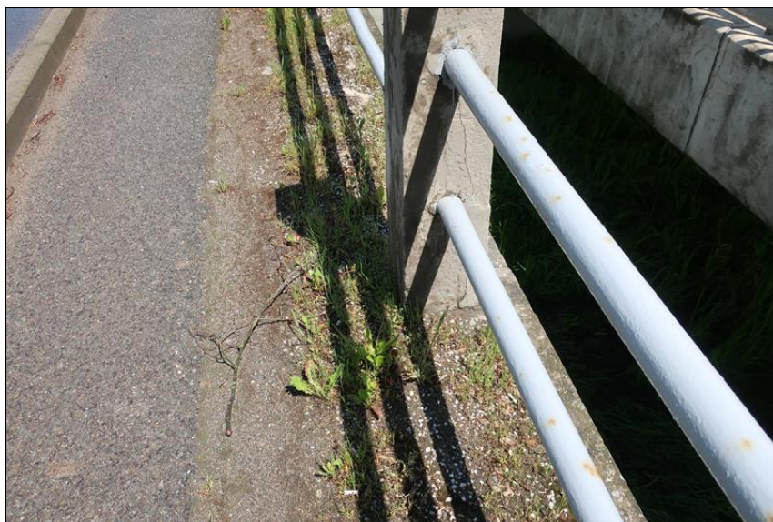
vegetace uchycená v oblasti kotvení sloupků zábradlí
