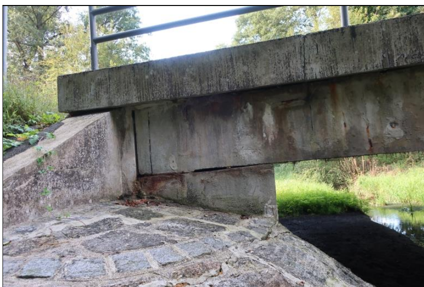
uložení NK na opěru stopy koroze
