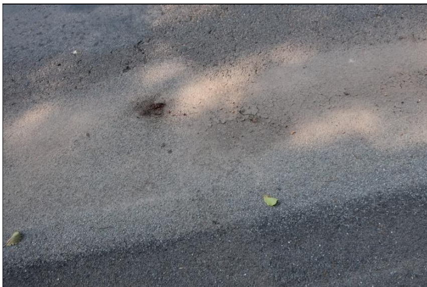
i přes hojně opravy se v krytu chodníku vytváří nové výtluky
