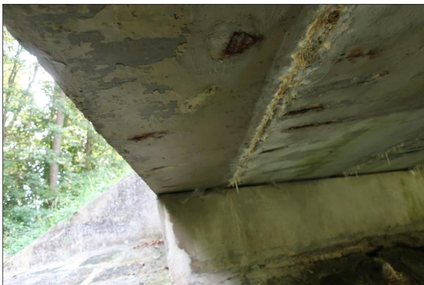
podhled NK stopy po průsacích s výluhy pojiva v místě spáry mezi nosníky
