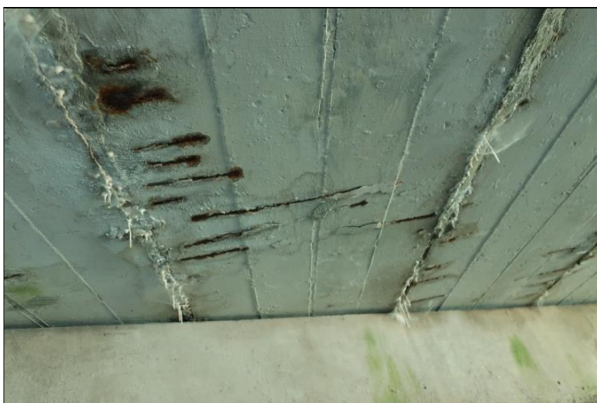
koroze betonářské výztuže na spodním líci nosníku
