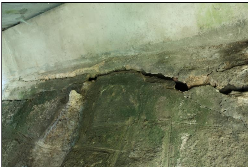
trhlina ve zpevnění svahového kužele pod opěrou
