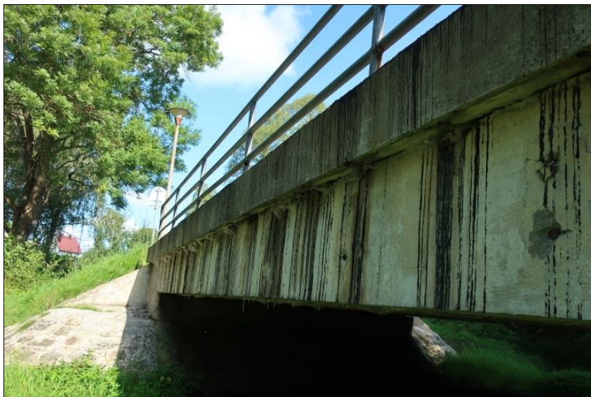
poruchy dobetonávek kotev příčného sepnutí na vnějším boku krajního nosníku
