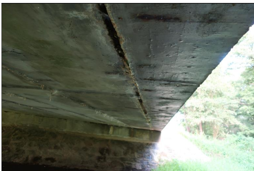
DTTO - v oblastech intenzivních průsaků dochází k vyplavení betonu spáry
