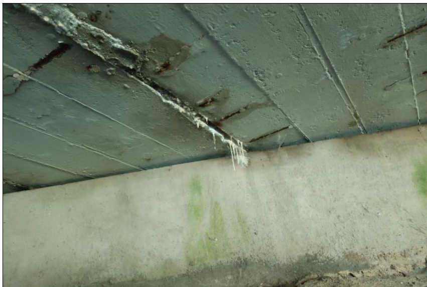
dutiny nosníků nejsou odvodněny
