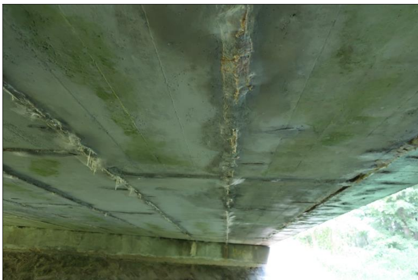
podhled NK s prosakujícími sparami mezi nosníky
