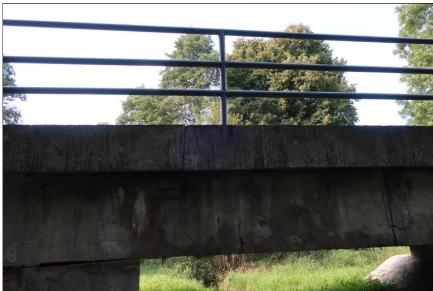
stopy po průsacích na vnějším boku krajního nosníku
