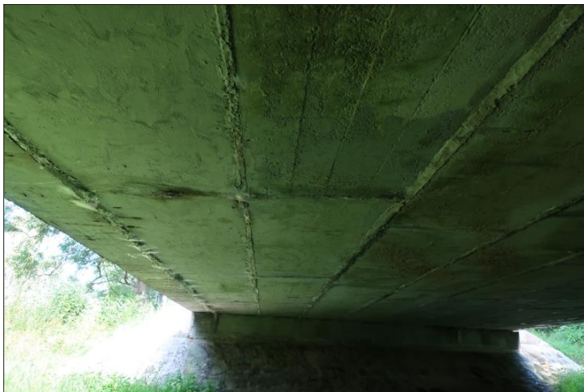
stopy po průsacích se stopami koroze v místě příčné spáry mezi dílci nosníku
