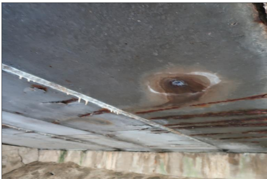
otvor odvodňující dutinu 8. nosníku před O3 intenzivní průsak k výrazným koroziivním zabarvením
