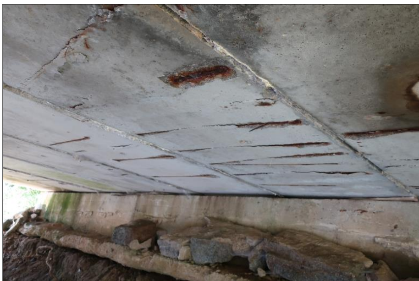
ÚP O1, pohled zleva koroze konstrukční výztuže nosníků v oblastech nedostatečné tloušťky krycí vrstvy
