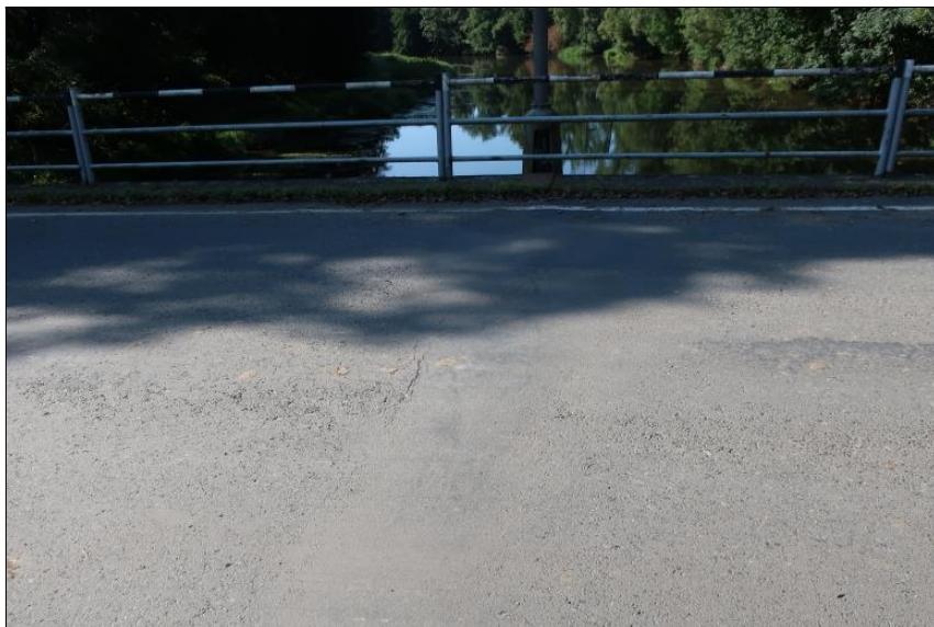
příčná trhlina v krytu vozovky nad P2
