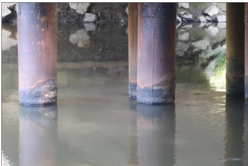
koroze stojek pilíře 2 v oblasti kolísání hladiny řeky
