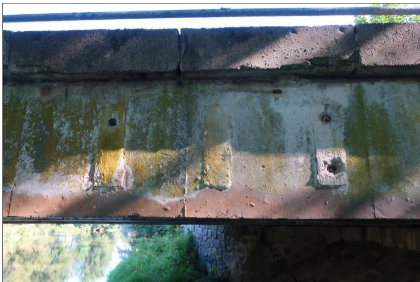
nad kotvami příčného sepnutí dochází k poruchám dobetonávek
