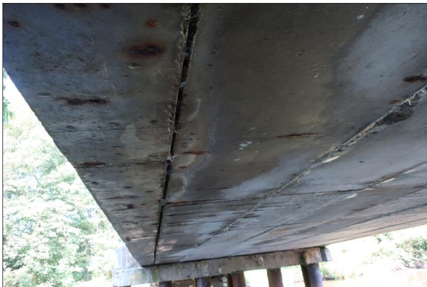
podhled NK ve 2. poli od O3 výrazné průsaky na psodním líci nosníků
