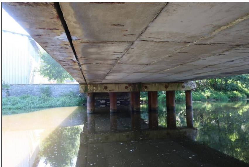
pohled na P2 koroze krytů schránek SZ
