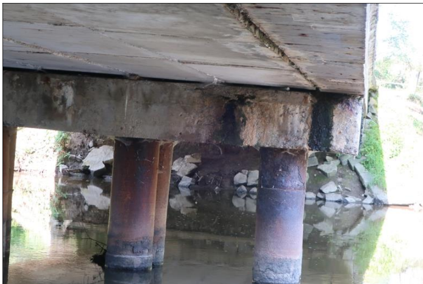
hloubková degradace betonu stativa pilíře P2 vlevo (směrem do 2. pole)
