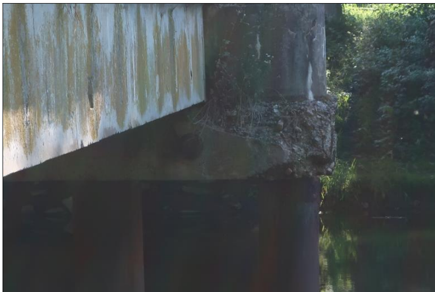
hloubková degradace betonu stativa P2 na pravé straně
