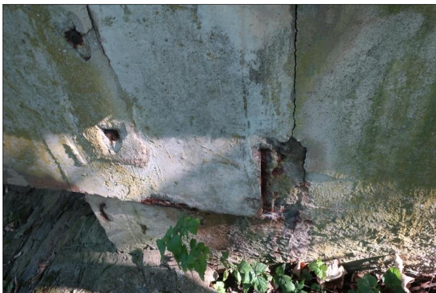
obnažená korodující kotva podélné předpínací výztuže na čele 9. nosníku nad O3
