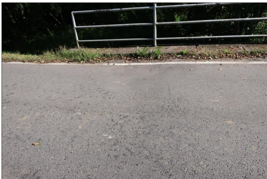
prosedlá přechodová oblast před O1
