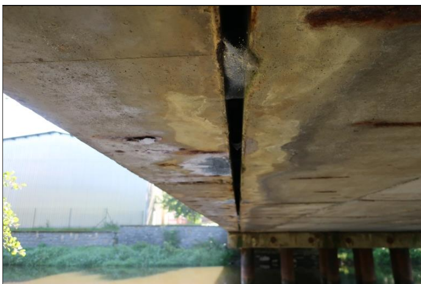
volná spára mezi nosníky v 1. poli stopy po průsacích koroze konstrukční výztuže
