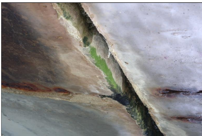
stopy po intenzivních průsacích sparou mezi nosníky stopy po průsacích jsou patné i na spodním lici příčné pracovní spáry mezi dílci daného nosníku
