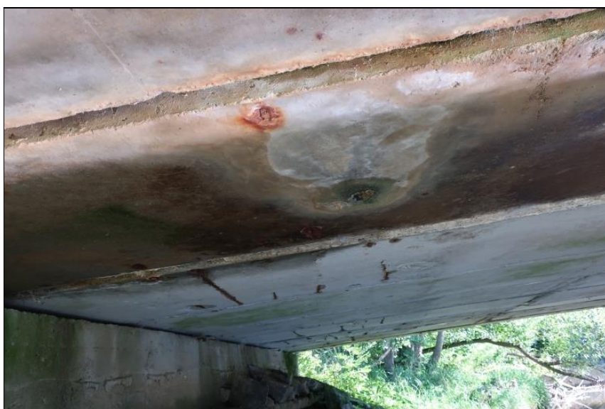
výrazné stopy po průsacích na spodním líci 8. nosníku u O1
