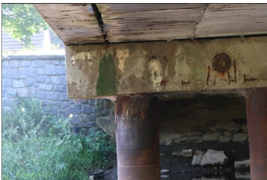
intenzivní koroze levého krajní stojky pilíře P2 v místě vetknutí do stativa koroze obnažené výztuže a degradace betonu stativa pilíře
