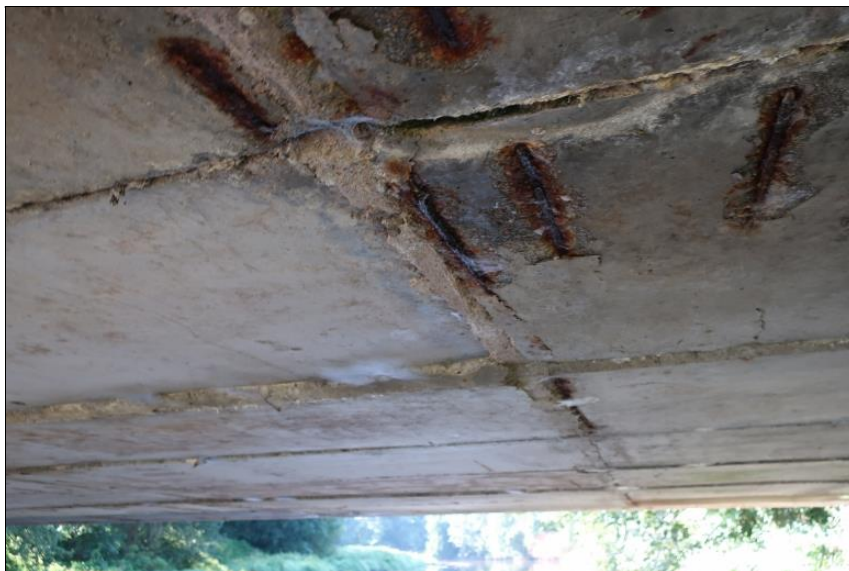
příčná spára mezi dílci jednotlivých nosníků se stopami po průsacích
