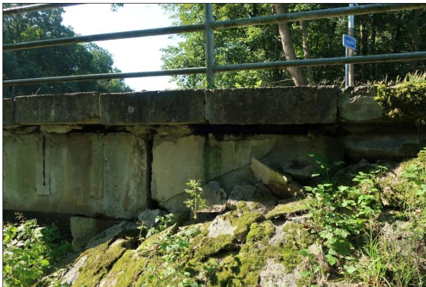
římsové prefabrikáty jsou uvolněné
