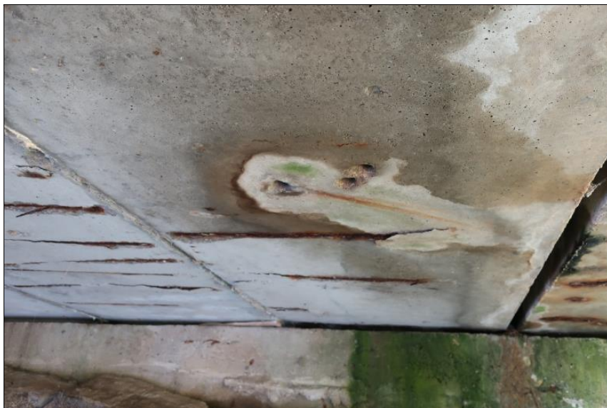
stopy po průsacích z dutiny nosníku stopy po průsacích na líci ÚP O1
