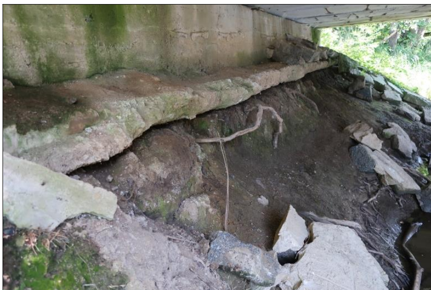
podemletý úložný práh a odplavené zpevnění svahu u O1
