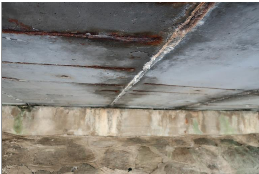
výrazné stopy po průsacích na lici O3
