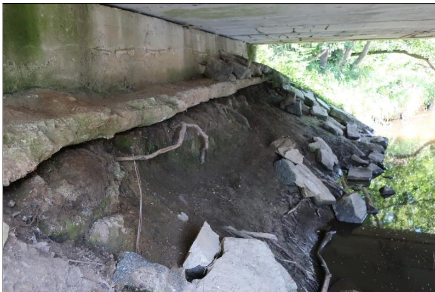
O1 - na líci ÚP jsou výrazné stopy po průsacích
