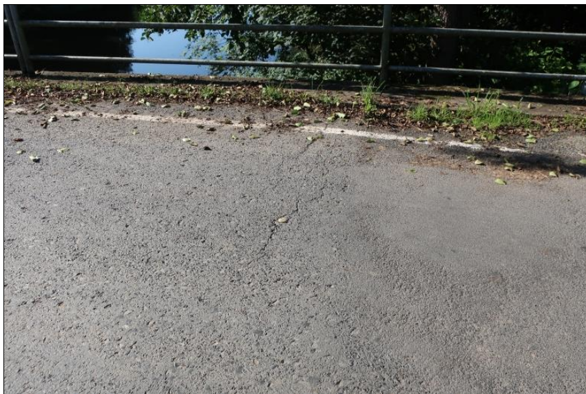
příčná trhлина v krytu vozovky nad O1
