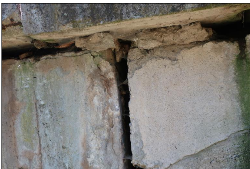
dilatační spára nad O1, pohled zleva římsový prefabrikát je položen přes dilatační spáru
