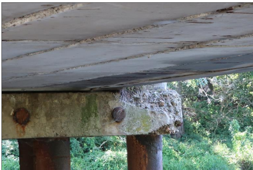
degradovaný beton pravého boku stativa P2
