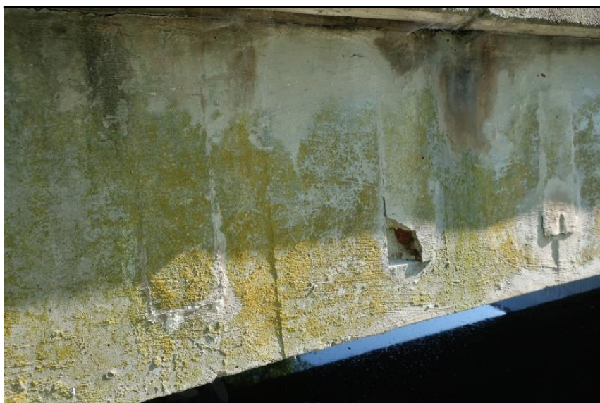
odpadlá dobetonávka korodující kotvy příčného sepnutí
