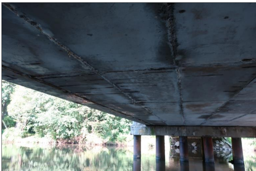
průsaky sparami mezi nosníky i sparami mezi dílci jednotlivých nosníků
