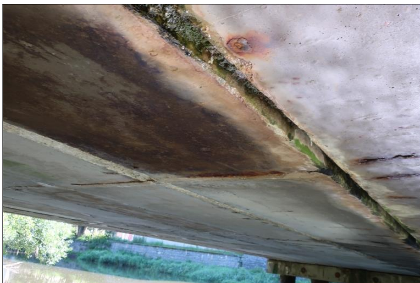
beton výplně spar mezi nosníky hloubkově degraduje, mnohde již chybí
