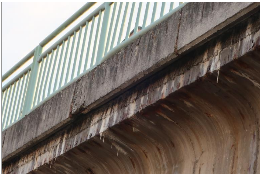
na vnější bok 9. nosníku výrazně zatéká z izolace
