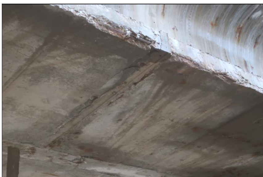
degradace betonu 9. nosníku v hraně dolní pásnice
