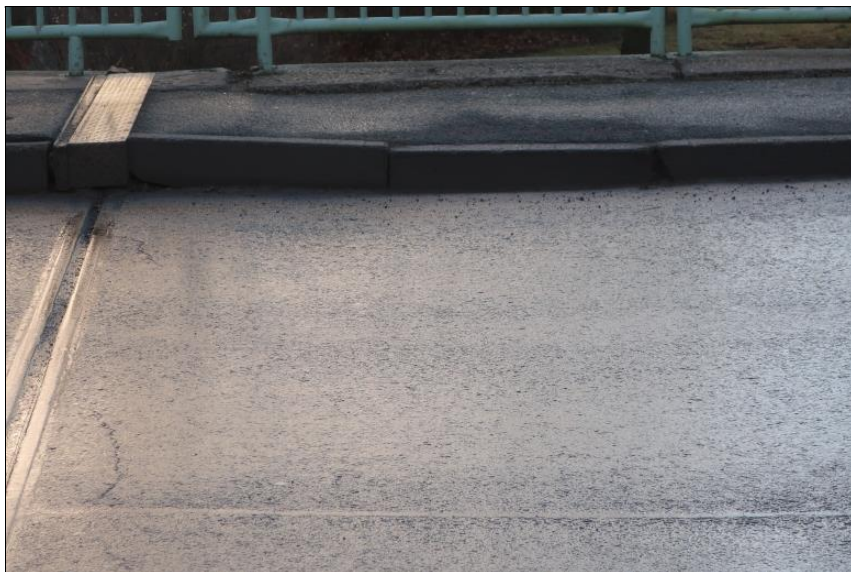
deformace přechodové oblasti za O2
