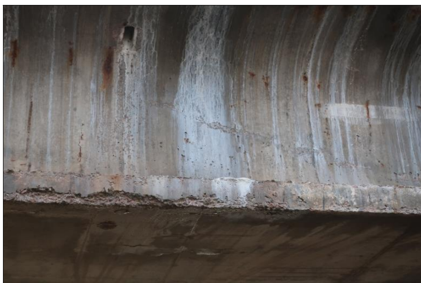
podélná trhlina kopírující trajektorii předpínací výztuže na vnějším boku 9. nosníku
