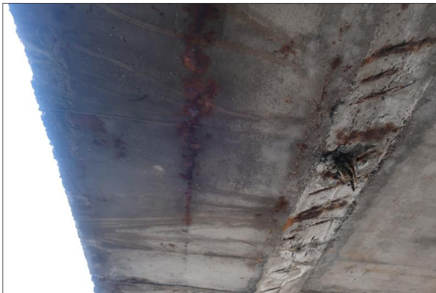
koroze obnažené konstrukční výztuže na spodním líci 9. nosníku
