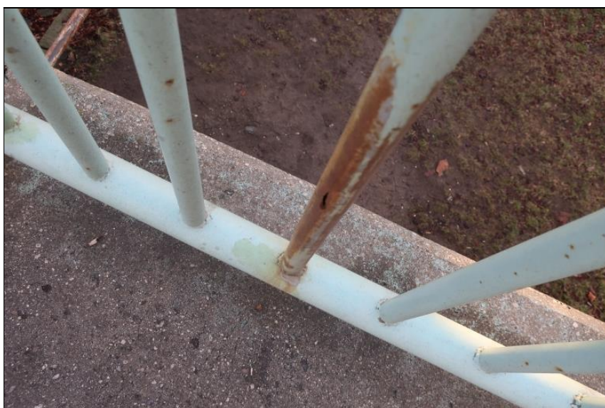
roztržený korodující profil výplně zábradlí
