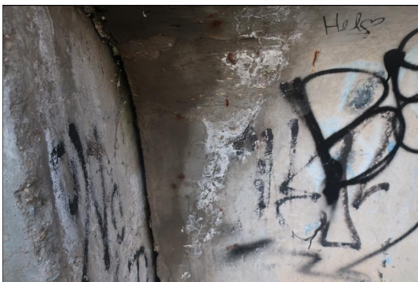
trhlina s výluhem pojiva mezi dobetonákovou a čelem 1. nosníku nad O2
