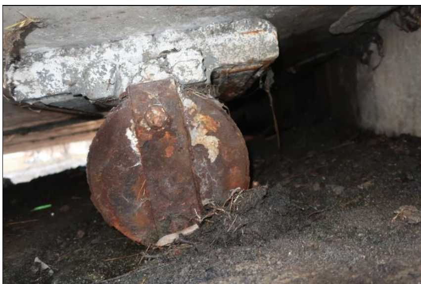
koroze 9. ložiska na O2
