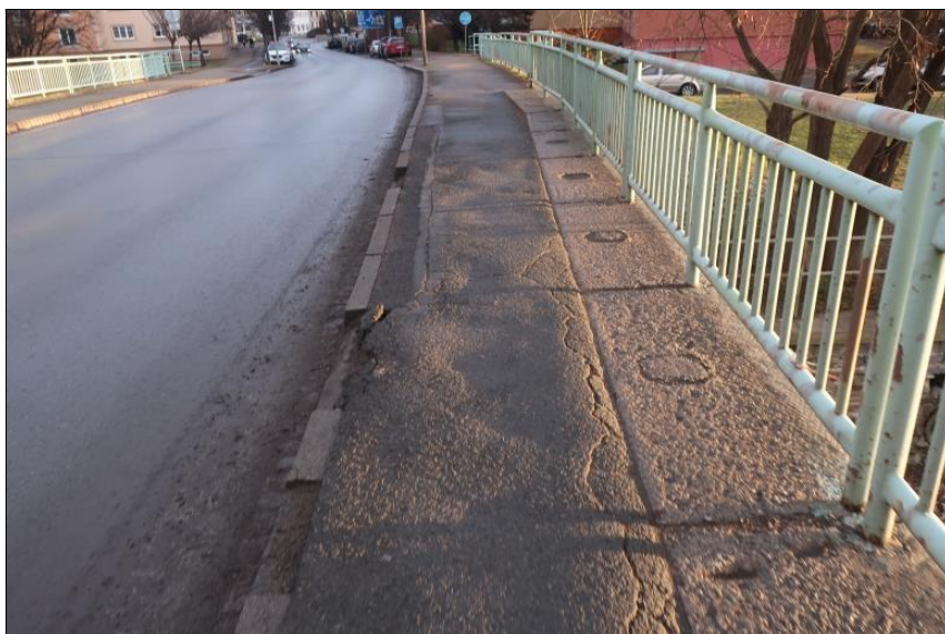
pohled na levý chodník a jeho poruchy
