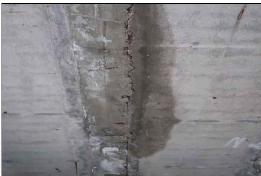
průsak sparou mezi nosníky
