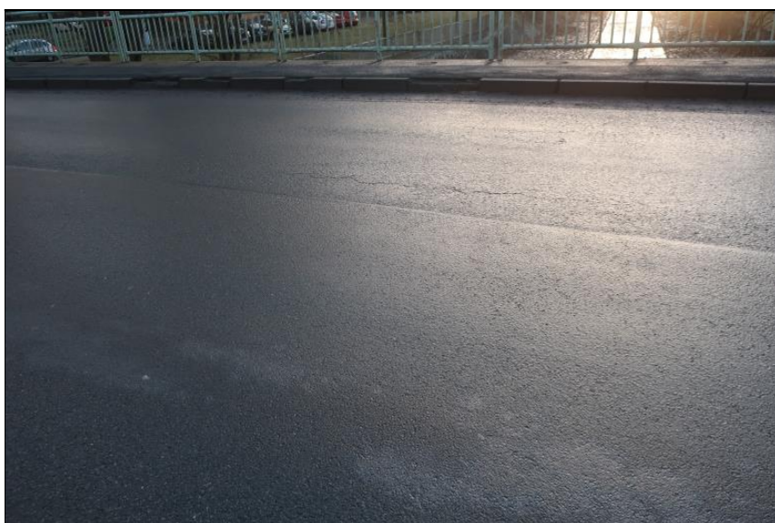
trhlina v krytu vozovky deformace krytu vozovky
