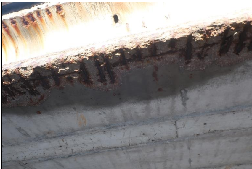
detail degradace betonu a intenzivní koroze konstrukční výztuže u 1. nosníku
