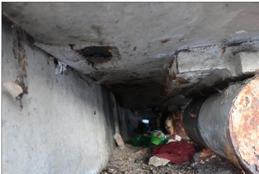
nánosy na ÚP O2 obnažená korodující kotva předpínací výztuže na čele 1. nosníku nad O2
