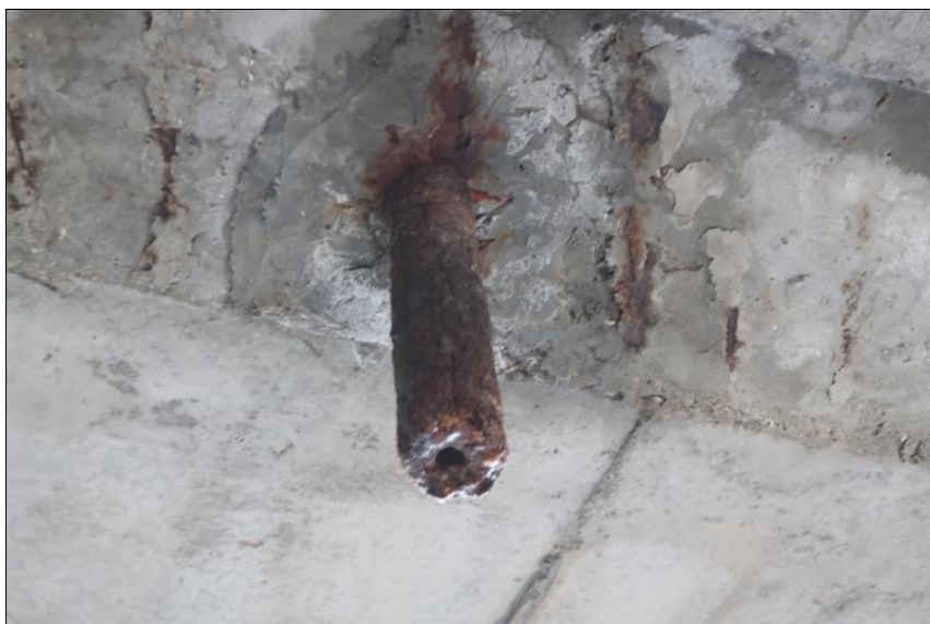
detail zkorodované odvodňovací trubky
