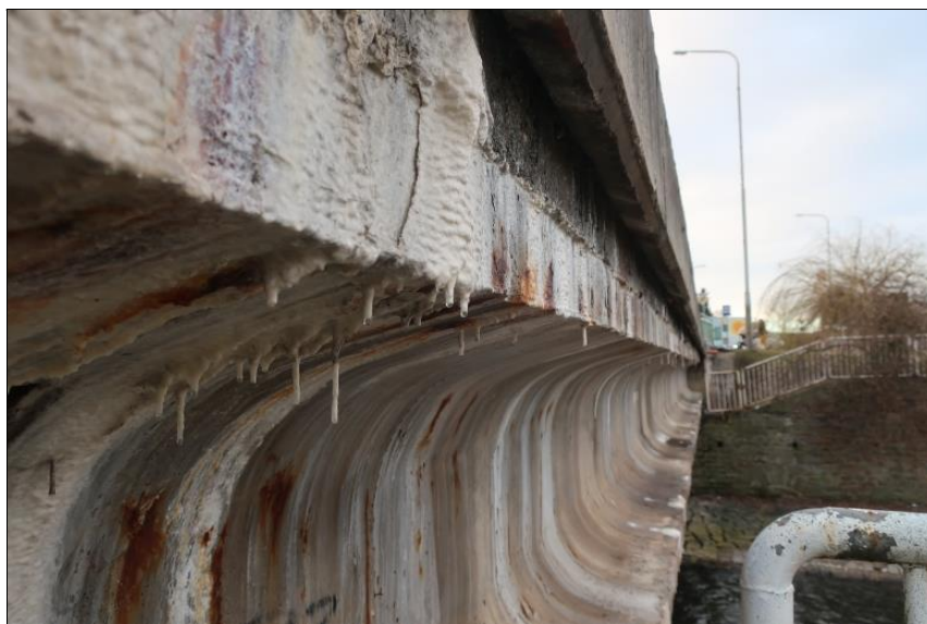
stopy po průsacích s výluhy pojiva z izolace na pravý vnější bok 9. nosníku
