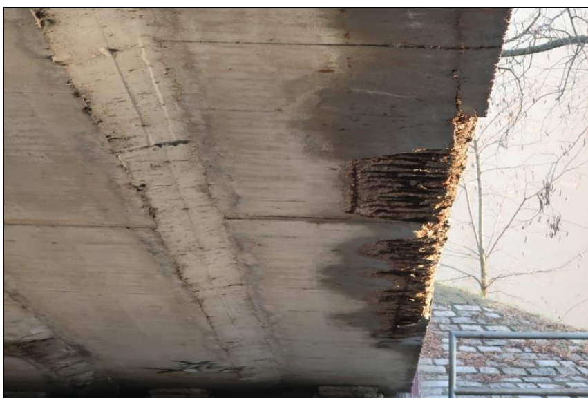
rozpad betonu 1 nosníku za O1 intenzivní koroze obnažené výztuže
