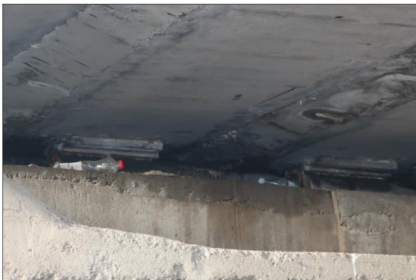
DTTO stopy po průsaku na líc opěry
