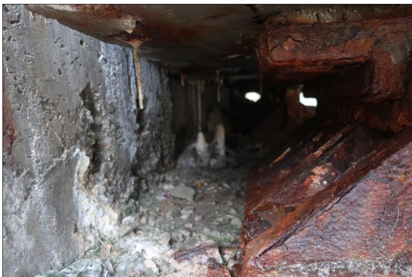
nánosy na ÚP O1 z dobetonávky kapes předpínací výztuže vytéká voda
