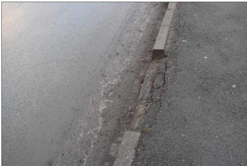
rozpad betonu obruby levého nosníku
