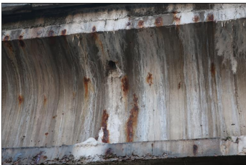
detail poruch na vnějším boku 9. nosníku
