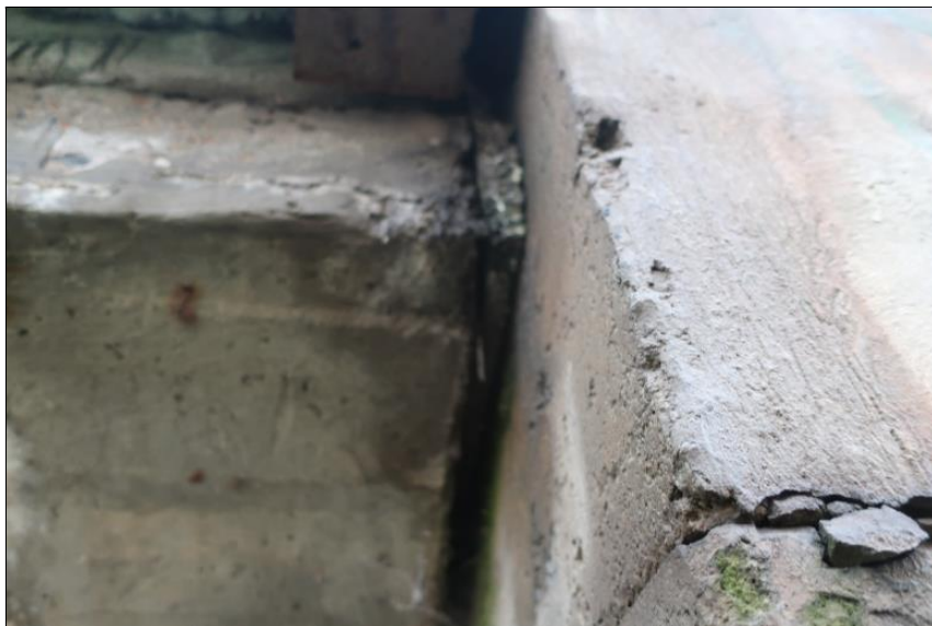
těsná dilatační spára u O2
