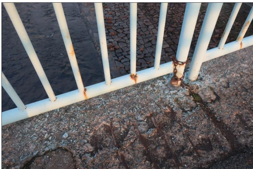
koroze zábradlí obnažená korodující výztuž na horním lící římsového prefabrikátu
