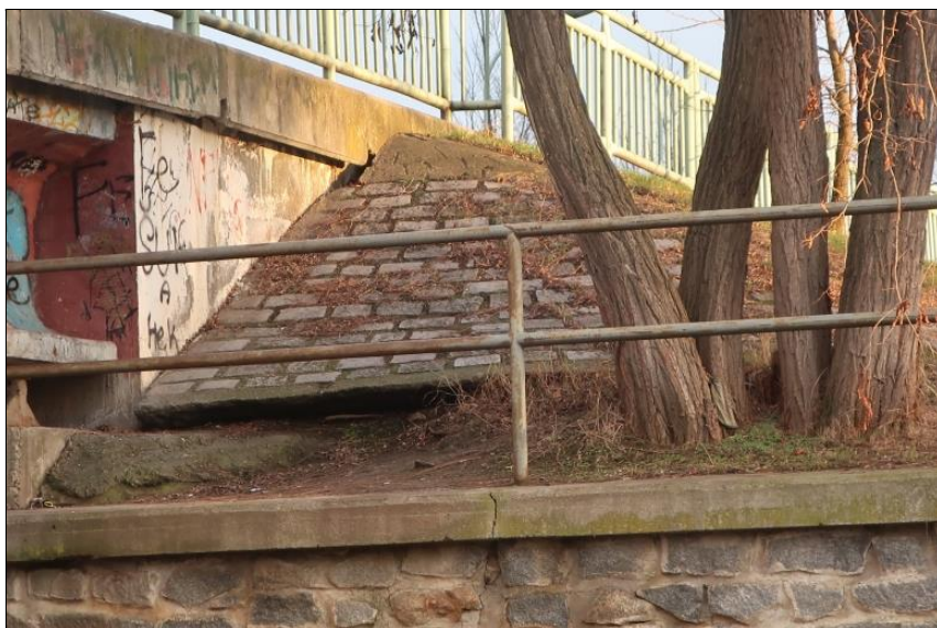
eroze terénu pod zpevnění svahového kužele vlevo u O1
