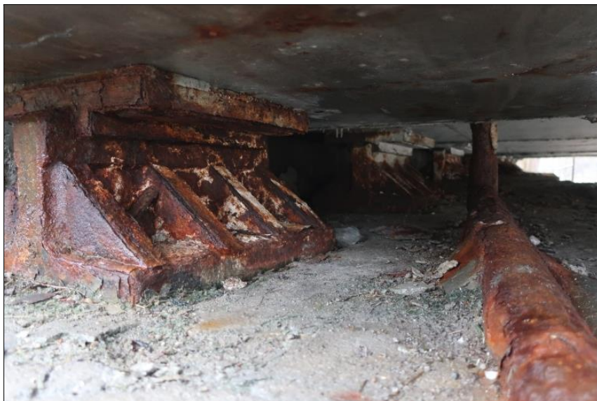
koroze pevných ložisek na O1 pod 8. a 9. nosníkem
