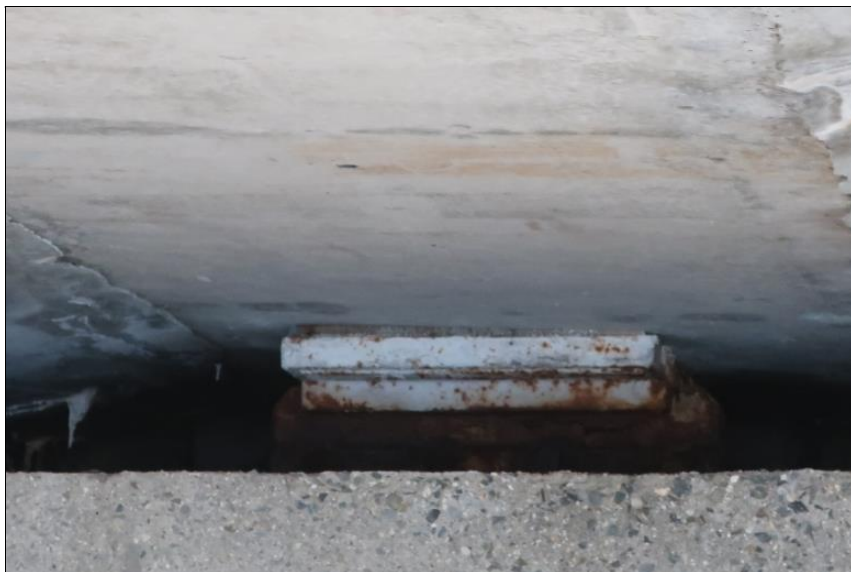
koroze pevného ložiska O1
