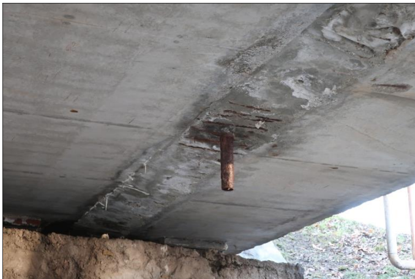
průsak sparou mezi nosníky v okolí trubky odvodnění expanzní vrstvy koroze obnažené výztuže spáry
