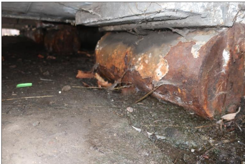
koroze 9. ložiska na O2
