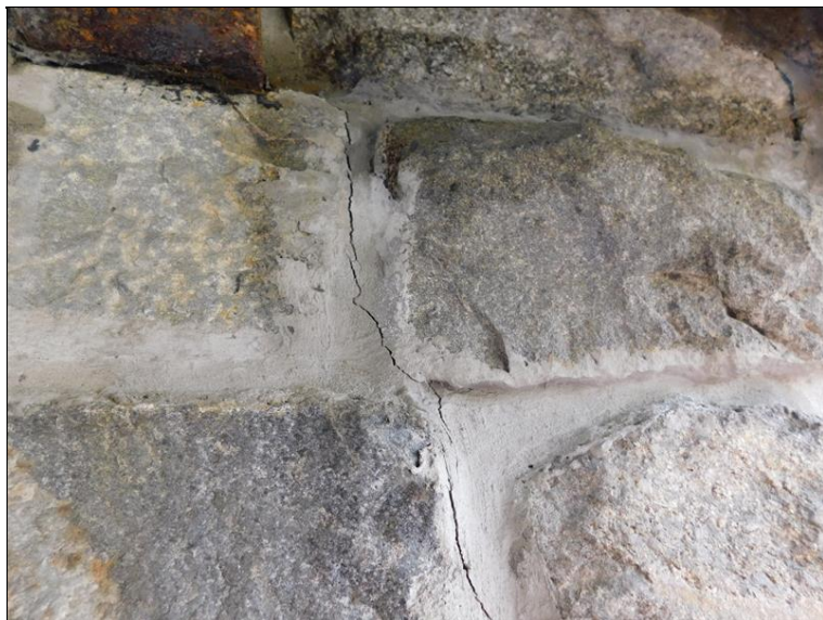
Detail šikmé trhliny v krajní části opěry
