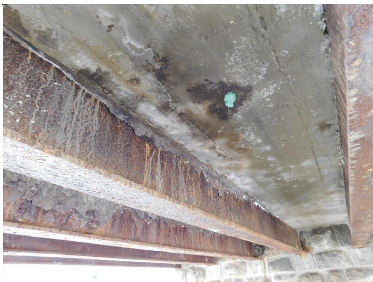
Stav původních částí desky mostovky
