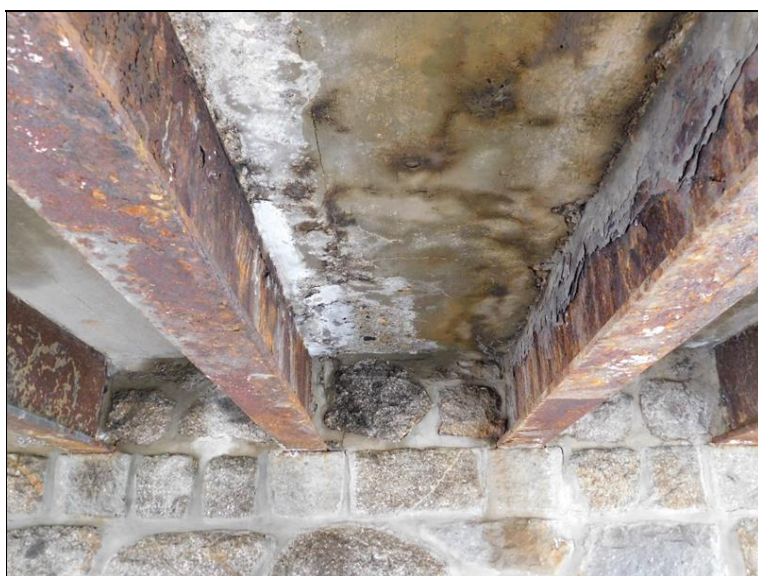
Stav původních částí desky mostovky a koroze podélných ocelových nosníků
