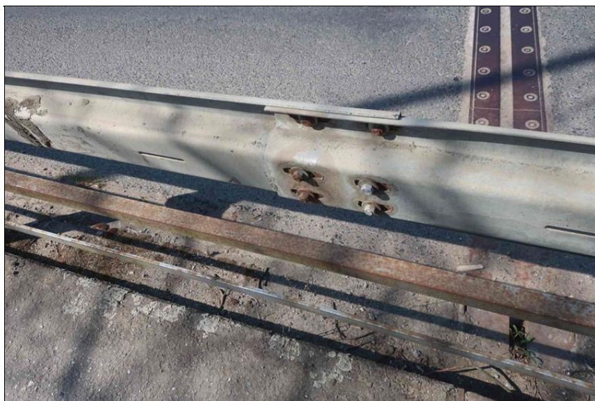
koroze spojovacích prostředků svodnice levého svodidla
