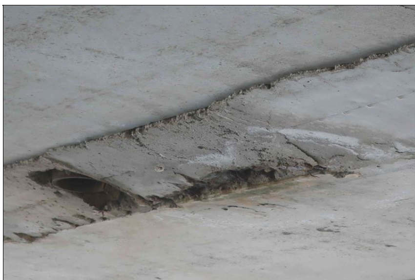
stopy po průsaku mezi 8. a 9. nosníkem v okolí svodu odvodnění v 1. poli nedostatečná délka svislého svodu
