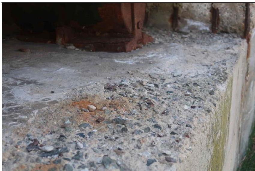
degradace betonu na horním líci ÚP O3 podél pravé hrany
