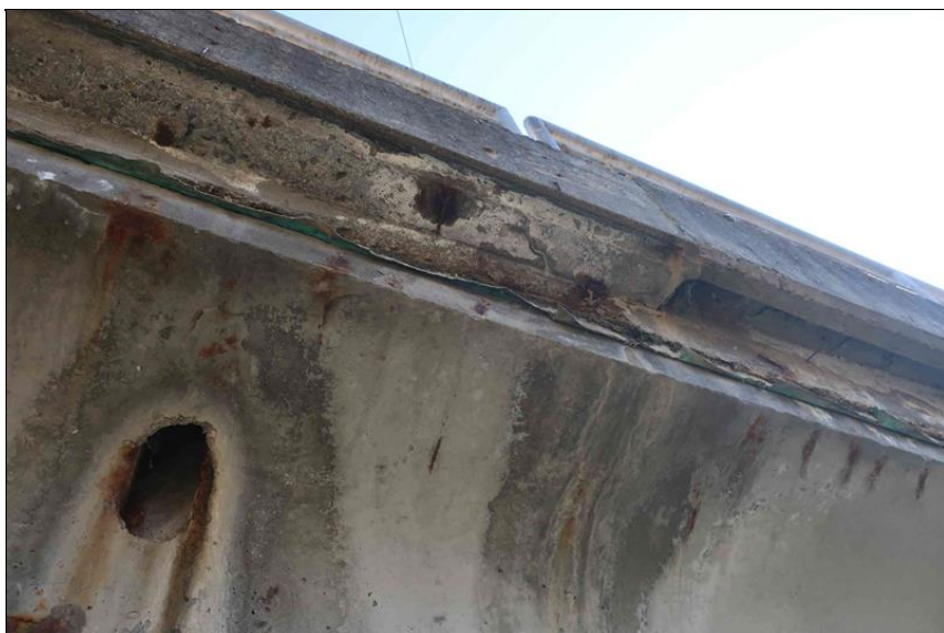
deformace a zcizení části okapničky na levém boku mostu u O1
