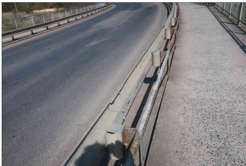
koroze sloupků levého svodidla
