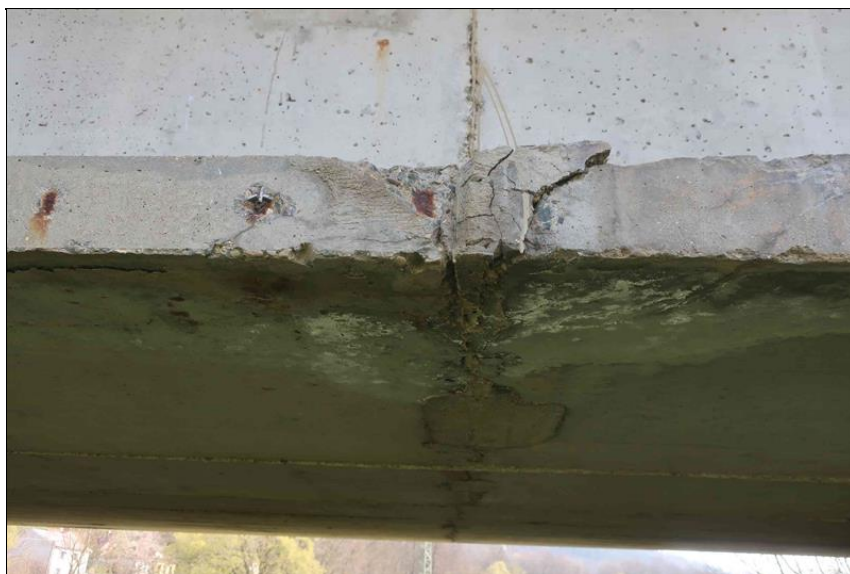
DTTO + lokální průsak příčnou pracovní sparou 10. nosníku mezi jednotlivými dílci (korálky)
