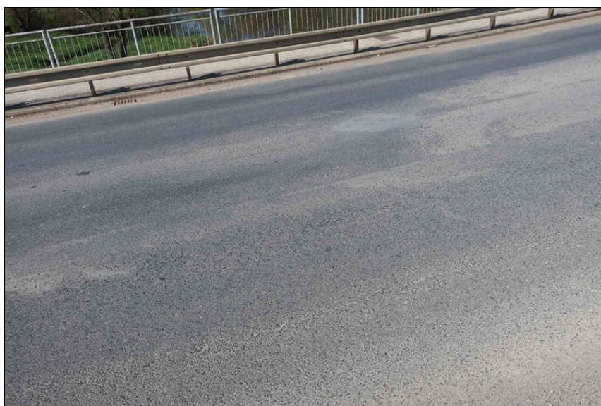
deformace krytu vozovky
