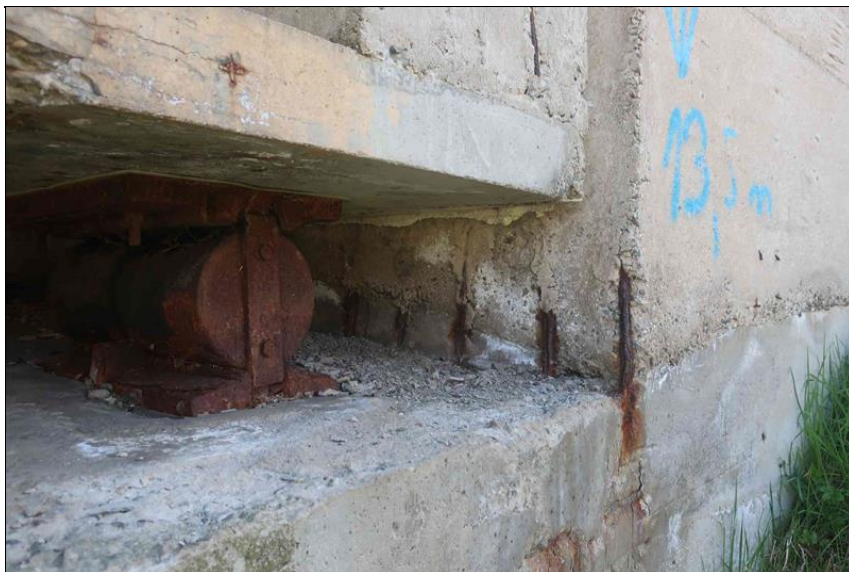
intenzivní koroze svislé výztuže v oblasti nedostatečné tloušťky krycí vrstvy na lici ZZ O3
