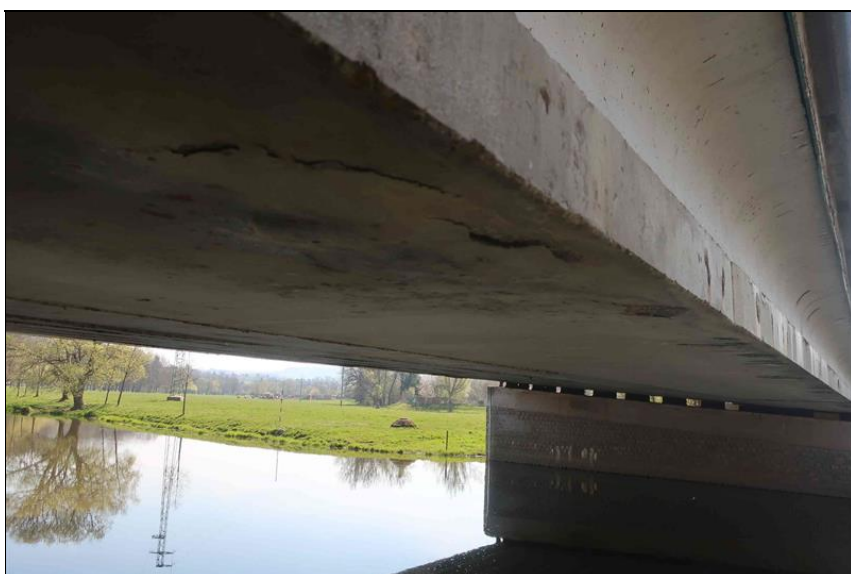
rozsáhlá separace krycí vrstvy nad korodující výztuží na spodním líci 10. nosníku
