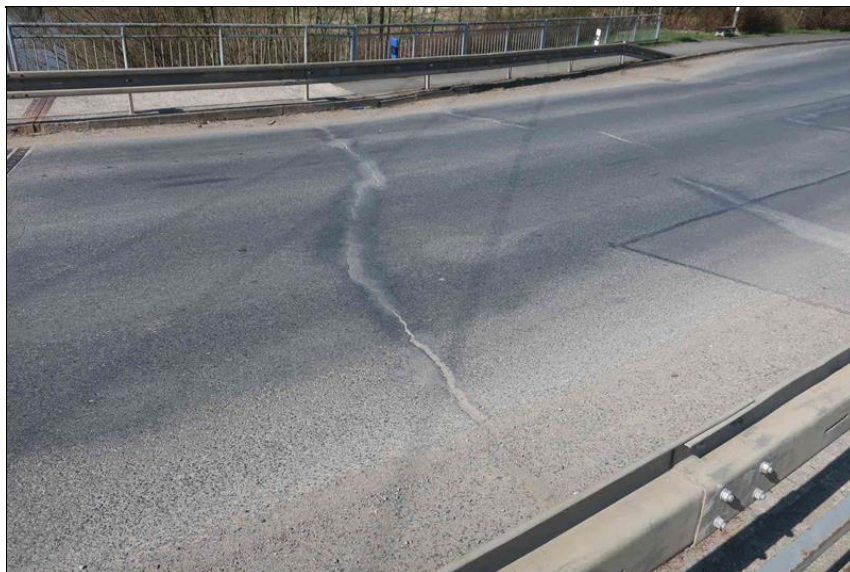
příčná trhлина v krytu vozovky před O1
