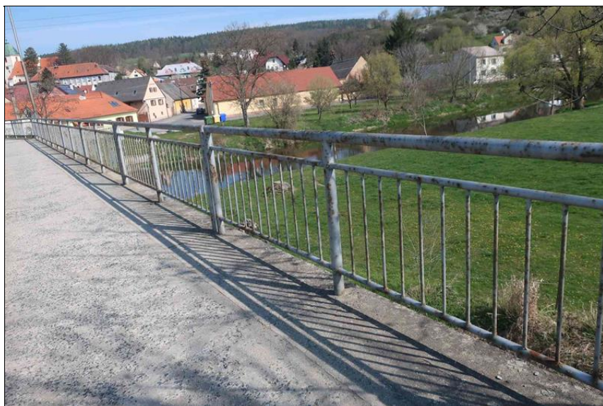
koroze levého zábradlí
