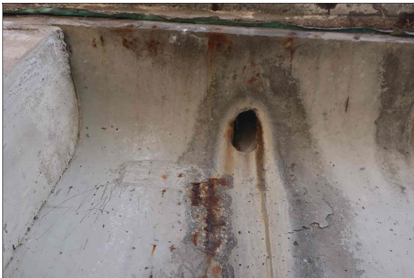
výrazné stopy po průsaku a korodující výztuž na boku 10. nosníku nad O1
