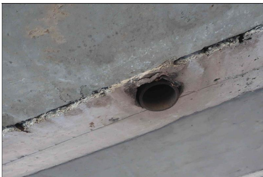
stopy po průsaku mezi 8. a 9. nosníkem ve 2. poli v okolí svodu odvodnění
