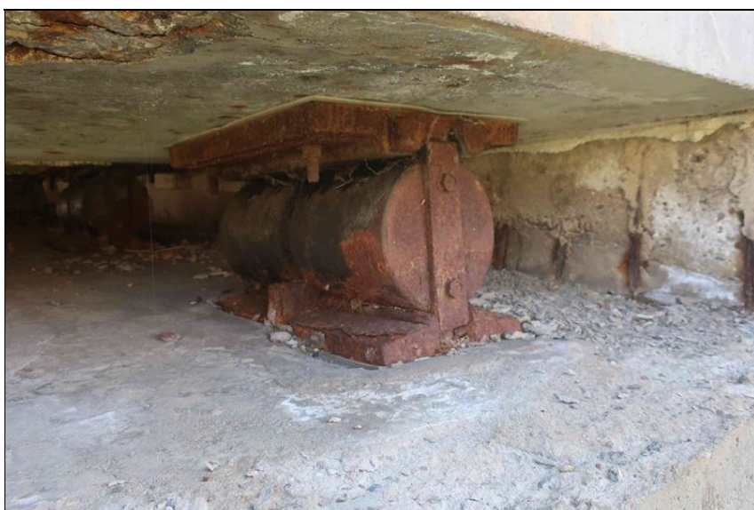
koroze ložiska na O3 pod 10. nosníkem
