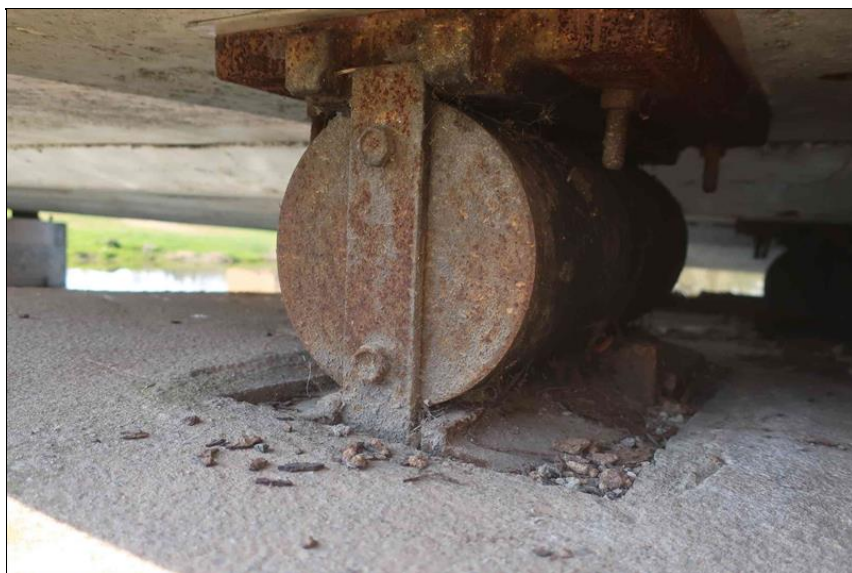
koroze ložiska na O1
