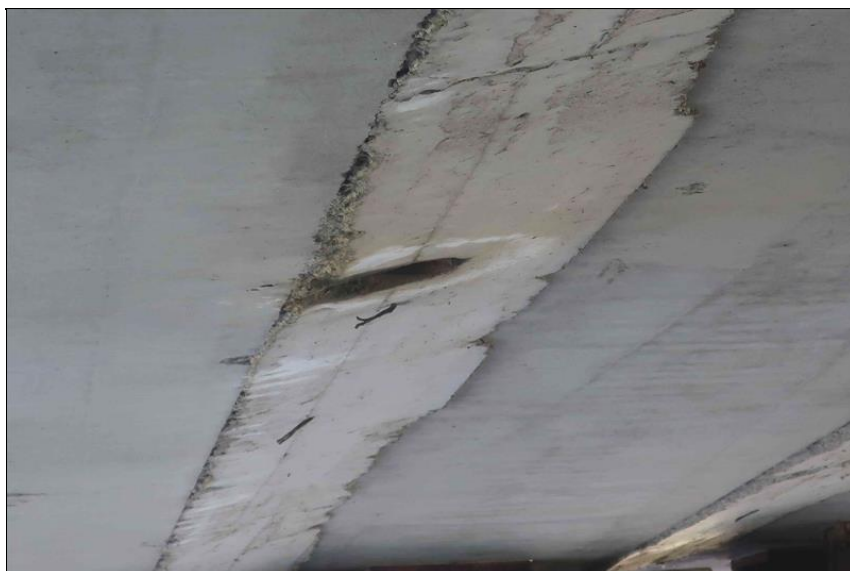
nedostatečná délka svodu odvodnění ve 2. poli
