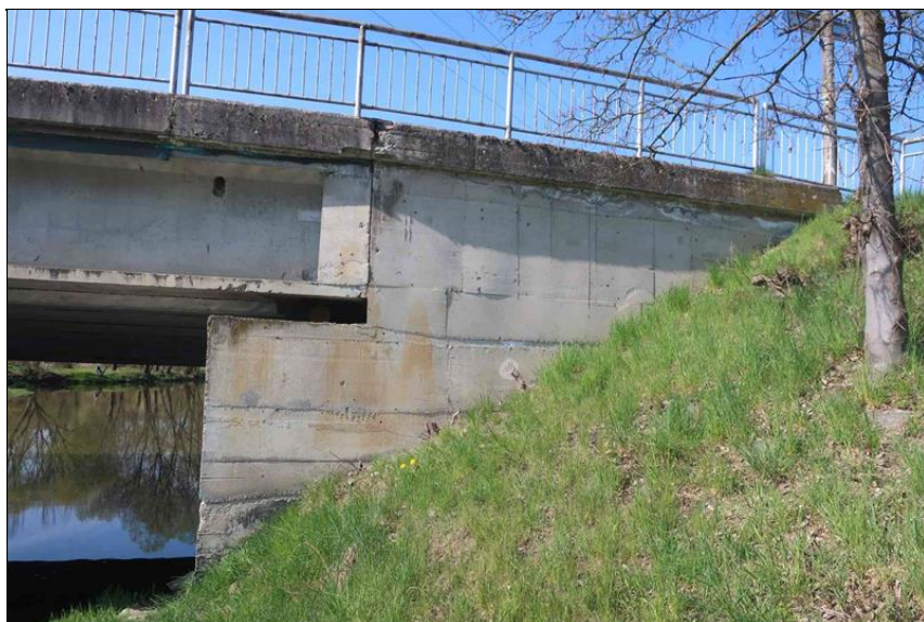
sevřená dilatační spára mezi čelem NK a ZZ O1 - pohled zleva
