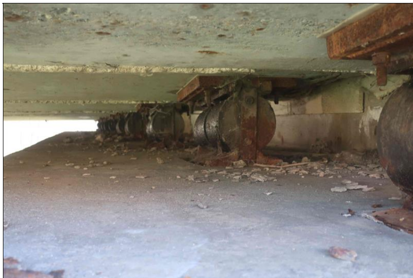
drobné nánosy na ÚP O3, lokální koroze ložisek
