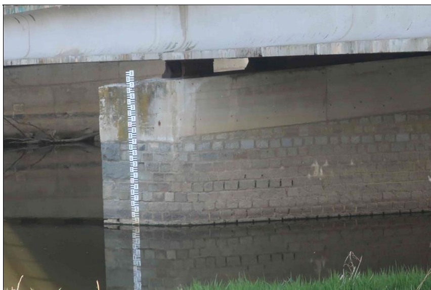
pravá strana P2 směrem do 2. pole poruchy spárování obkladního zdiva, degradace betonu vyložené části stativa vně NK
