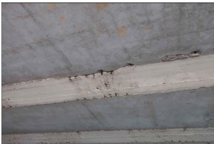
nedostatečná tloušťka a kvalita betonu dobetonávky spáry mezi dolními pásnicemi nosníků
