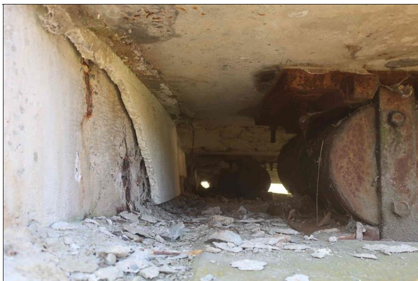
nánosy na ÚP O3, intenzivní koroze výztuže ZZ a koroze ložisek - pohled zleva
