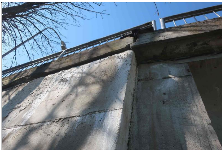
výrazné výluhy pojiva na levém boku ZZ O3 "nulová" šířka dilatační spáry nad O3
