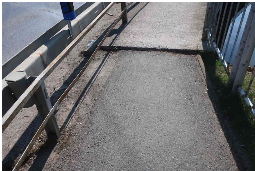
částečně prosedlé těleso navazujícího pravého chodníku před O1
