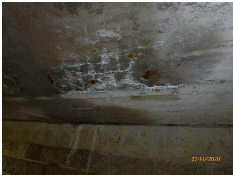
Silné stopy po průsacích s vápennými výluhy pojiva a stopy po korodující výztuži na podhledu NK v 1. poli u P2.
