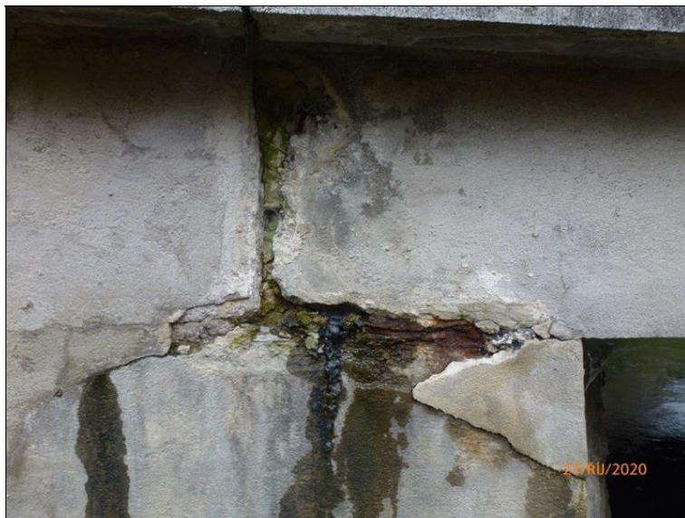
Poruchy na pravém boku OP1 a koroze ložiska.
