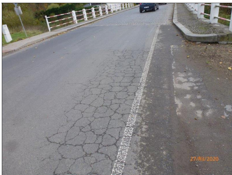
Sítové trhliny v živičném krytu před mostem.
