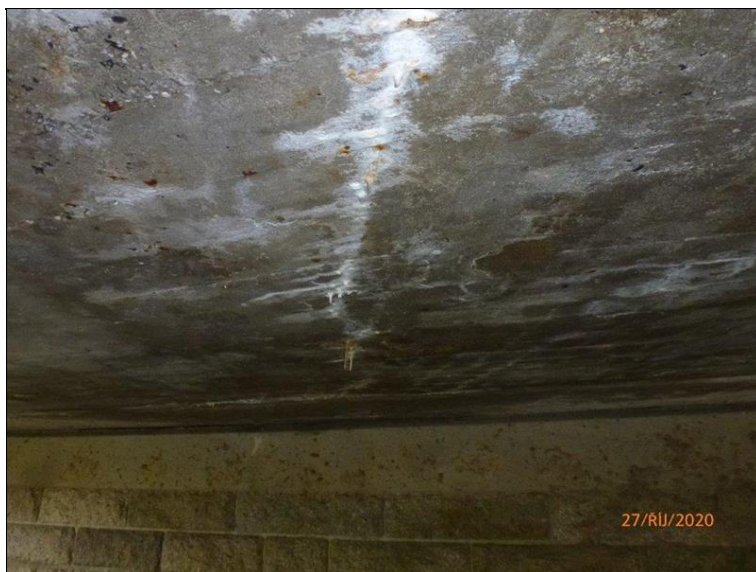
Podélná trhlina s výluhy na pohledu NK ve 2. poli.
