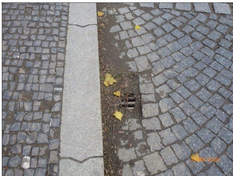
Částečně zanesená mříž odvodňovače.
