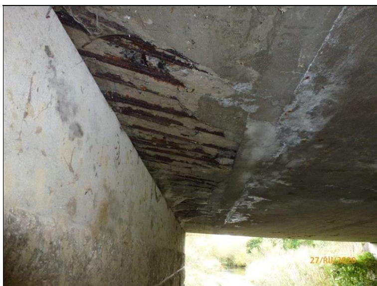
Koroze obnažené výztuže ve 2. poli podél P2.
