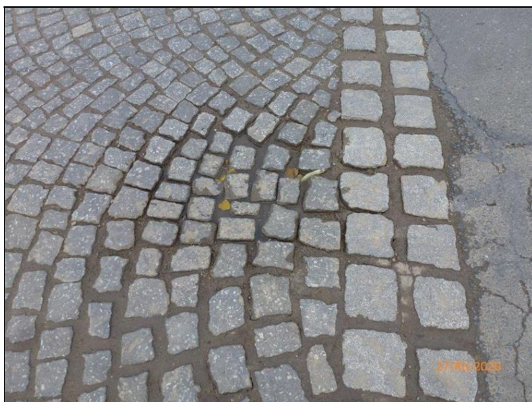
Rozestoupená dlažba vozovky na mostě.
