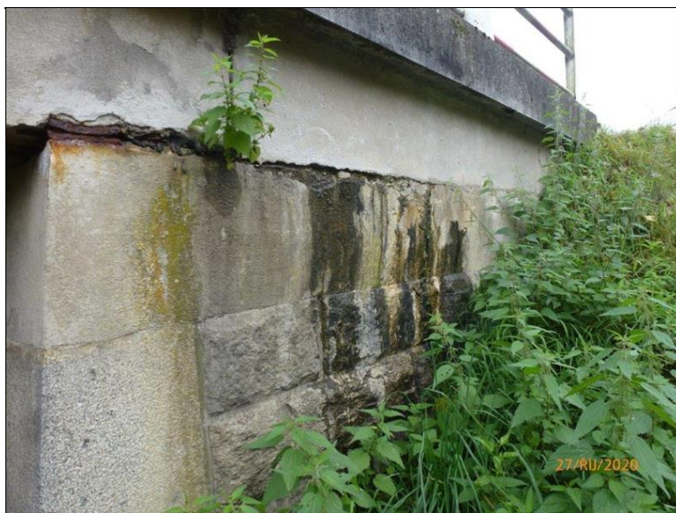
Pravé křídlo OP4 - prosakující pracovní spára.
