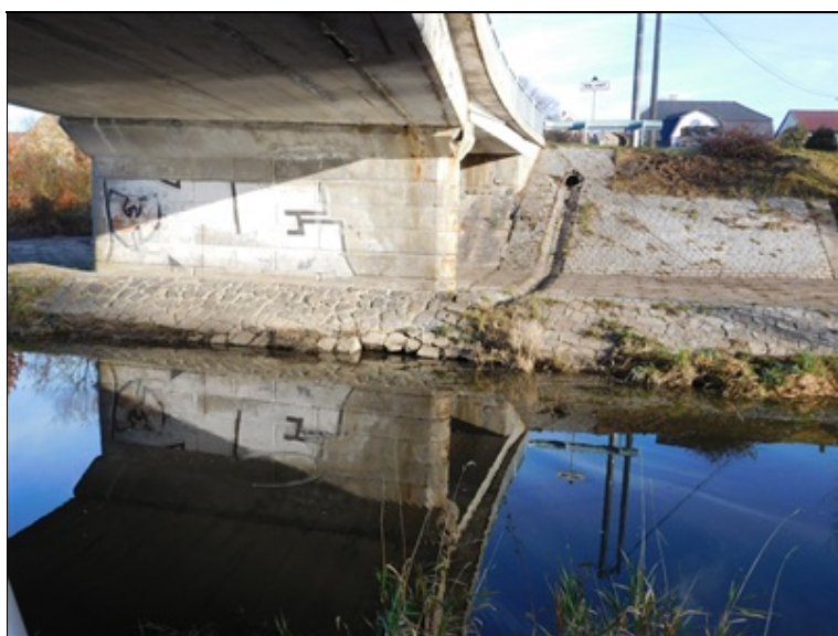
Rozpadlé opevnění svahu koryta řeky u pilíře 3
