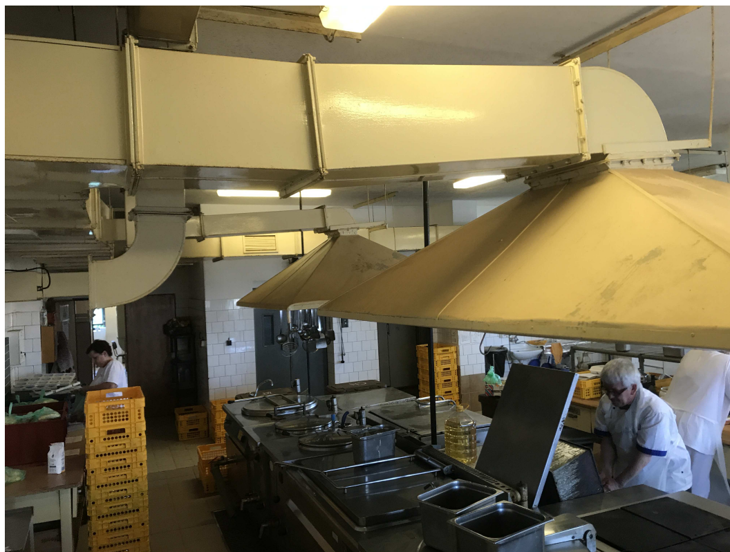
Stávající vzduchotechnika 2.NP
