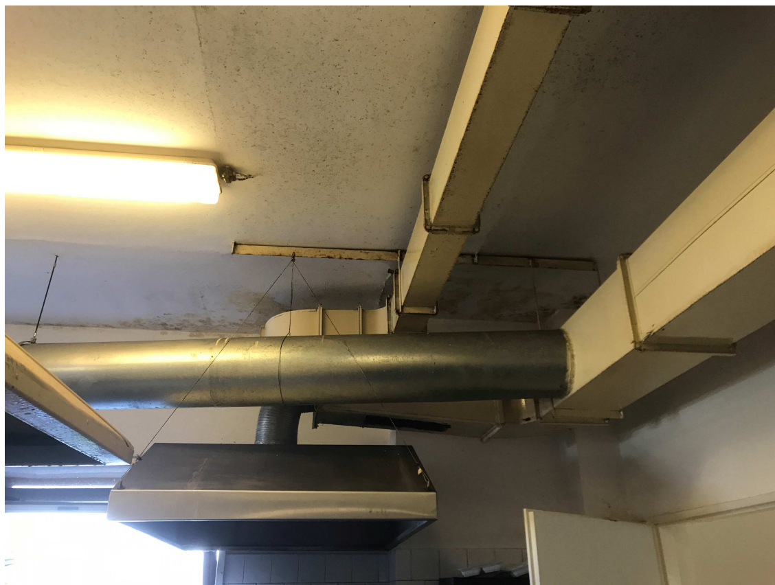
Stávající vzduchotechnika 2.NP
