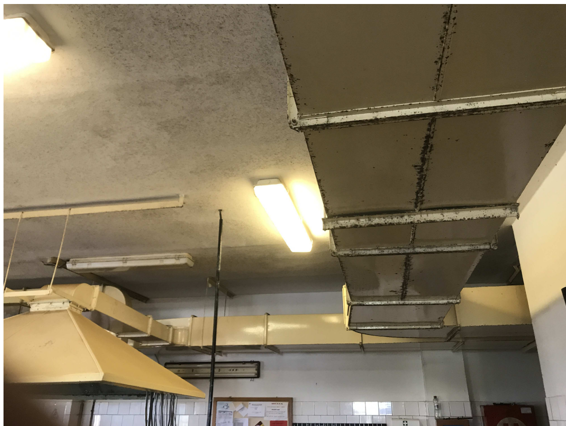
Stávající vzduchotechnika 2.NP
