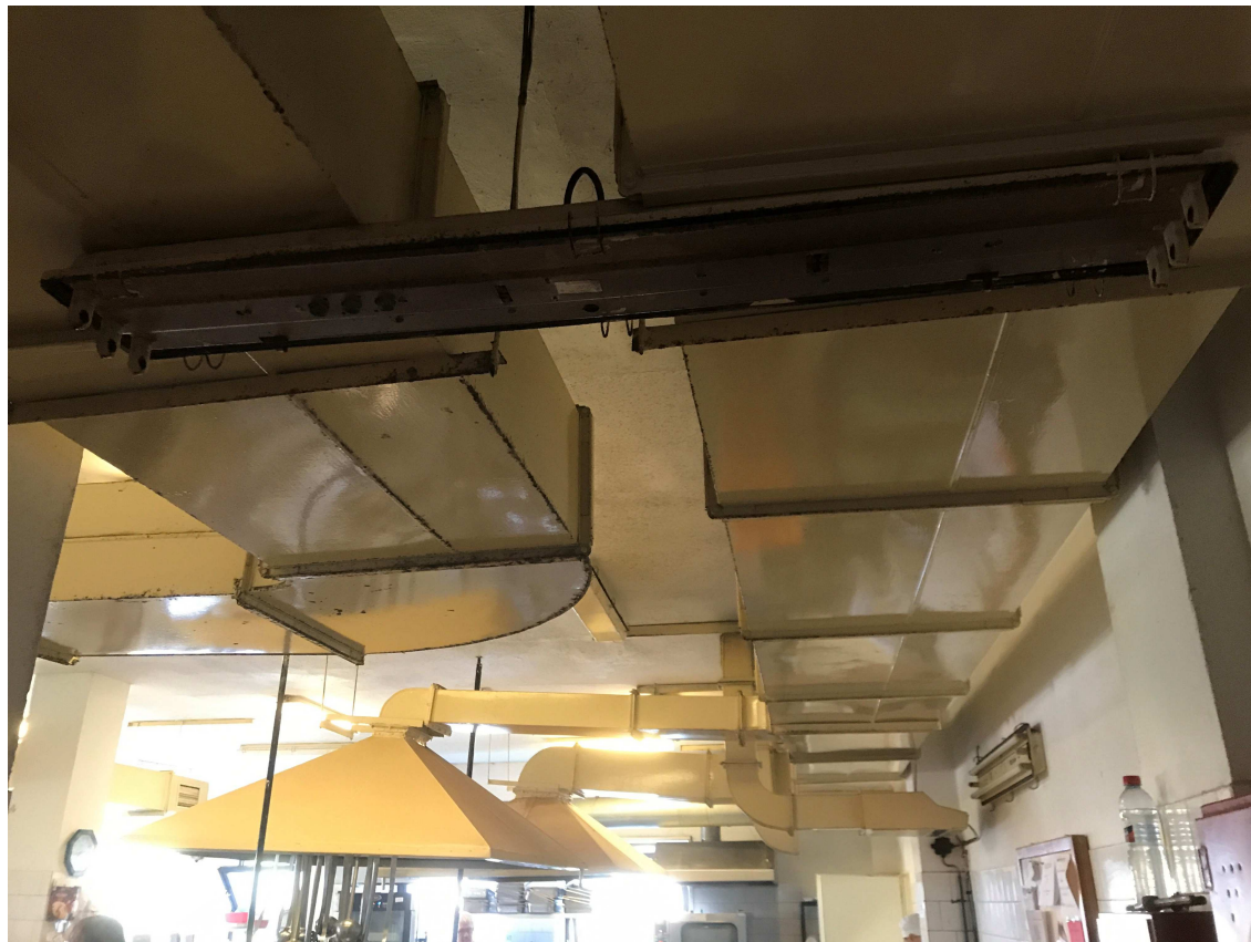
Stávající vzduchotechnika 2.NP
