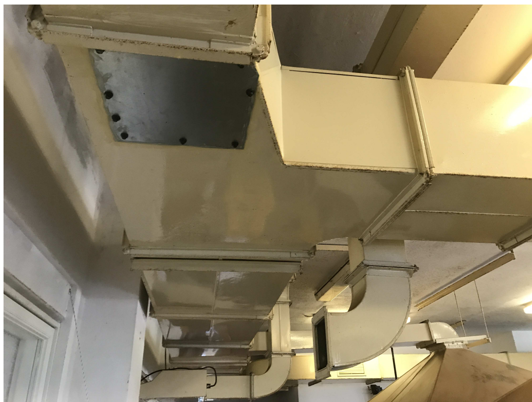
Stávající vzduchotechnika 2.NP
