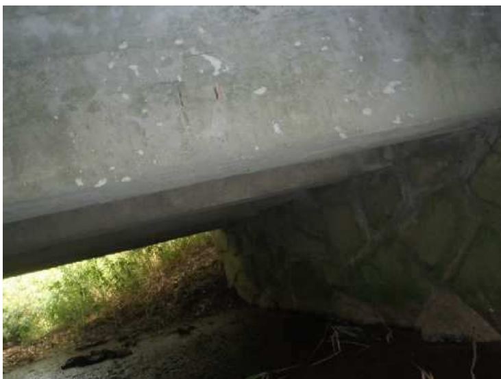
Poruchy na líci zdiva opěry.
