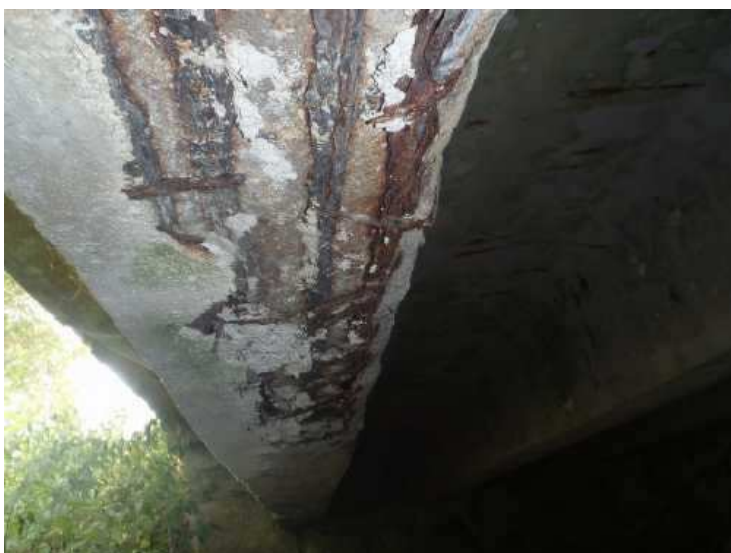
Totální koroze nosné výztuže krajního trámu.
