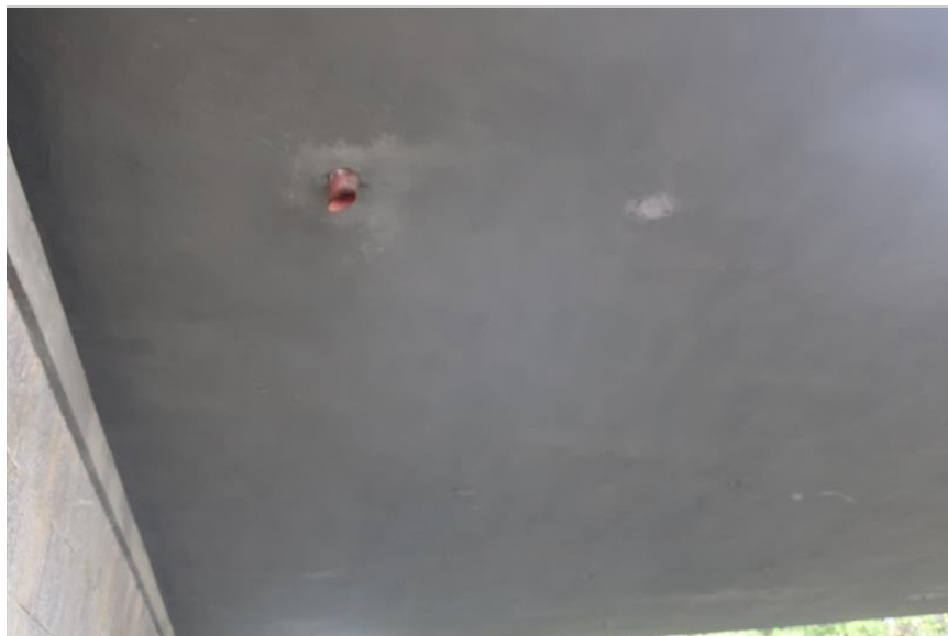
podhled NK 2. pole u O3 - stopy po průsacích v okolí svodu odvodnění
