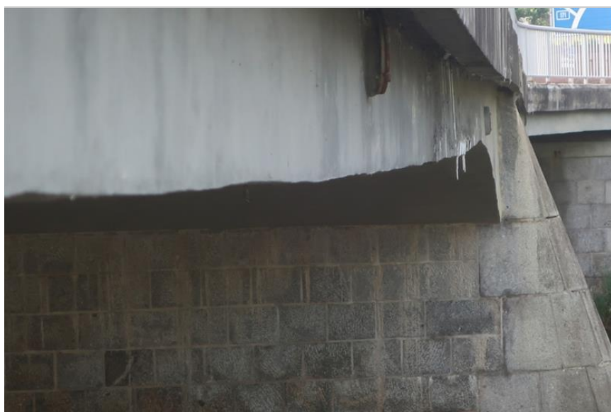
výrazná deformace pravé hrany NK 1. pole - pohled od O1
