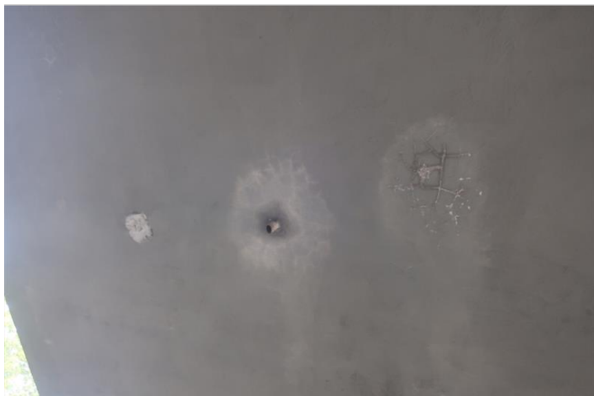
stopy po průsacích na spodním lici NK 2. pole
