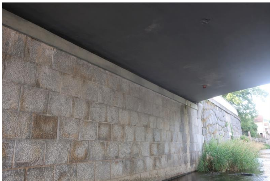
stopy po průsacích na líci zdiva O3 vpravo
