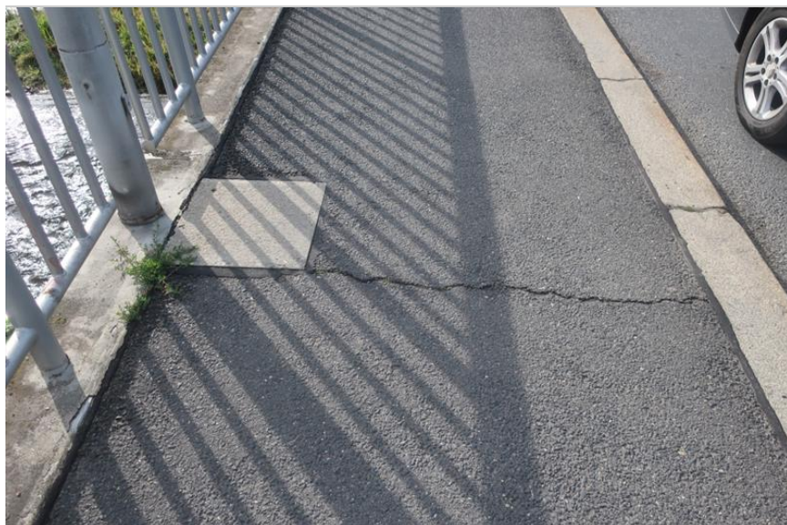
příčná trhлина v krytu chodníku
