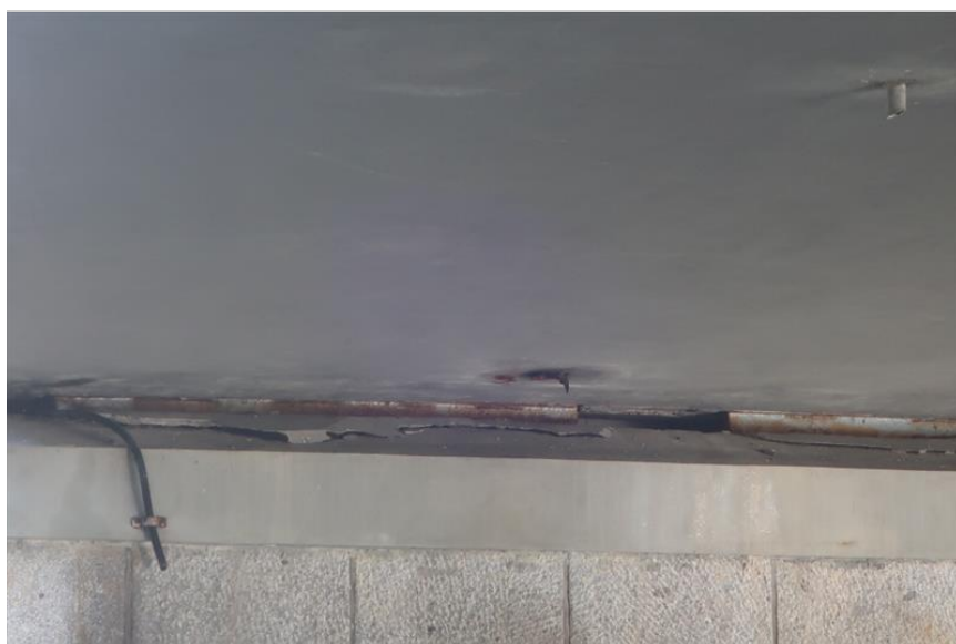
uložení NK na O1 - separace sanace na horním lici ÚPO1, stopy po průsacích na spodním lici NK, koroze ložisek
