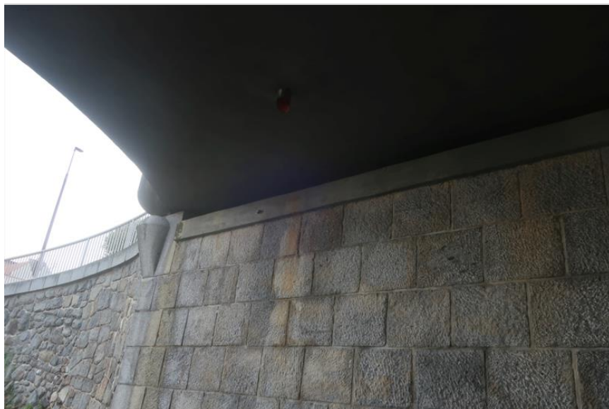
stopy po průsacích na líci zdiva O3 vlevo
