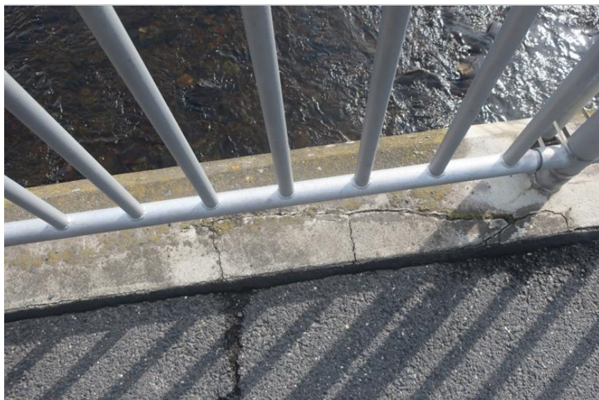
trhliny v římsě
