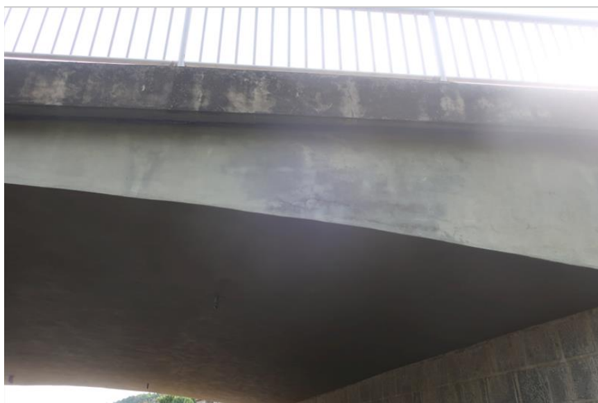
podélné trhliny na pravém boku NK 1. pole před P2, příčné smršťovací trhliny na vnějším boku pravé římsy
