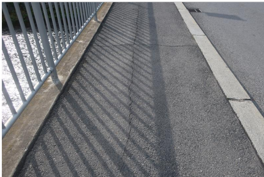
podélná trhlina a deformace v krytu chodníku
