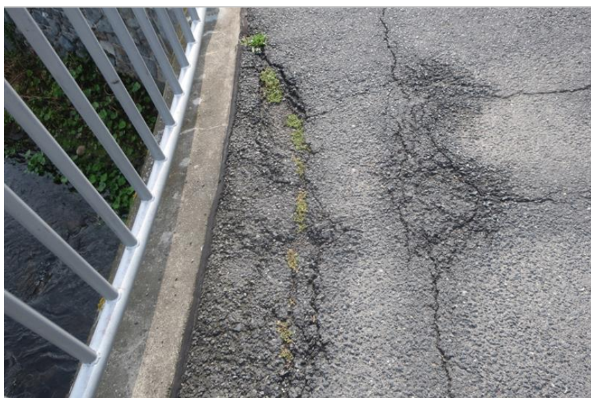
nepravidelné trhliny v krytu chodníku
