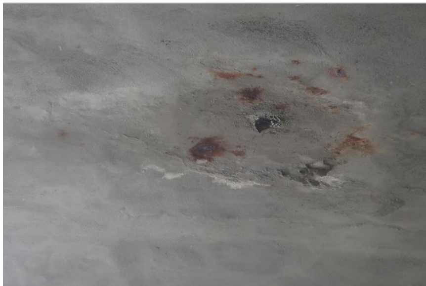
stopy po průsaku se stopami koroze na spodním lici NK 1. pole u O1
