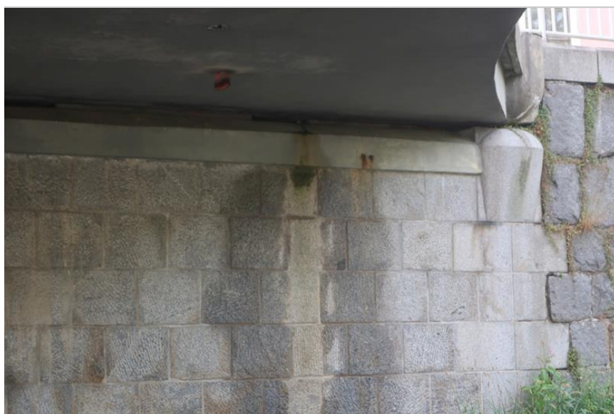
stopy po průsacích na lici zdiva O3 vpravo
