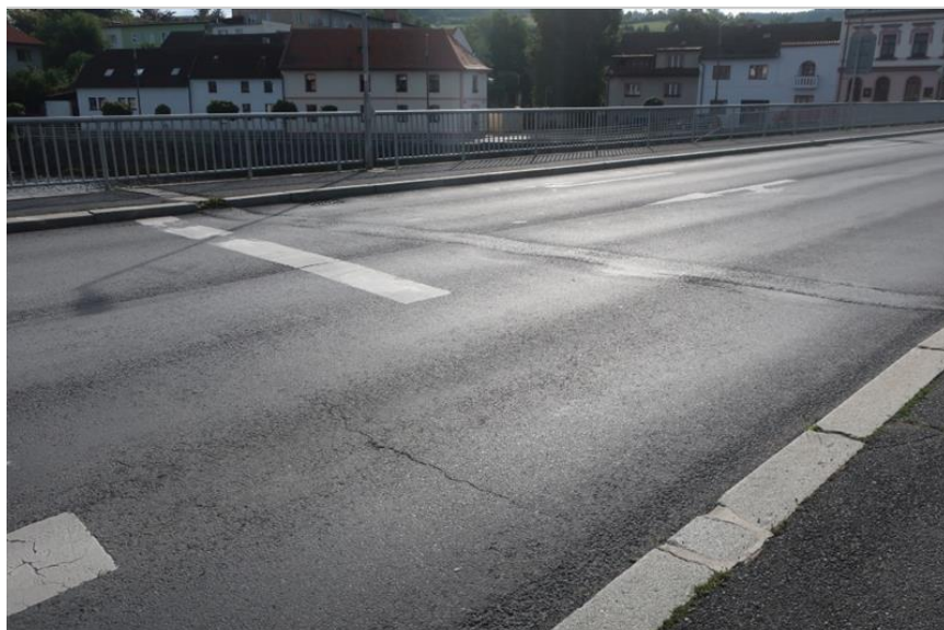
výrazná deformace krytu vozovky
