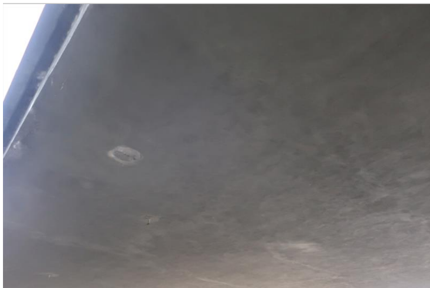
stopy po průsacích na spodním lici NK 1. pole
