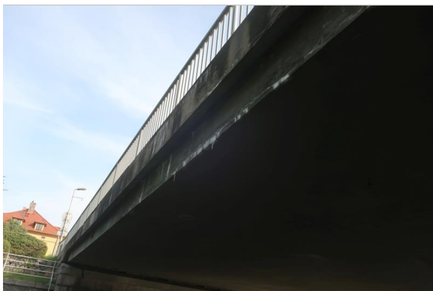
podélné trhliny s výluhy pojiva na pravém boku NK 1. pole
