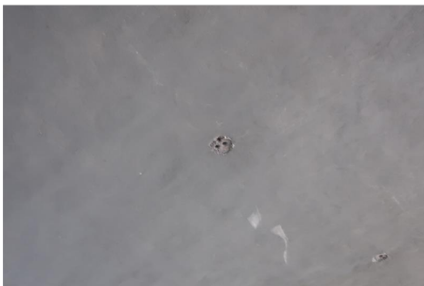
otvory na spodním líci NK 2. pole
