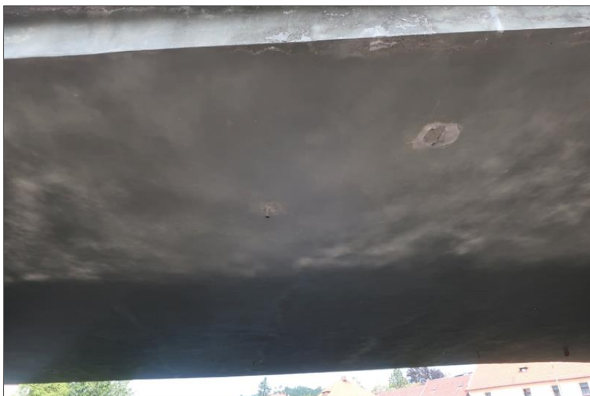
příčný podhled desky zleva v 1. poli
