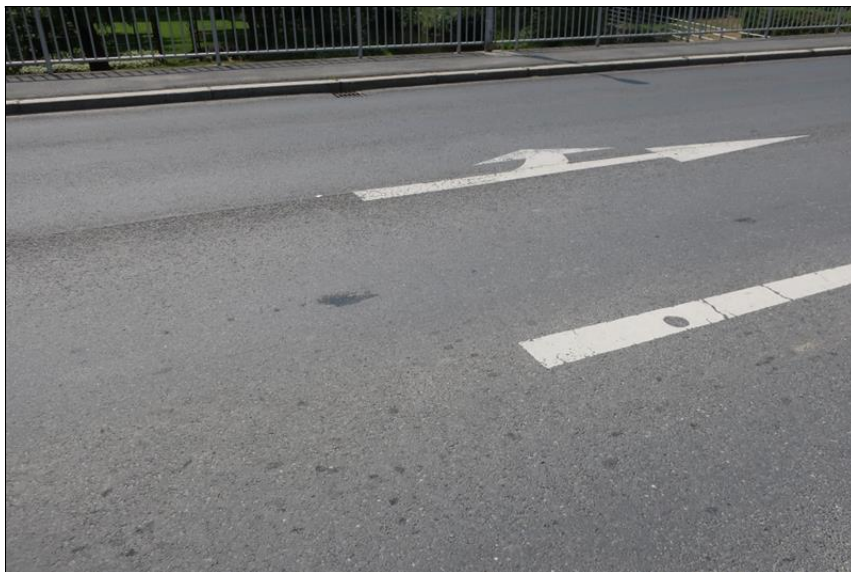
kryt vozovky je mírně deformovaný
