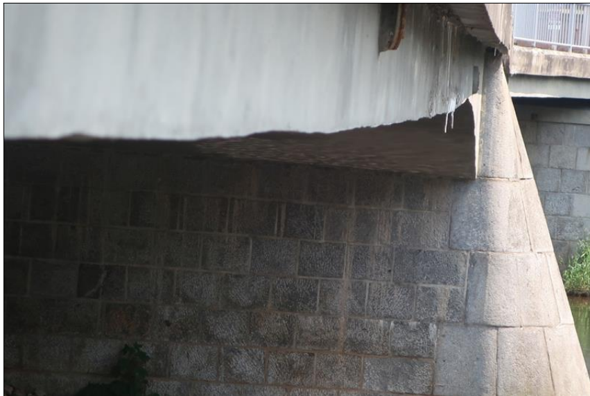
deformace spodního líce NK v 1. poli
