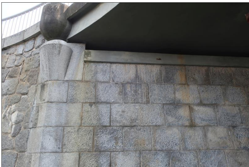
stopy po průsacích na lici O3 z úložné spáry
