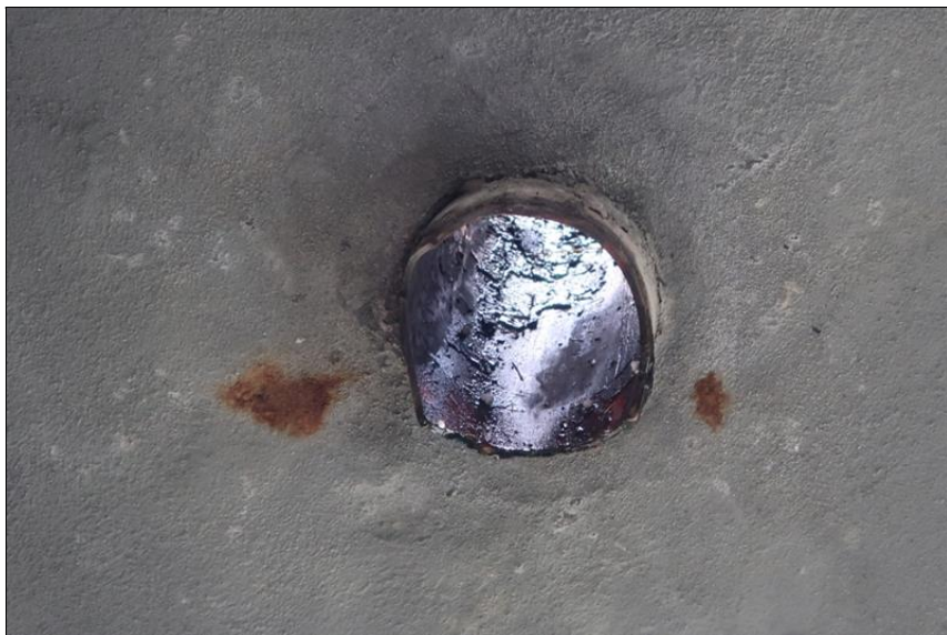
stopy koroze v okolí svodu odvodňovače
