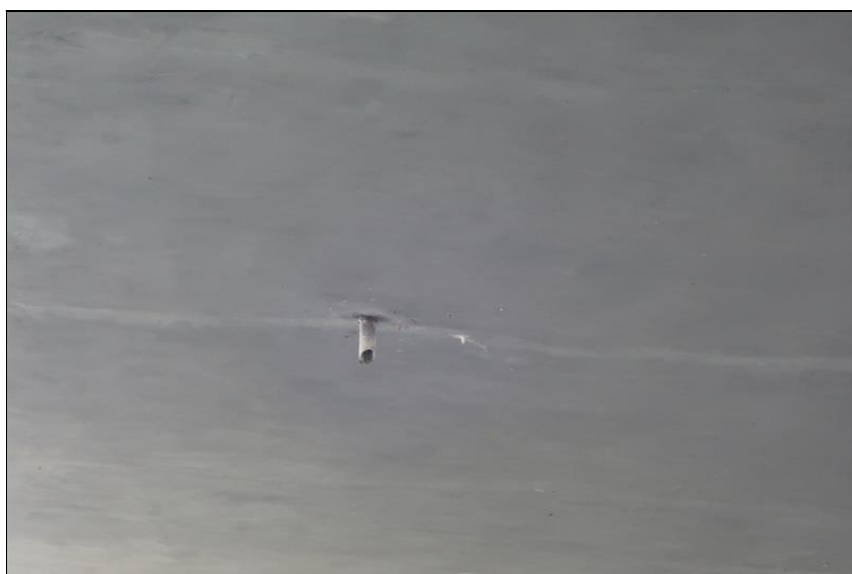
příčná trhлина v desce s výluhem pojiva u trubky odvodnění povrchu izolace
