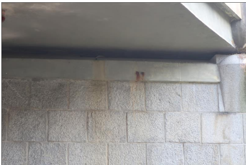
stopy po průsacích a stopy koroze na líci ÚP O3
