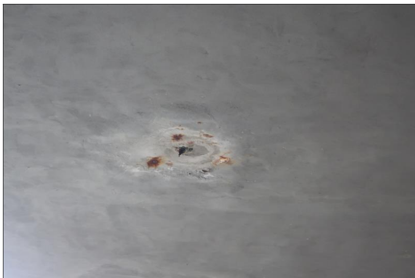
bodový průsak se stopami koroze a s výluhy pojiva na spodním líci desky v 1. poli
