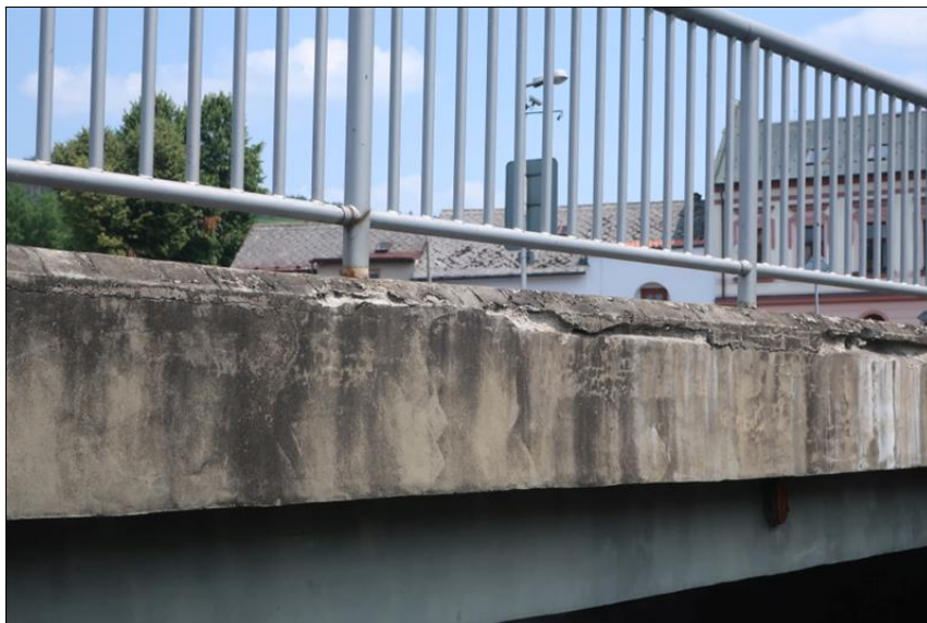
degradace betonu pravé římsy v 1. poli
