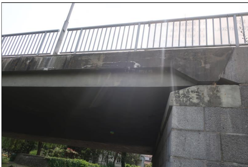
trhliny s výluhy pojiva v levé římse
