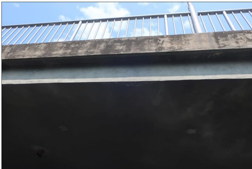
degradace betonu římsy
