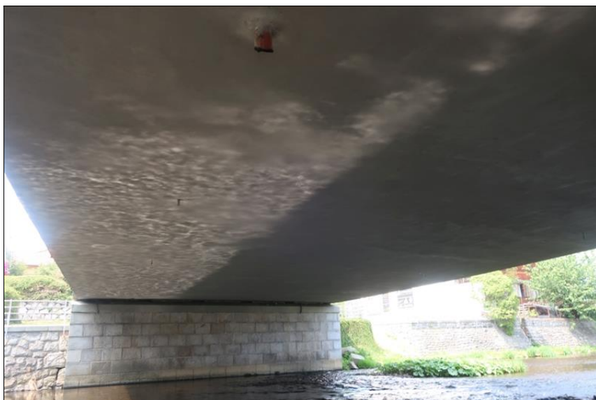
podhled desky v 1. poli od P2 směrem k O1
