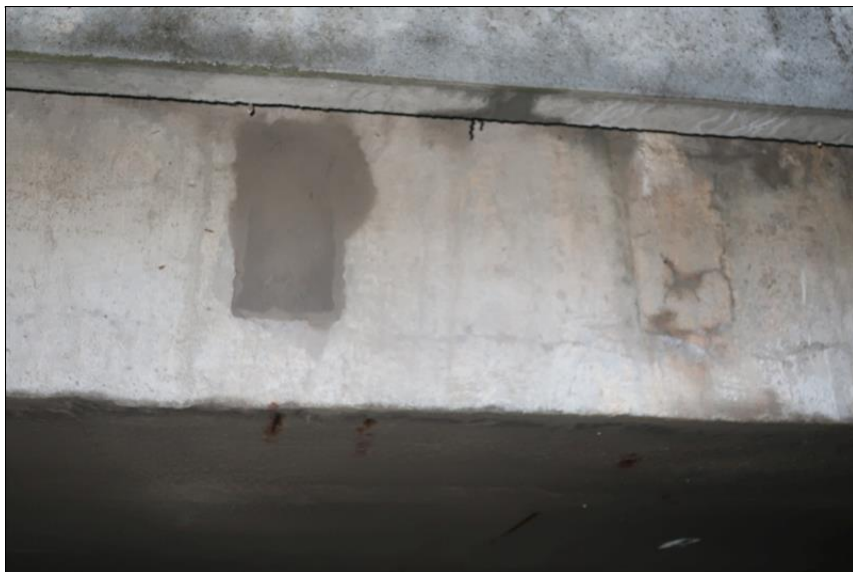
poškozené dobetonávky kotev příčného sepnutí
