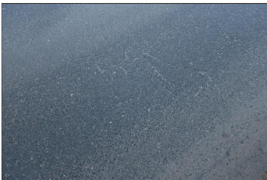
nepravidelné trhliny v krytu vozovky
