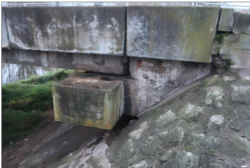
stopy koroze v místě aktivních průsaků na levém boku O1 obnažená korodující kotva předpínacího kabelu krajního levého nosníku nad O1
