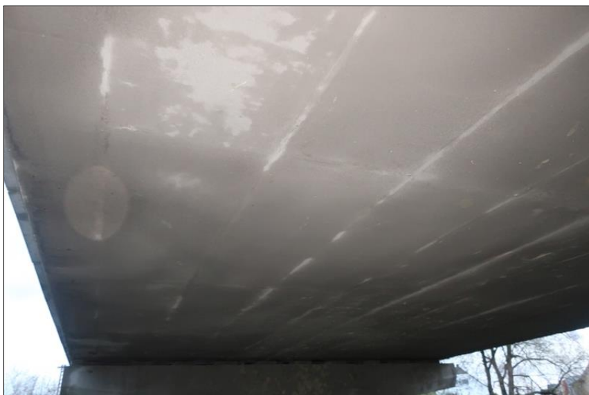
podhled NK ve 4 poli - stopy po průsacích zejména sparami mezi nosníky
