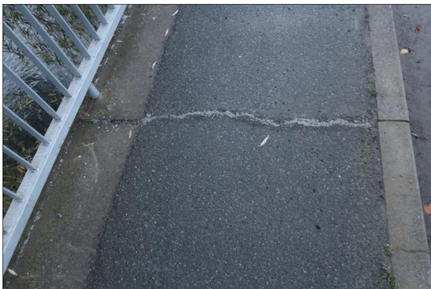
příčná trhlina v krytu chodníku
