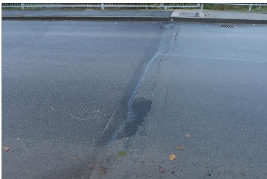
příčné trhliny v krytu chodníku nad O1
