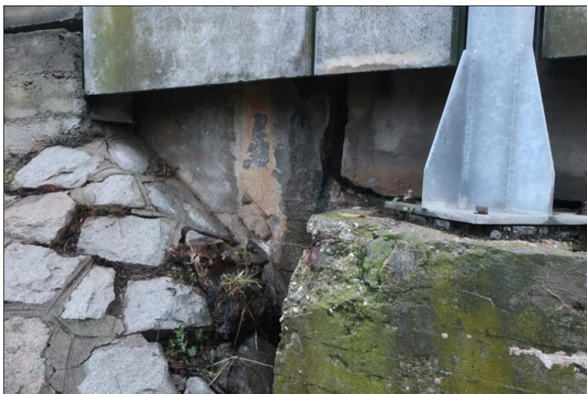
stopy koroze v místě aktivních průsaků na pravém boku O1 obnažená korodující kotva předpínacího kabelu krajního pravého nosníku nad O1
