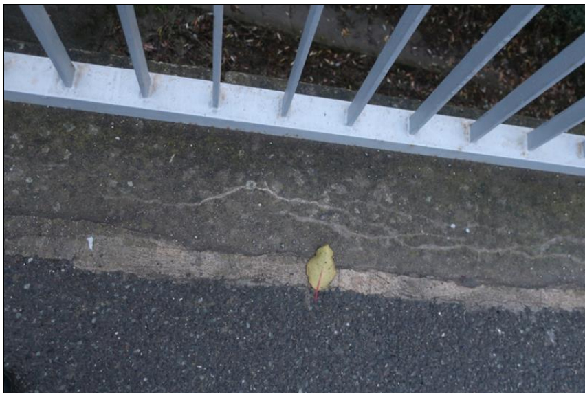
trhliny v římse
