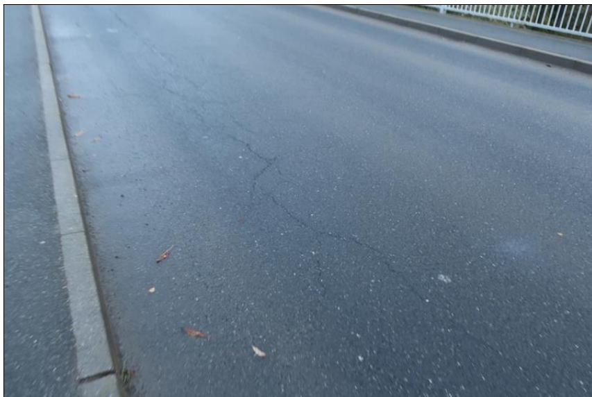
trhliny v krytu vozovky
