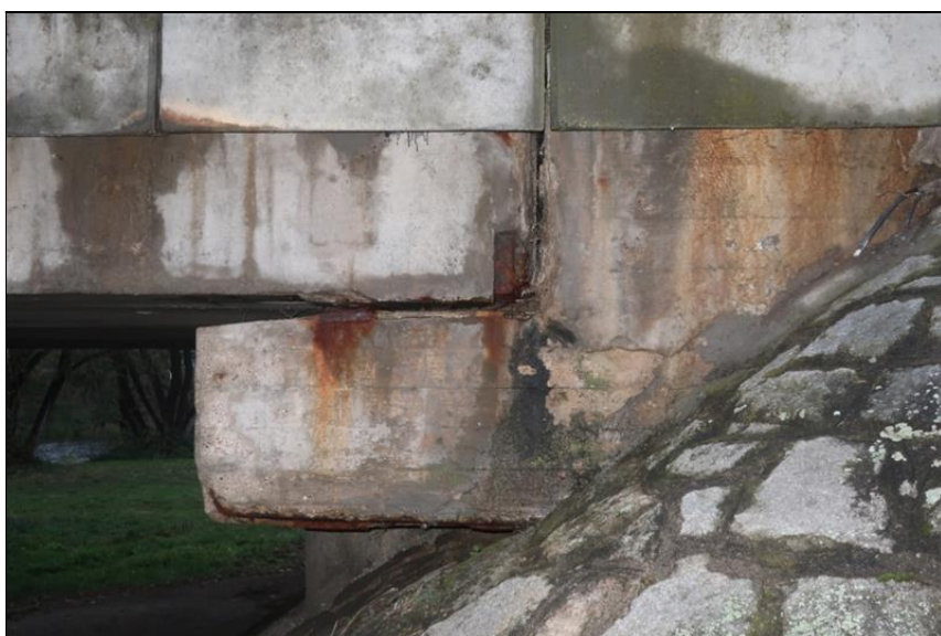
stopy koroze v místě aktivních průsaků na pravém boku O6 obnažená korodující kotva předpínacího kabelu krajního pravého nosníku nad O6
