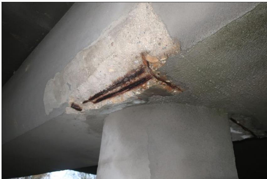
intenzivně korodující výztuž stativa P5
