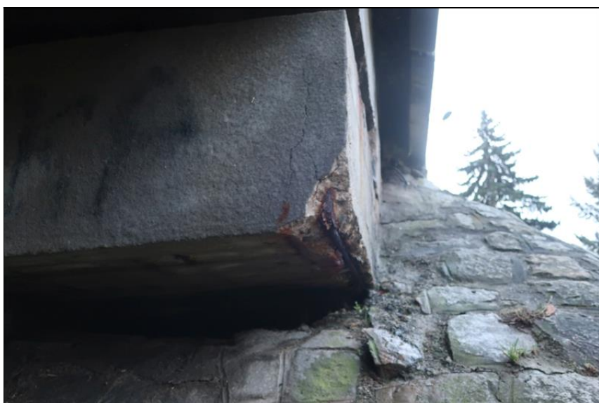
pravá hrana úložného prahu O6 - obnažená korodující výztuž
