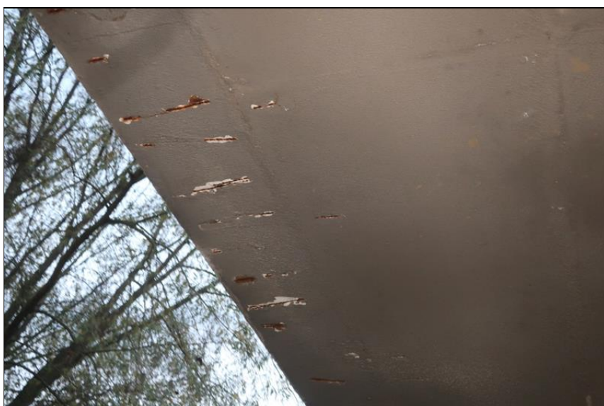
koroze konstrukční výztuže na spodním líci levého krajního nosníku v 1. poli
