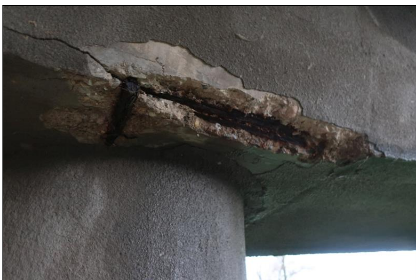
intenzivně korodující výztuž stativa P5, separace krycí vrstvy nad korodující výztuží
