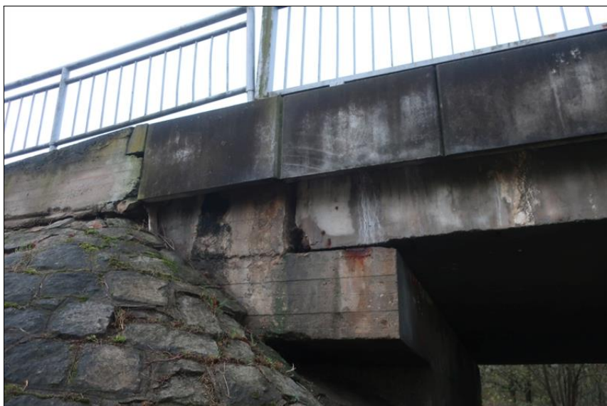
stopy koroze v místě aktivních průsaků na pravém boku O6 obnažená korodující kotva předpínacího kabelu a hloubková degradace dobetonávky krajního levého nosníku nad O6
