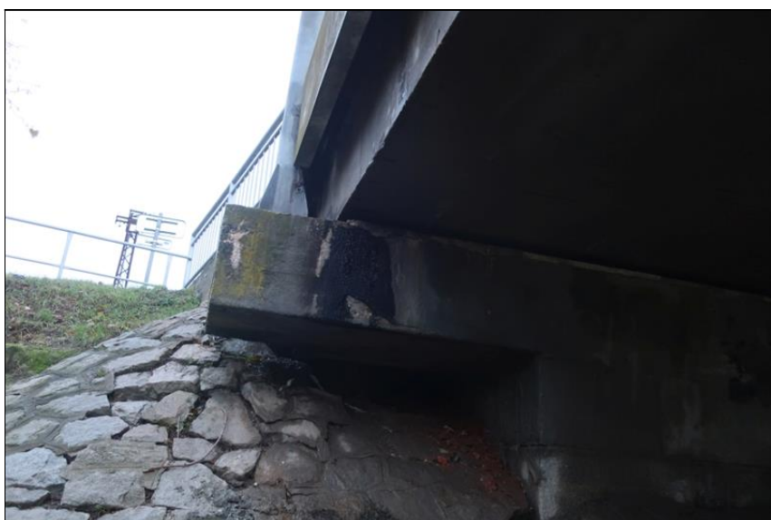
poškozené spárování dlažby zpevnění svahového kužele u pravého boku O1
