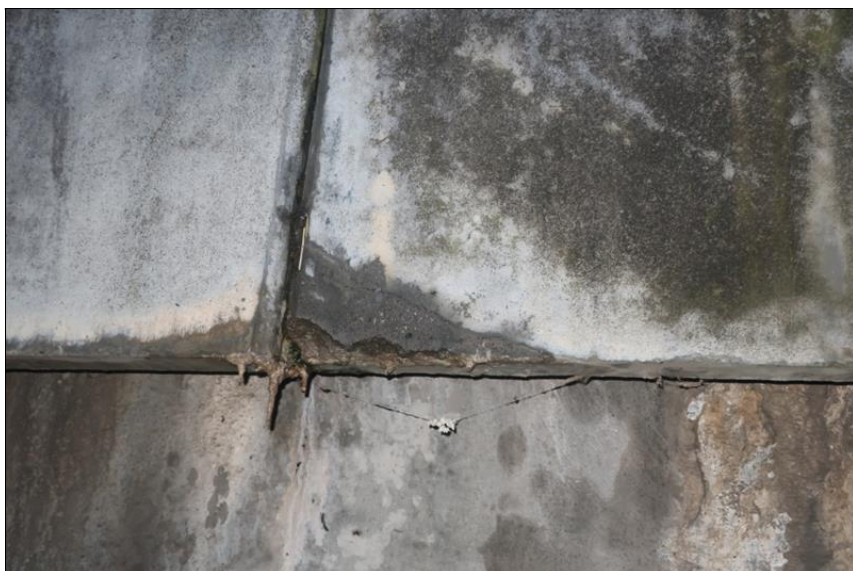
degradace betonu lícového prefabrikátu římsy
