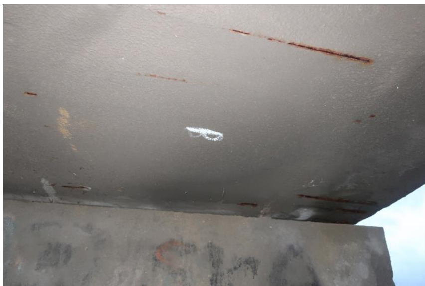
dutiny nosníků nejsou odvodněny koroze obnažené konstrukční výztuže
