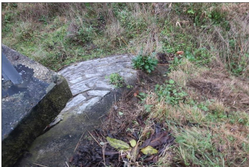
částečně zarostlý odvodňovací skluz
