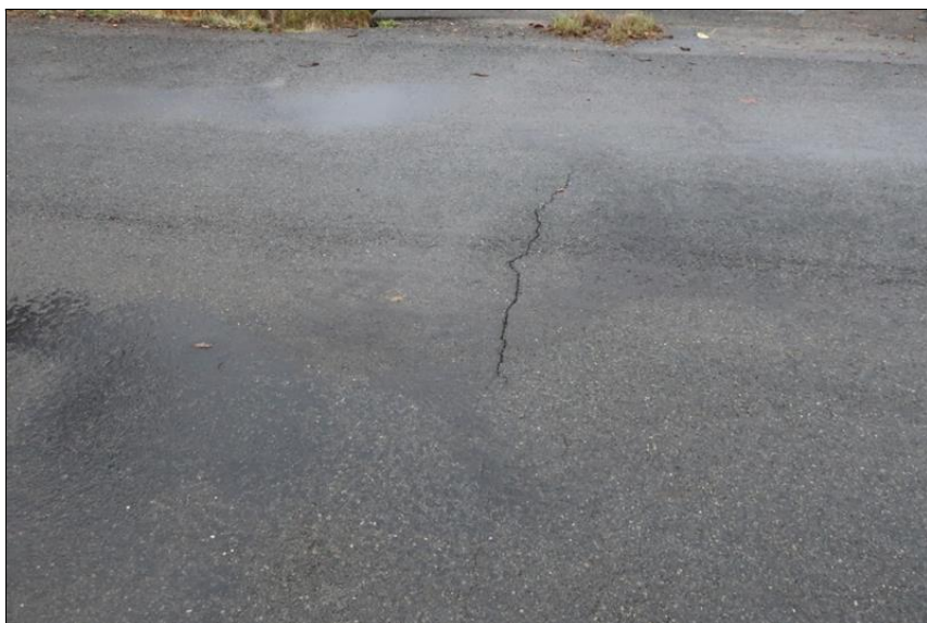
trhlina v krytu vozovky nad O2
