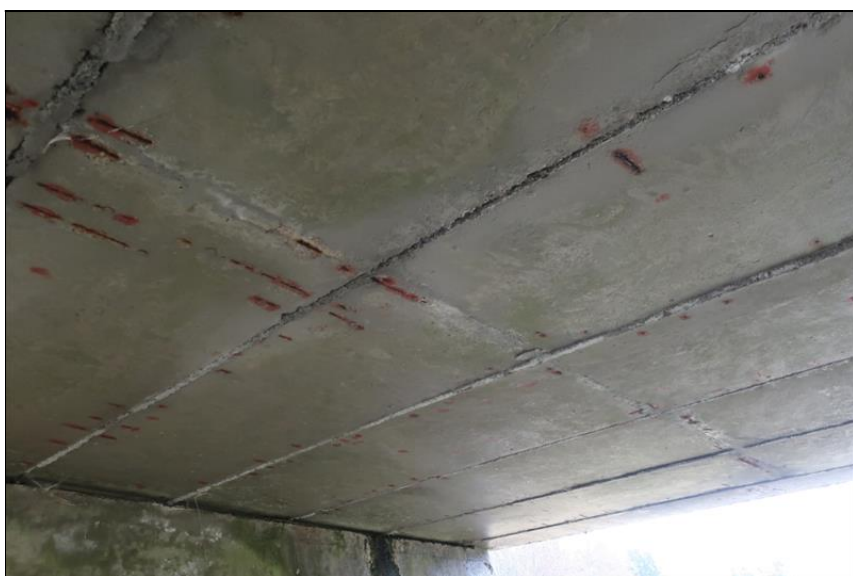
podhled NK vpravo u O2 stopy po průsacích v oblastech spar mezi nosníky dutiny mezilehlých nosníků nejsou odvodněny
