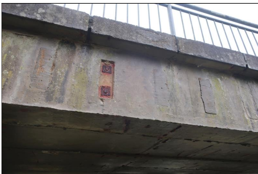
koróze obnažených kotev příčné předpětí
