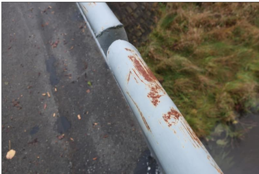
počínající koroze zábradlí
