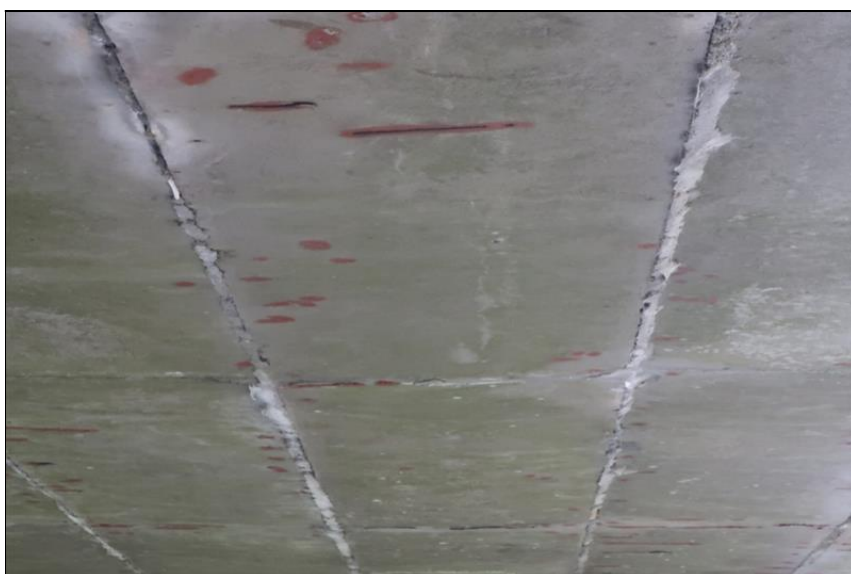
podélné trhliny na spodním líci nosníku kopírují trajektorii předpínací výztuže
