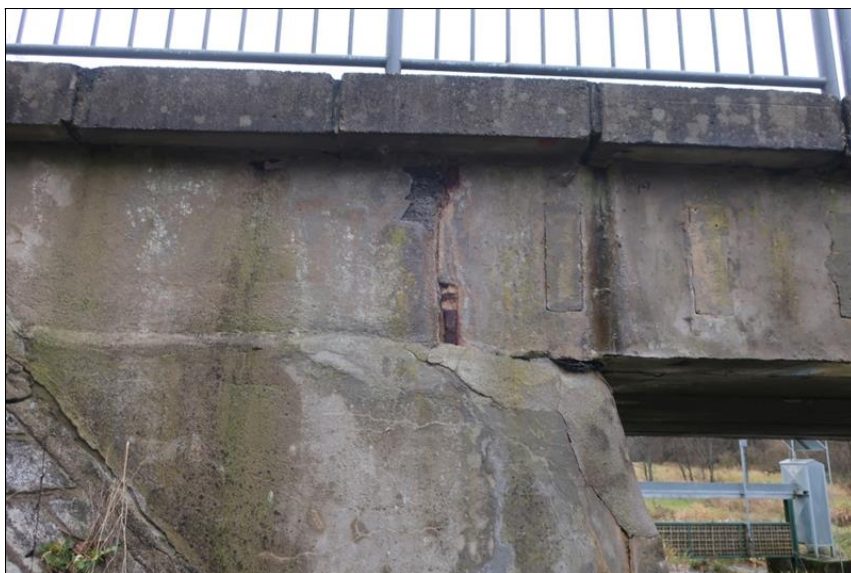
obnažené korodující kotvy podélného předpětí na vnějším boku levého krajního nosníku nad O2
