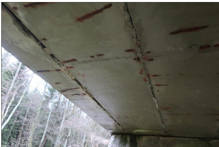
podhled NK vlevo u O2 koroze obnažené konstrukční výztuže
