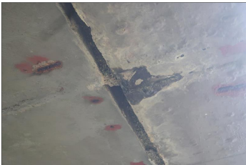
aktivní průsak sparou mezi nosníky degradace betonu výplně spar mezi nosníky
