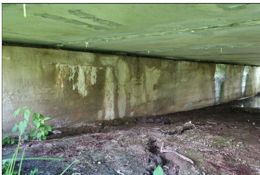
průsaky a výrazné výluhy pojiva na lici O2
