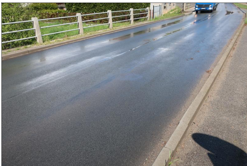
deformace krytu vozovky (vyjeté koleje)
