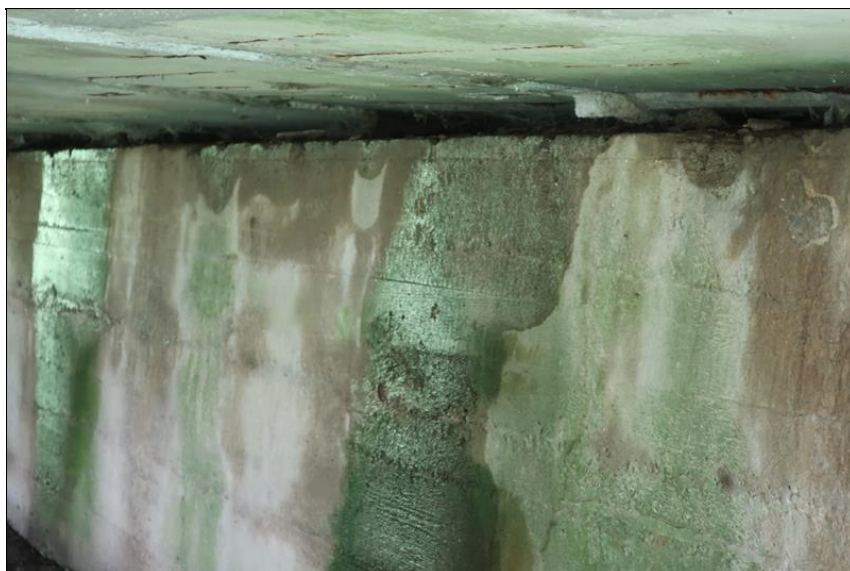
intenzivní průsak z úložné spáry O2
