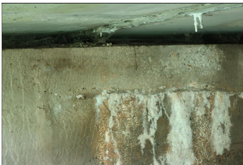
horizontální trhlina na líci O2 s výraznými stopami po průsacích a s výluhy pojiva
