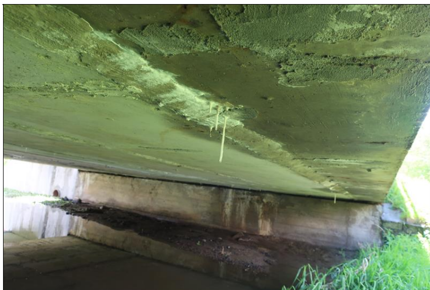
podhled NK od O2 průsak s výluhem pojiva sparou mezi 1. a 2. nosníkem
