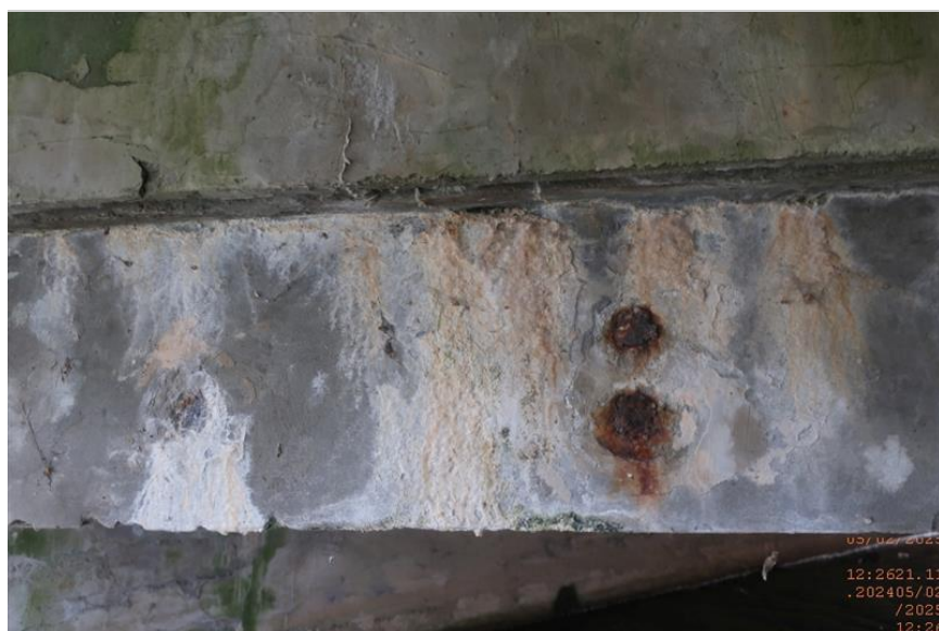
koroze kotev příčného sepnutí
