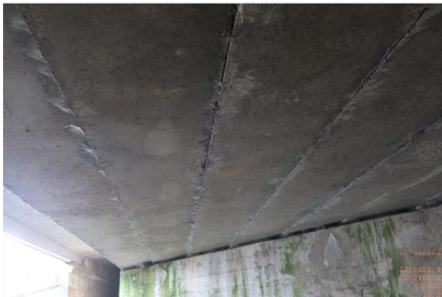
drobné stopy po prúšacích na spodní líci NK v oblastech podélných spar mezi nosníky
