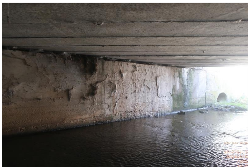
výrazné stopy po prúšacích s výluhy pojiva na líci levé části dříku O1
