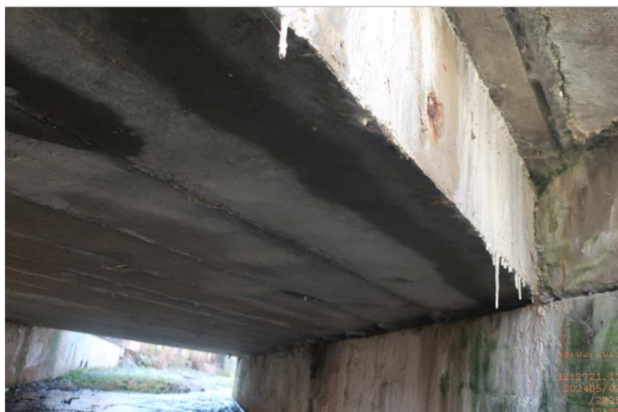
podhled 1. a 2. nosníku postižených aktivními průsaky
