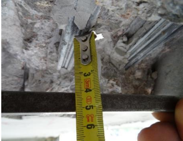
Obr. 127: S NK 19, K5. Minim. krytí kabelu K5 vůči spodnímu povrchu nosníku.
