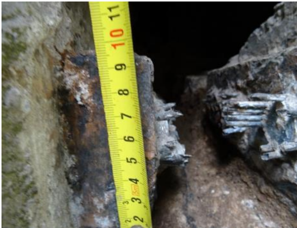
Obr. 93: SNK14 a SNK22. Spodní pravé kotvy kabelů K4–K6 na konci nosníků N10 nad Pi2 po částečném očištění od korozních zplodin.
