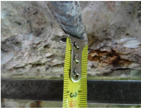
Obr. 33: S ss5 . Měření krycí vrstvy obvod. třmínku ÚP staviva jeho v spodní, vodorovné rovině.
