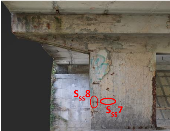
Obr. 5.3-12: Stav levé stojky před provedením sekaných sond. Poloha sond Sss7 a Sss8.
