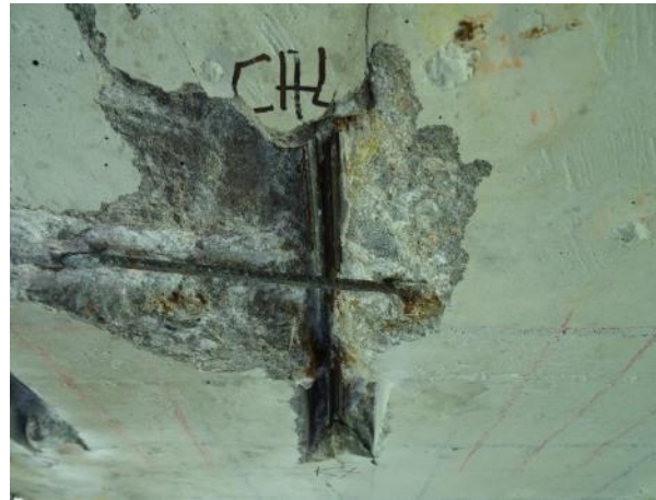
Obr. 58: S NK9 . Obnažené dráty kabelu K7.
