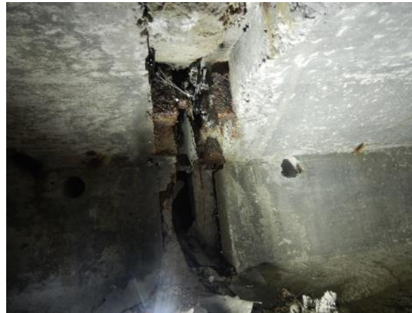
Obr. 40: Konce krajních nosníků N1 nad Pi2 v pohledu směrem k nosníkům N2. Patrná silná koroze horních pravých kotev s kabely K1 – k3.
