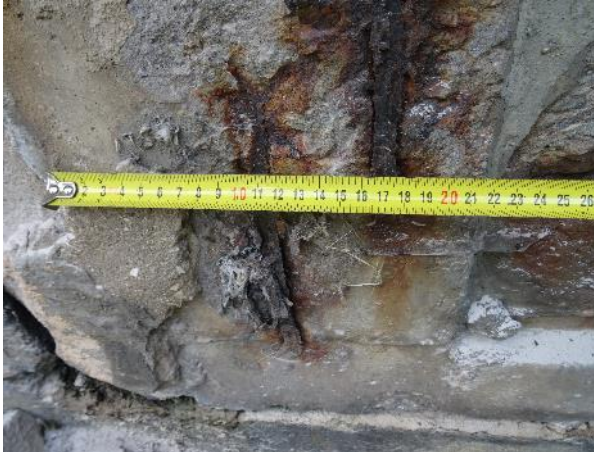
Obr. 79: Konec nosníku N10 nad Op1. Měření polohy obnažené měkké výztuže.
