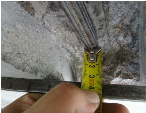
Obr. 27: SNK4, K5. Minim. krytí kabelu K7 vůči spodnímu povrchu nosníku.
