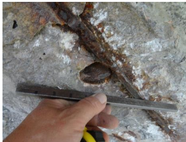
Obr. 144: Krytí měkké výztuže na konci nosníku je nulové. Obnažená část ocel. profilu je korozně zcela strávena.
