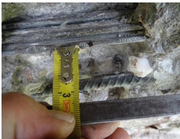
Obr. 137: S NK 21, K3. Na drátech přítomnost korozních zplodin. Minim. krytí kabelu K3 vůči fasádní straně nosníku.
