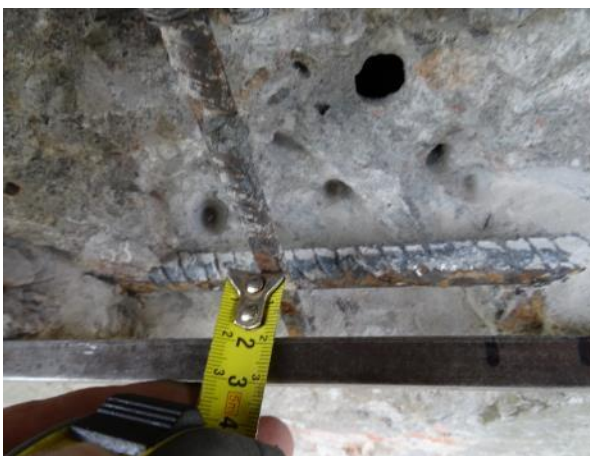
Obr. 11: Měření krytí obnažené svislé výztuže v místě sondy SNK2. Výztuž korozně zasažena na straně minim. krytí.
