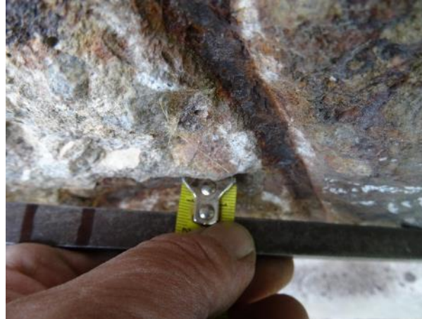
Obr. 80: Konec nosníku N10 nad Op1. Měření minim. krytí korozně napadené výztuže. 50% odkorodování profilu výztuže.
