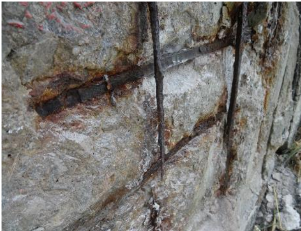
Obr. 15: Fasáda nosníku N1 na konci nad Op1. Plošně odpadá krycí vrstva měkké výztuže.
