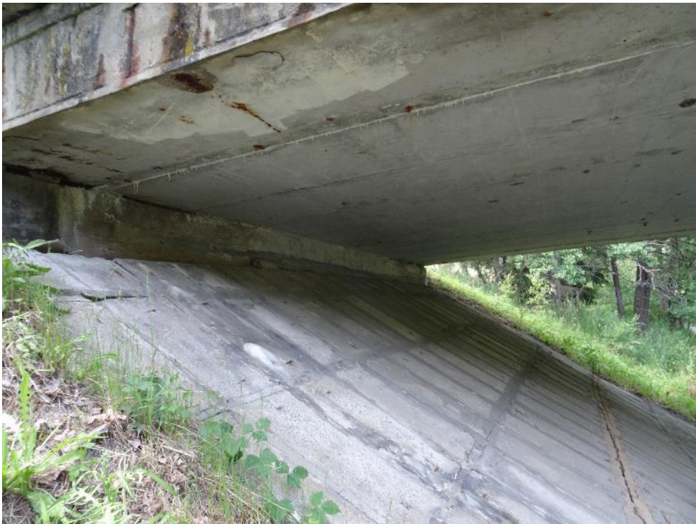
Obr.4.1-16: Op3 v pohledu z povodní strany mostu a zachycená část NK ve 2. poli. Obdoba se závadami v 1. poli. Krajové konce Op zasaženy silnými zátokami. Spáry krajních nosníků po celé délce prosakují (porucha izolace mostovky). Na podhledu NK lokální odsokky krycí vrstvy výztuže nebo koroze již obnažené.
