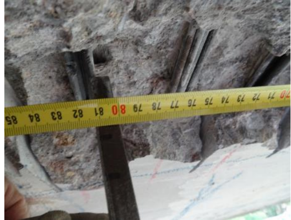
Obr. 122: SNK18, K4. Půdorysná poloha kabelu K4 vztažena k podél. kraji nosníku. Kanálek zaplněn. Přeseknutí jednoho drátu kabelu K4.
