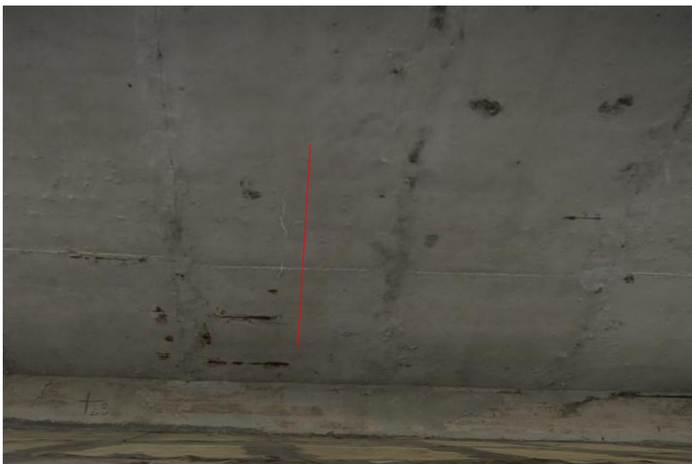
Obr.4.1-17: Podhled NK u Op3. Podkreslena podélná trhlina ve středu N6. Délka trhliny je zvýrazněna bílou stopu výluh.
