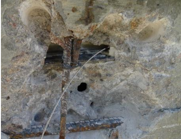
Obr. 7: SNK2, K3. Dráty kabelu s povrch. korozí, kanálek v horní části nezainjektován.
