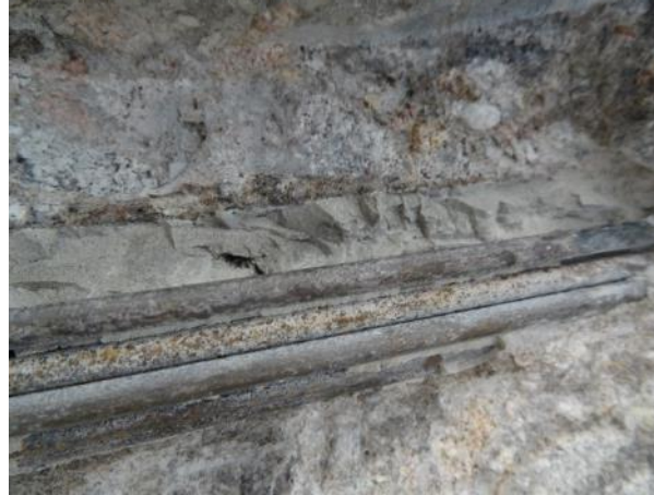
Obr. 26: SNK4, K7. Obnažená část kabelu K5 v bližším pohledu. Dráty zasaženy důlkovou korozí. Kanálek zainjektován.
