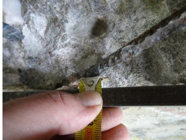
Obr. 152: Měření minimálního krytí obnažené svislé výztuže v místě sondy S NK20 . Na straně minim. krytí je výztuž lokálně strávena korozí s úbytkem cca 40 % své příčné plochy.
