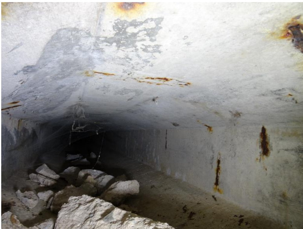
Obr.4.1-23: Pohled do komory krajního nosníku N10 od Pi2 směrem k Op1 (1. pole NK). Lokálně prorýsovaná a korodující měkká výztuž nosníku. Dno komory z části kryté beton. krami – zřejmě pozůstatek z doby výstavby.
