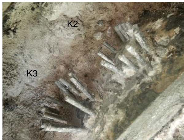
Obr. 66: Sekaná sonda SNK10 – obnažená kotva kabelů K2P, K3P.
