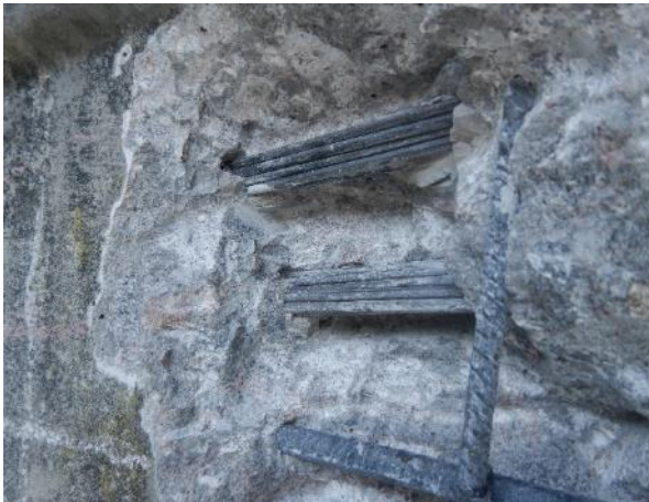
Obr. 99: Sekaná sonda SNK16 s obnaženými kabely K2 a K3 v pohledu ke konci nosníku nad Op3.
