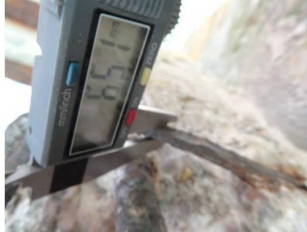
Obr. 44: S ss6 . Zjištěný \varnothing svislé části třmínku.
