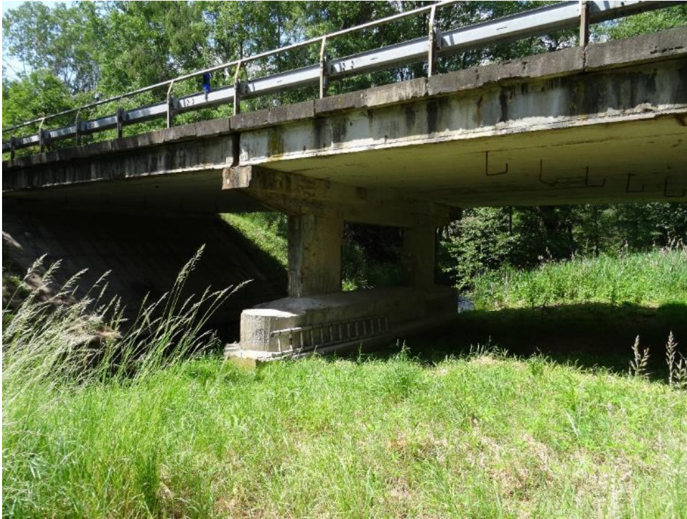
Obr.4.1-1: Levá (povodní) strana mostu v pohledu od Op1. Degradace betonu na fasádní ploše krajních nosníků – mapy intenzivních zátoků do fasády spárami a z pod říms, lokální opad krycí vrstvy výztuže a její koroze. Degradace betonu říms, odpad její spodní okapové hrany, místy obnažená výztuž.
