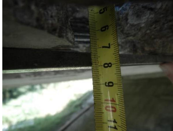
Obr. 20: SNK3, K3. Minim. krytí kabelu K3 vůči spodnímu povrchu nosníku.
