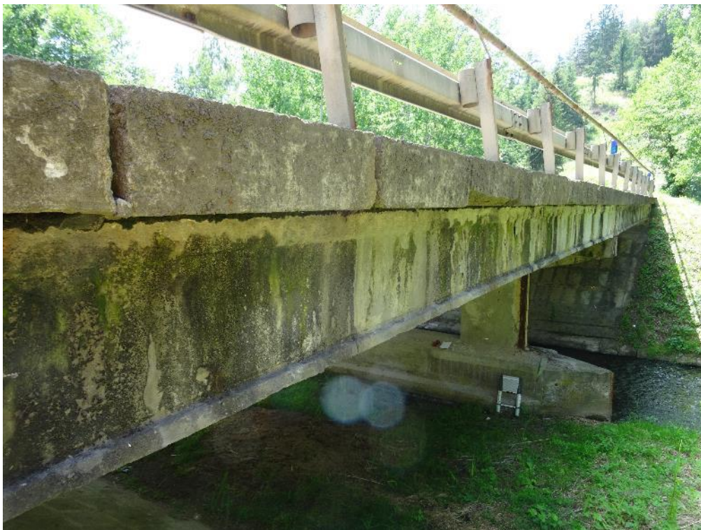
Obr.4.1-25: Pravá (návodní) strana mostu v pohledu od Op1. Vychýlené sloupky svodidla kotvené ve spárách mezi jednotlivými prvky prefa římsy.
