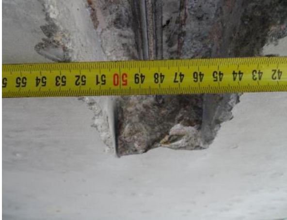
Obr. 25: Pohled nosníku N1, 1,9 m od čela Op1. SNK4, K7. Půdorysná poloha kabelu K7 vztahena k podél. kraji nosníku.
