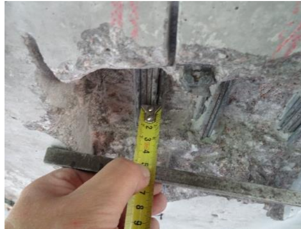
Obr. 44: S NK7 , K4P. Minim. krytí kabelu K4 vůči spodnímu povrchu nosníku.
