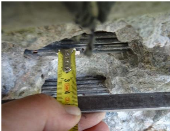
Obr. 135: S NK 20, K2. Minim. krytí kabelu K2 vůči fasádní straně nosníku.
