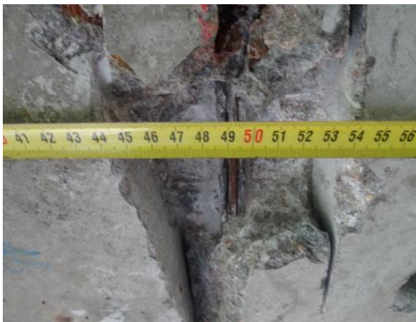
Obr. 47: Podhled nosníku N10, 1,9m od čela Op1. S NK8 , K7. Půdorysná poloha kabelu K7 vztažena k podél. kraji nosníku.
