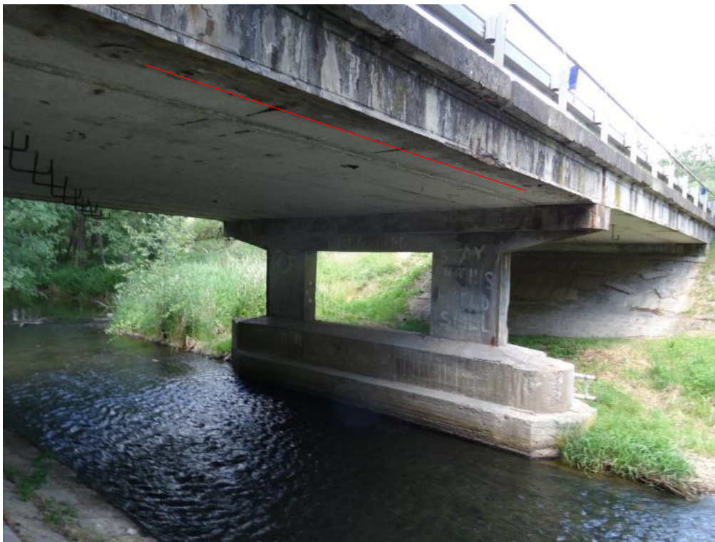
Obr.4.1-13: Pohled 2. pole v pohledu z povodní strany. Zvýrazněn průběh podélné středové trhliliny na pohledu N1. Obdoba s krajními nosníky v 1. poli.
