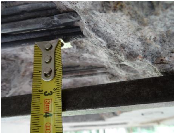
Obr. 123: SNK18, K5. Minim. krytí kabelu K5 vůči spodnímu povrchu nosníku. Na drátech přítomnost korozních zplodin.
