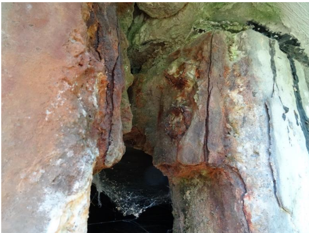
Obr.4.1-21: Konce nosníků N10 1. a 2. pole (nad Pi2) na návodní straně s odhalenými horními kotvami předpínací výztuže. Vrstevnatá koroze kotev, z části odkorodované konce předpínacích drátů.
