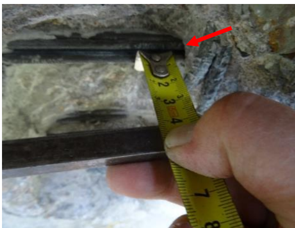
Obr. 71: S NK11 . K2P. Přítomnost korozních zplodin. Kanálek částečně nevyplněn. Minim. krytí kabelu K2 vůči fasádní straně nosníku.
