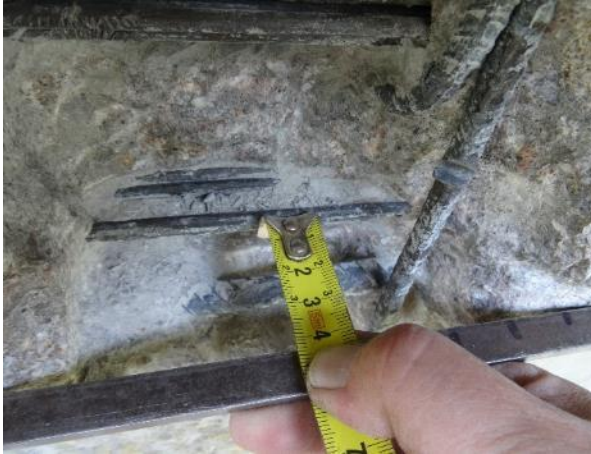
Obr. 73: SNK11. K3P. Přítomnost korozních zplodin. Kanálek vyplněn. Minim. krytí kabelu K3 vůči fasádní straně nosníku
