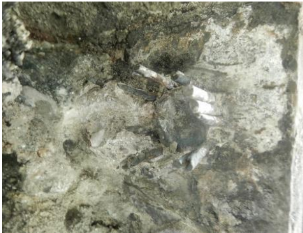
Obr. 141: SNK21. Konce předpínacích drátů kabelu K2 v detailním pohledu. Torza odkorodovaných drátů.
