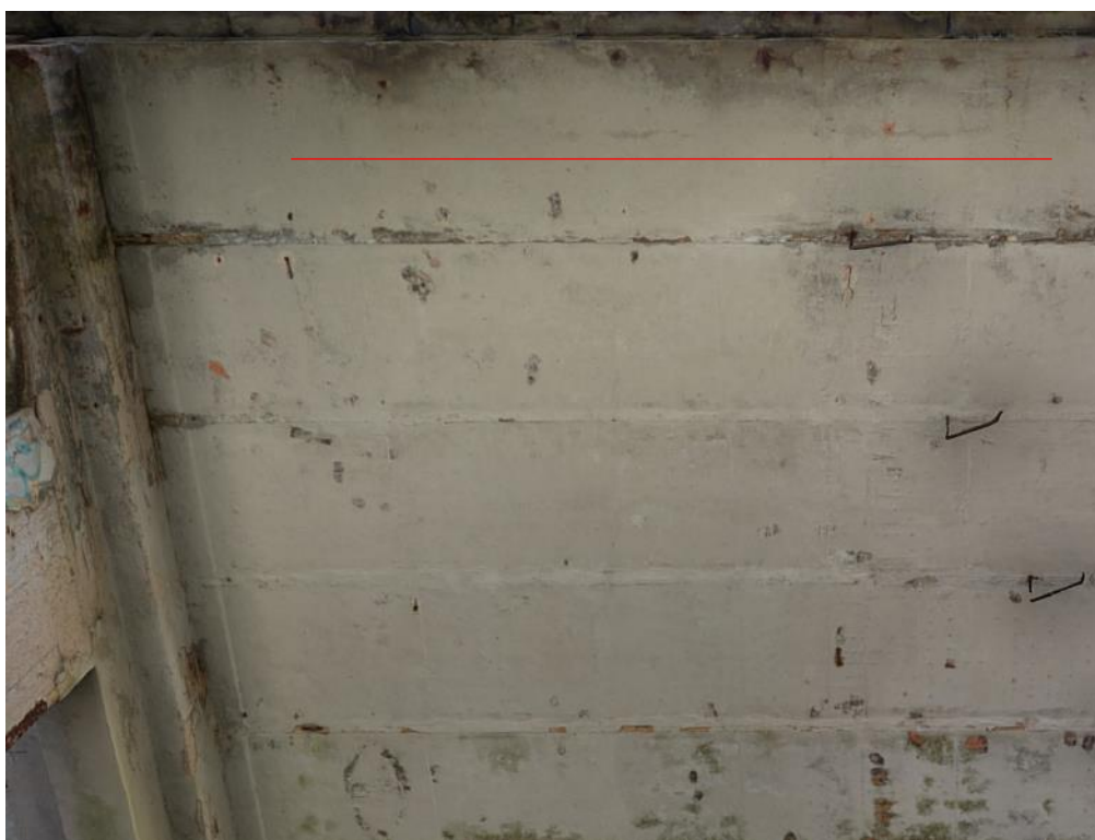
Obr.4.1-6: Podhled nosníků N1–N5 (shora dolů), část u Pi2 v 1. poli. Na N1 podkreslena slabá trhлина zvýrazněna stopou vlhkosti.
