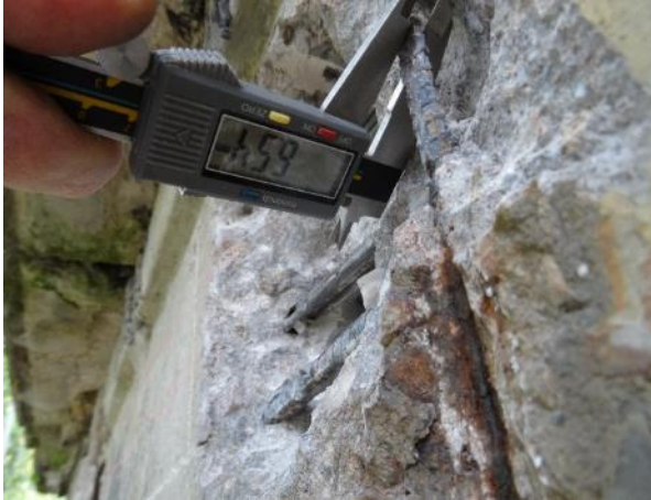
Obr. 151: Měření \varnothing svislé výztuže obnažené v místě sekané sondy S NK20 .
