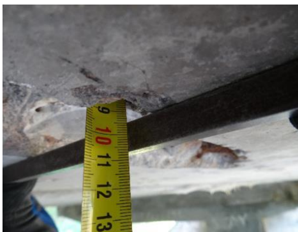
Obr. 107: Změřená tloušťka dna nosníku N1 v místě obnaženého kabelu K7
