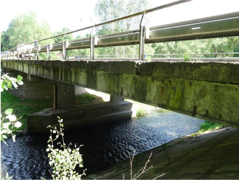
Obr.4.1-19: Pravá (návodní) strana mostu v pohledu od Op3. Degradace betonu na fasádní ploše krajních nosníků – mapy intenzivních zátoků na fasádu spárami a z pod říms, lokální opad krycí vrstvy výztuže a její koroze. Degradace betonu říms, odpad její spodní okapové hrany, místy obnažená výztuž.
