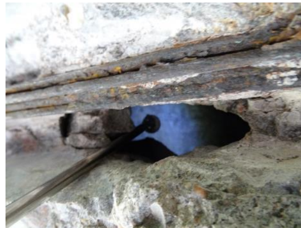
Obr. 106: SNK17, K7. Obnažený kabel K7 v bližším pohledu dále v trase k Op3. Dráty vykazují vrstevnatou korozi. V místě sondy průraz dna nosníku.
