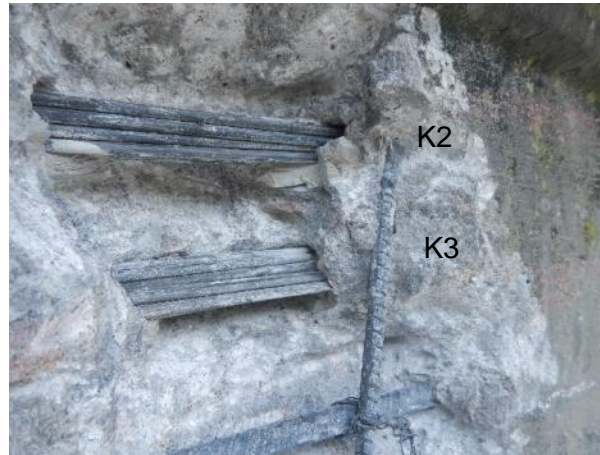
Obr. 98: Sekaná sonda SNK16 s obnaženými kabely K2 a K3 v pohledu ke konci nosníku nad Pi2. Horní část kanálku kabelu K2 není doinjektována.
