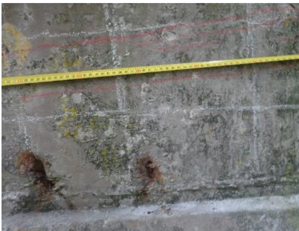
Obr. 167: Fasáda konce nosníku N10 ve 2. poli nad Op3. Měření polohy detekované měkké výztuže (pokračování).
