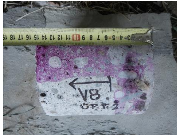
Obr. 5.1-8: Vzorek betonu V8 o \varnothing 150 mm odebraný z horní rozšířené části stativa (úl. práh) v oblasti nad pravou stojkou.
