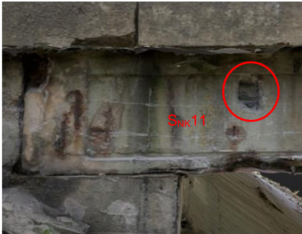
Obr. 69: Konec nosníku N10 nad Op1. Označená poloha sekané sondy S NK11 s obnaženými kabely K2P a K3P..
