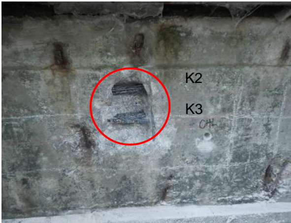
Obr. 153: Fasáda nosníku N10 ve 2. poli 1,2 m od jeho konce nad Op3 Označená poloha sekané sondy S NK23 s obnaženými kabely K2 a K3.
