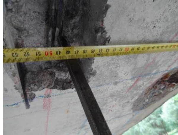
Obr. 116: S NK18 , K7. Půdorysná poloha kabelu K7 vztažena k podél. kraji nosníku. Na drátech přítomnost korozních zplodin. Kanálek zaplněn.
