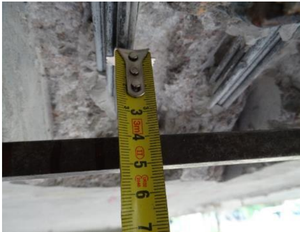
Obr. 129: S NK 19, K6. Minim. krytí kabelu K6 vůči spodnímu povrchu nosníku.
