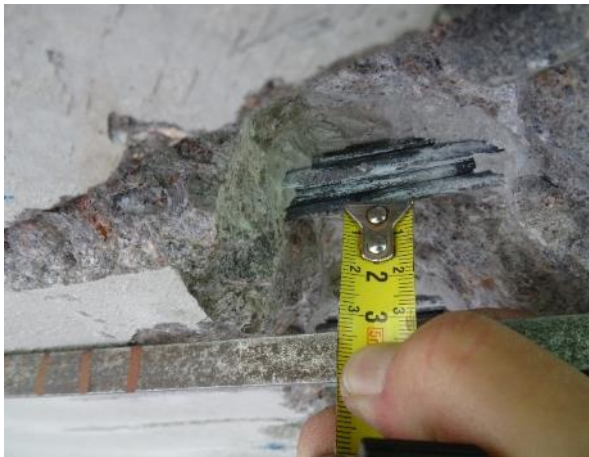
Obr. 51: SNK8, K6. Minim. krytí kabelu K6 vůči spodnímu povrchu nosníku.
