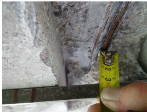
Obr. 48: S NK8 , K7. Na drátech patrná přítomnost korozních zplodin. Minim. krytí kabelu K7 vůči spodnímu povrchu nosníku. –
