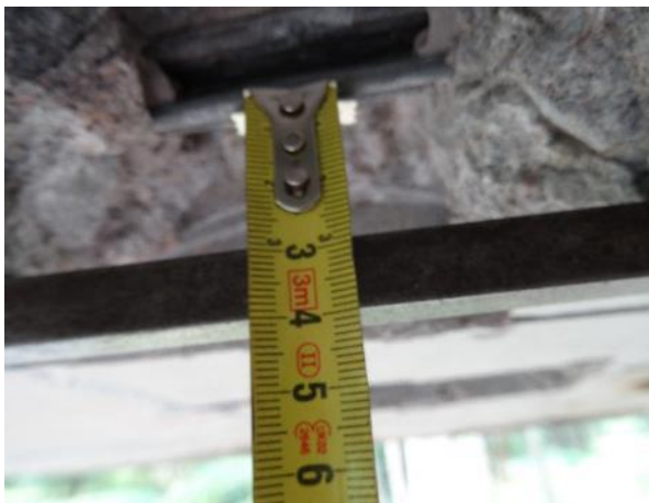
Obr. 119: S NK18 , K6. Minim. krytí kabelu K6 vůči spodnímu povrchu nosníku. Na drátech přítomnost korozních zplodin.
