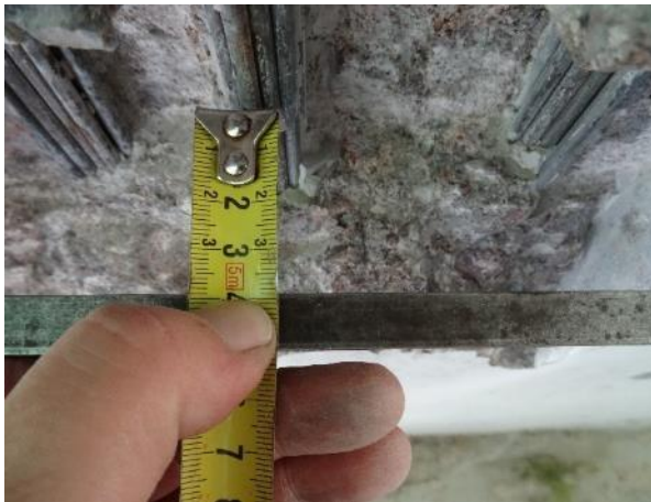
Obr. 45: S NK7 , K5P. Minim. krytí kabelu K5 vůči spodnímu povrchu nosníku.
