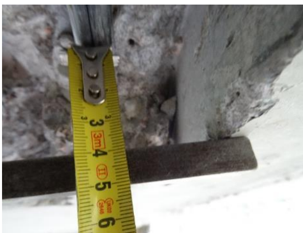
Obr. 125: SNK19, K4. Minim. krytí kabelu K4 vůči spodnímu povrchu nosníku.
