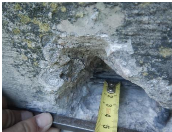
Obr. 84: S NK 12, K3. Minim. krytí kabelu K3 vůči fasádní straně nosníku
