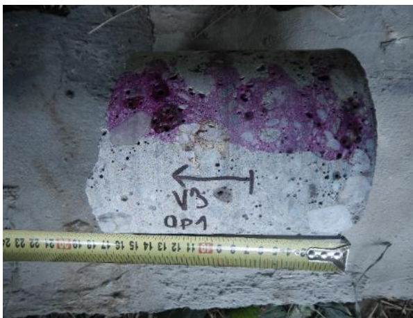
Obr. 5.1-3: Vzorek betonu V3 o \varnothing 150 mm odebraný z Op1.
