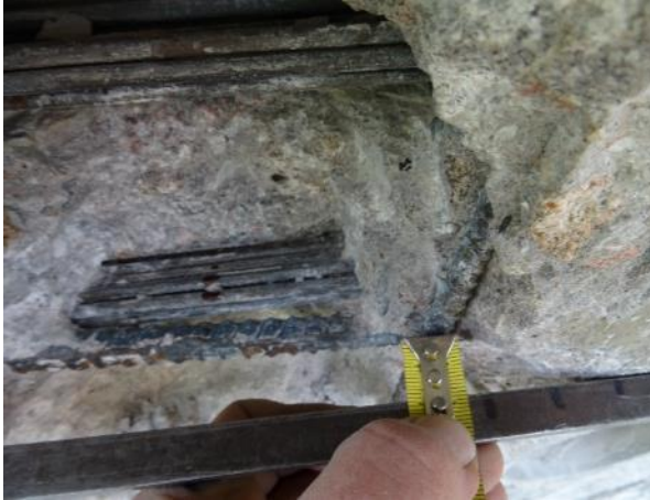
Obr. 163: Měření minim. krytí obnažené měkké Svislé výztuže v místě sondy S NK23 . Výztuž na straně minim krytí korozně zasažena.
