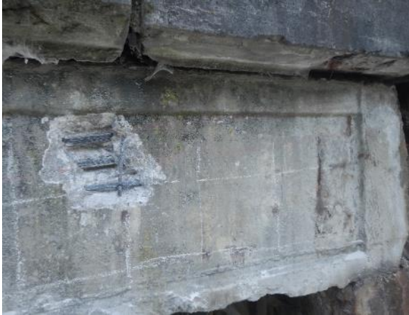
Obr. 97: Fasádní strana nosníku N1 ve 2. poli (P2N1) v místě sekané sondy SNK16 (1,0 m od konce nosníku nad Pi2) Op1, 6,1 m od Pi2.
