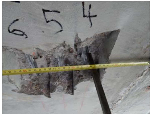
Obr. 124: Podhled nosníku N2 ve 2. poli, 1,5 m od čela Op3 v místě sekané sondy SNK19 s obnaženými kabely K4 – K6. Půdorys. poloha kabelu K4 vztažena k podél. kraji nosníku. Dráty kabelů bez koroze, kanálky zaplněné.
