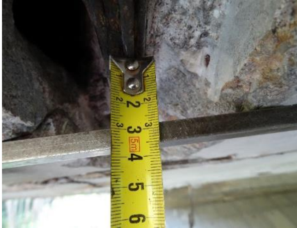
Obr. 109: SNK17, K7. Minim. krytí kabelu K7 vůči spodnímu povrchu nosníku.
