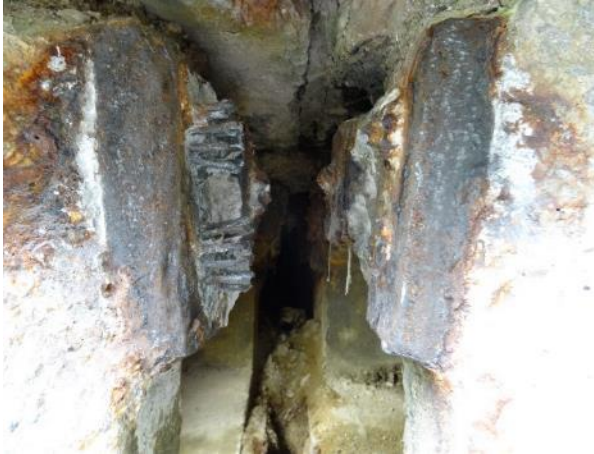
Obr. 91: Stav kotev po částečném očištění od korozních zplodin. Patrná torza odkorodovaných konců drátů kabelů K2 a K3.
