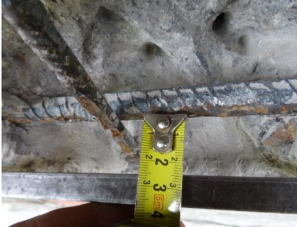
Obr. 13: Měření krytí obnažené vodorovné výztuže v místě sondy SNK2. Výztuž korozně zasažena na straně minim. krytí.
