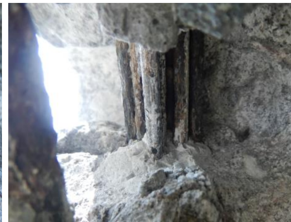
Obr. 18: SNK3, K3 z pohledu. Dráty zasaženy štěrbinovou korozí.
