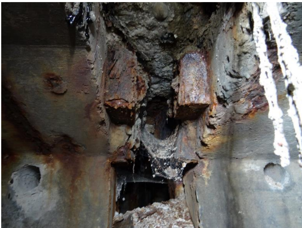
Obr.4.1-22: Konce nosníků N10 1. a 2. pole (nad Pi2) při povodní straně s odhalenými horními kotvami předpínací výztuže. Vrstevnatá koroze kotev, z části odkorodované konce předpínacích drátů. Ve spáře mezi nosníky 1. a 2. pole nános spadlého degradovaného betonu.
