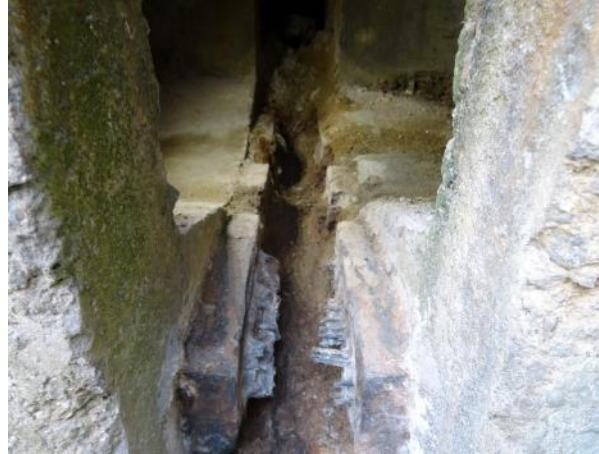
Obr. 92: SNK14 a SNK22. Spodní pravé kotvy kabelů K4–K6 na konci nosníků N10 nad Pi2 po částečném očištění od korozních zplodin.
