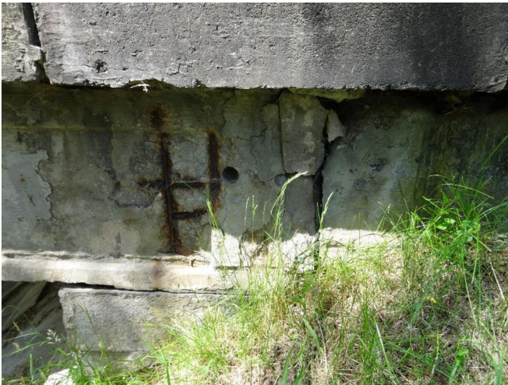
Obr.4.1-2: Konec krajního nosníku N1 (povodní strana) nad Op1. Separace dobetonávky konce nosníku. Na fasádě nosníku odhalená, silně korodující měkká výztuž
