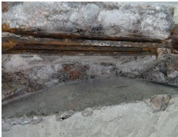
Obr. 105: SNK17, K7. Obnažený kabel K7 v bližším pohledu. Dráty silně korozně napadeny.
