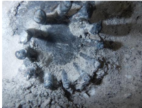
Obr. 4: SNK1. Obnažené dráty kabelu K3.
