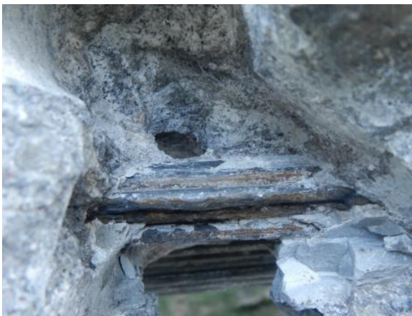
Obr. 17: Fasádní strana N1. SNK3, K3. Dráty zasaženy štěrbinovou korozí.
