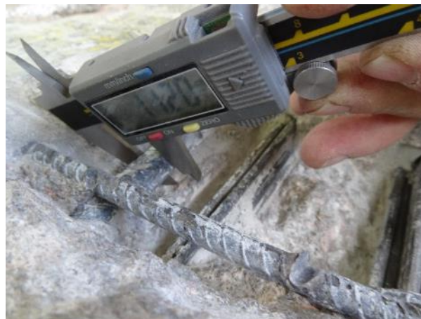
Obr. 78: SNK11. Měření \varnothing obnažené výztuže.
