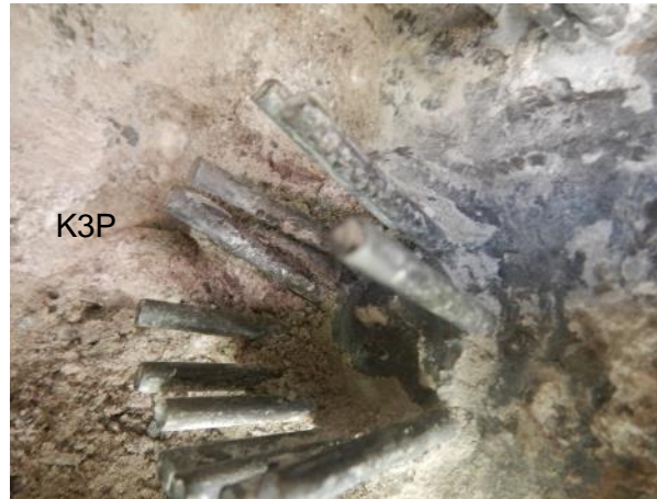
Obr. 68: S NK10 . Obnažené dráty kabelu K3P. Konce drátů bez koroze.
