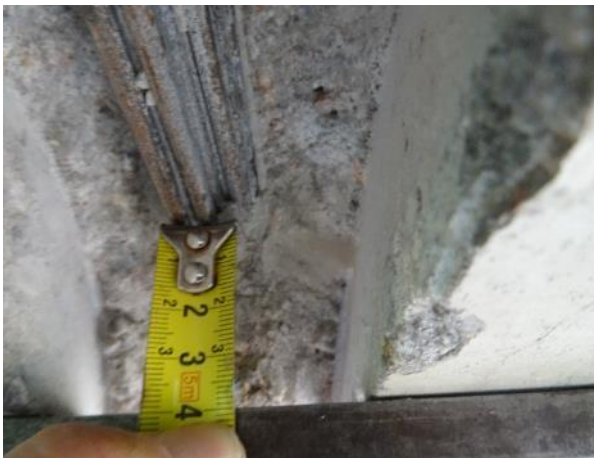
Obr. 23: SNK4, K5. Minim. krytí kabelu K5 vůči spodnímu povrchu nosníku.
