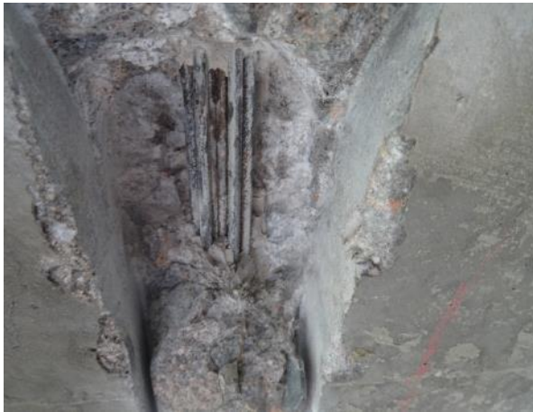
Obr. 111: SNK17, Obnažený kabel K5. Na drátech přítomnost korozních zplodin. Více zasaženy středové dráty.
