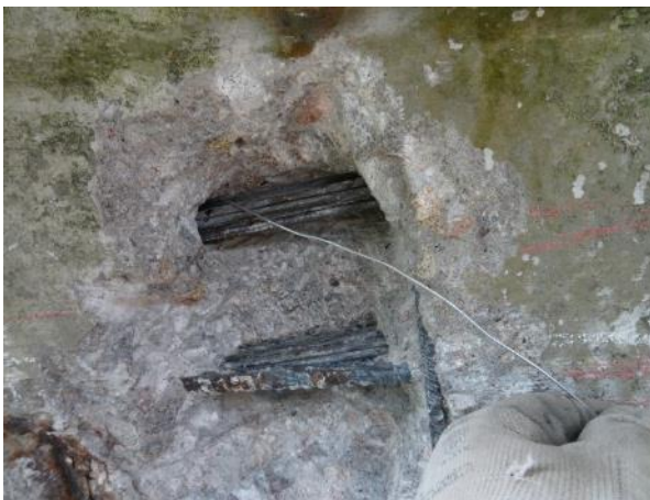
Obr. 155: S NK23 , K2. Měření délky nezainjektovanosti kanálku kabelu K2 směrem ke středu nosníku.
