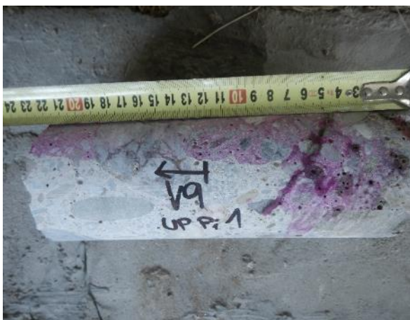
Obr. 5.1-9: Vzorek betonu V9 o \varnothing 100 mm odebraný z horní rozšířené části stativa (úl. práh) v oblasti nad levou stojkou.
