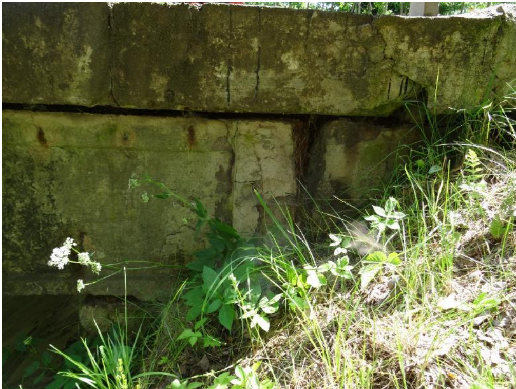
Obr.4.1-20: Konec krajního nosníku N10 (návodní strana) nad Op3. Na konec nosníku zatéká dilatační spárou a z pod římsy. Separace dobetonávky konce nosníku. Na fasádě nosníku lokálně odhalená, korodující měkká výztuž
