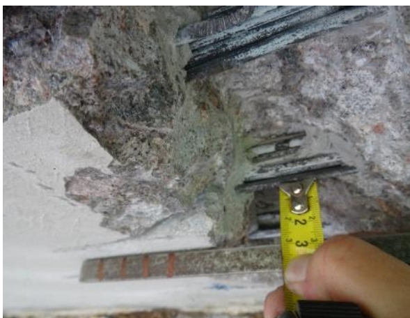
Obr. 53: SNK8, K5. Minim. krytí kabelu K5 vůči spodnímu povrchu nosníku.
