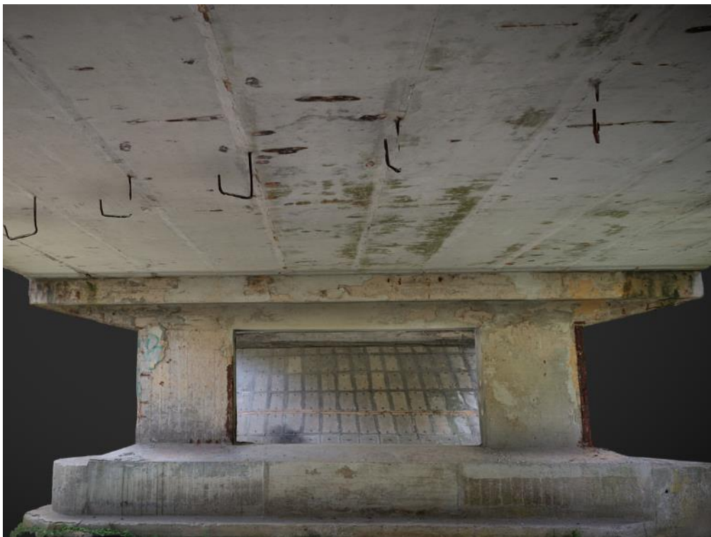
Obr.4.1-7: Středová podpěra (Pi2) v pohledu z 1. mosního otvoru (MO) a zachycená část pohledu NK v 1. poli. Na podpěře odpad sanační omítky, lokální průsaky korozních zplodin, silné zátoky na konzolovitě ukončení stativa. Na pohledu NK lokální prorýsování smykové výztuže a stopy uchycených mikroorganismů.
