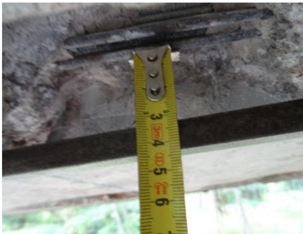
Obr. 117: S NK18 , K7. Minim. krytí kabelu K7 vůči spodnímu povrchu nosníku.
