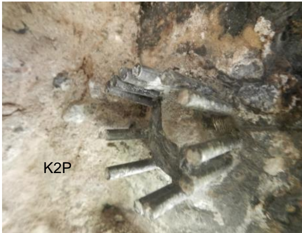
Obr. 67: S NK10 . Obnažené dráty kabelu K2P. Konce drátů bez koroze.
