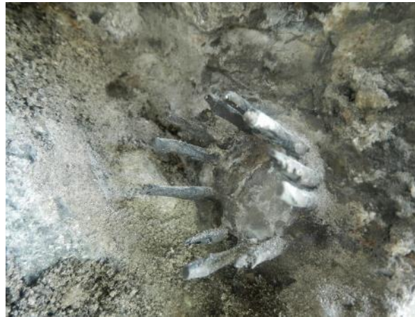
Obr. 142: SNK21. Konce předpínacích drátů kabelu K3 v detailním pohledu. Torza odkorodovaných drátů.
