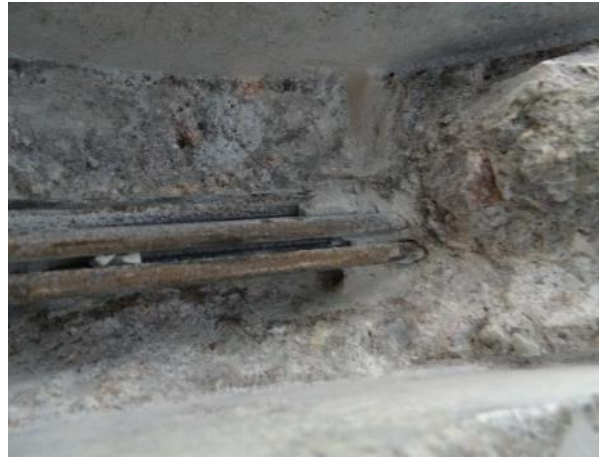
Obr. 22: SNK4, K5. Obnažená část kabelu K5 v bližším pohledu. Dráty zasaženy důlkovou korozí. Kanálek zainjektován.
