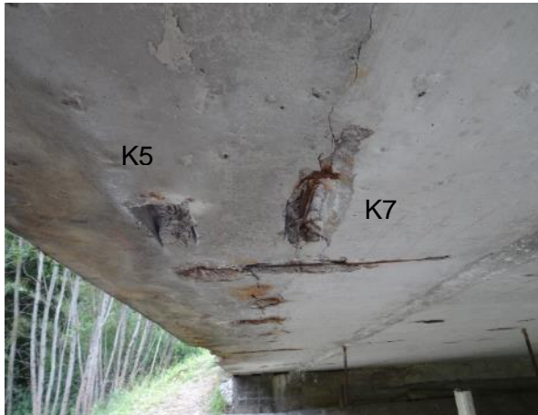
Obr. 103: Pohled nosníku N1 v místě sondy SNK17 (6,0 m od čela Op3, 6,4 m od Pi2). Obnažené kabely K5 a K7.
