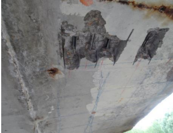
Obr. 115: Podhled nosníku N1 ve 2. poli, 1,5 m od čela Op3 v místě sondy S NK18 . Obnažené kabely K4P–K6P a K7.
