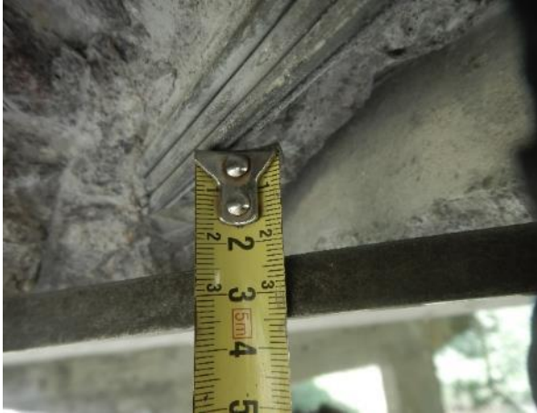
Obr. 37: S NK5 , K6. Minim. krytí kabelu K6 vůči spodnímu povrchu nosníku.
