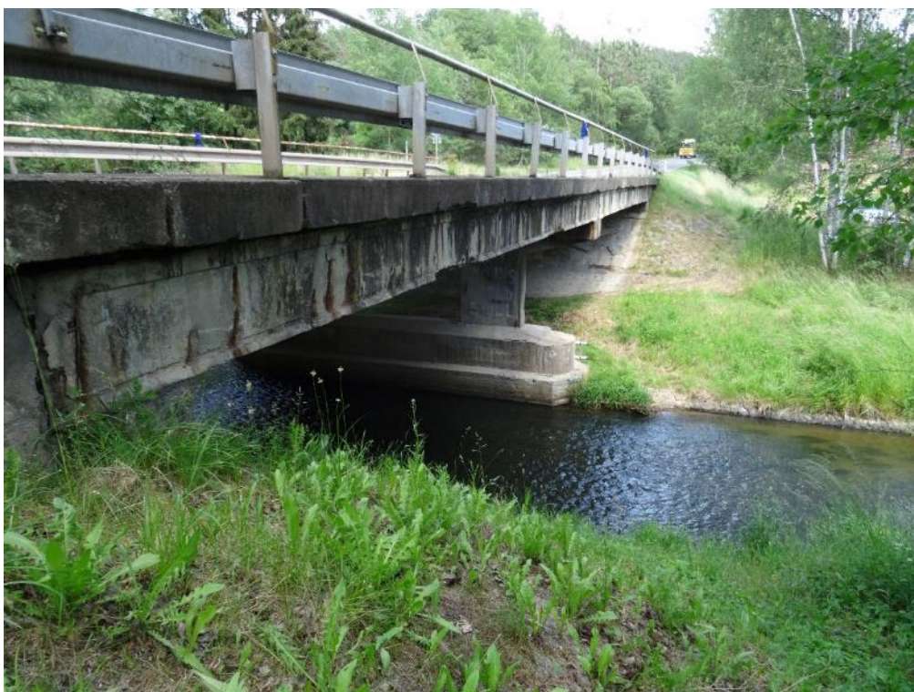
Obr.4.1-14: Levá (povodní) strana mostu v pohledu od Op3. Degradace betonu na fasádní ploše krajních nosníků – mapy intenzivních zátok do fasády spárami a z pod říms, lokální opady krycí vrstvy výztuže a její koroze. Lokální odpad zesílené spodní hrany krajního nosníku. Degradace betonu říms, odpad její spodní okapové hrany, místy obnažená výztuž.
