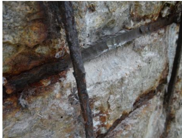
Obr. 16: Obnažená výztuž ke překorodovaná nebo z části odkorodovaná.
