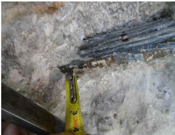
Obr. 161: Měření minim. krytí obnažené měkké vodorovné výztuže v místě sondy SNK23. Výztuž na straně minim krytí korozně zasažena.
