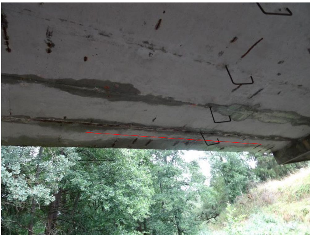
Obr.4.1-18: Podhled NK ve 2. poli s nosníky N7–N10. Na podhledu krajního nosníku (N10) podélná trhlina. (zvýrazněna čarou). Obdoba s ostatními krajními nosníky. Silné průsaky zátoků spárami mezi nosníky.
