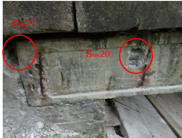
Obr. 130: Konec nosníku N1 nad Op3 (2. pole). Označená poloha sekané sondy S NK 20 a S NK 21.
