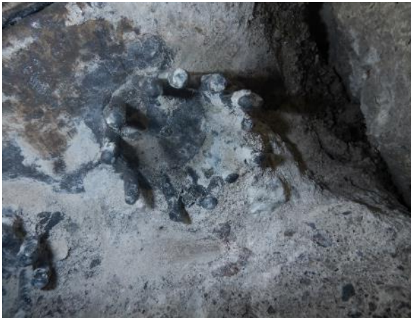
Obr. 3: SNK1. Obnažené dráty kabelu K2.
