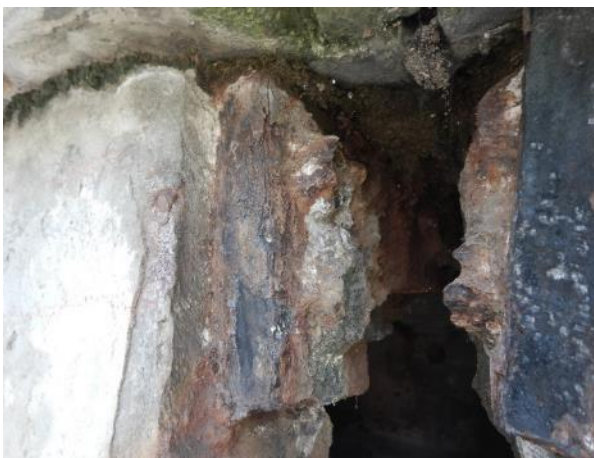
Obr. 95: SNK15. Konec nosíku N1 nad Pi2 ve 2. poli. Horní kotva kabelů předpětí K2 a K3. Stav po částečném očištění vrstevnaté koroze na kotvě. Konce drátů překryty pozůstatky krycí obetonávky, kterou prostupují korozní zplodiny.
