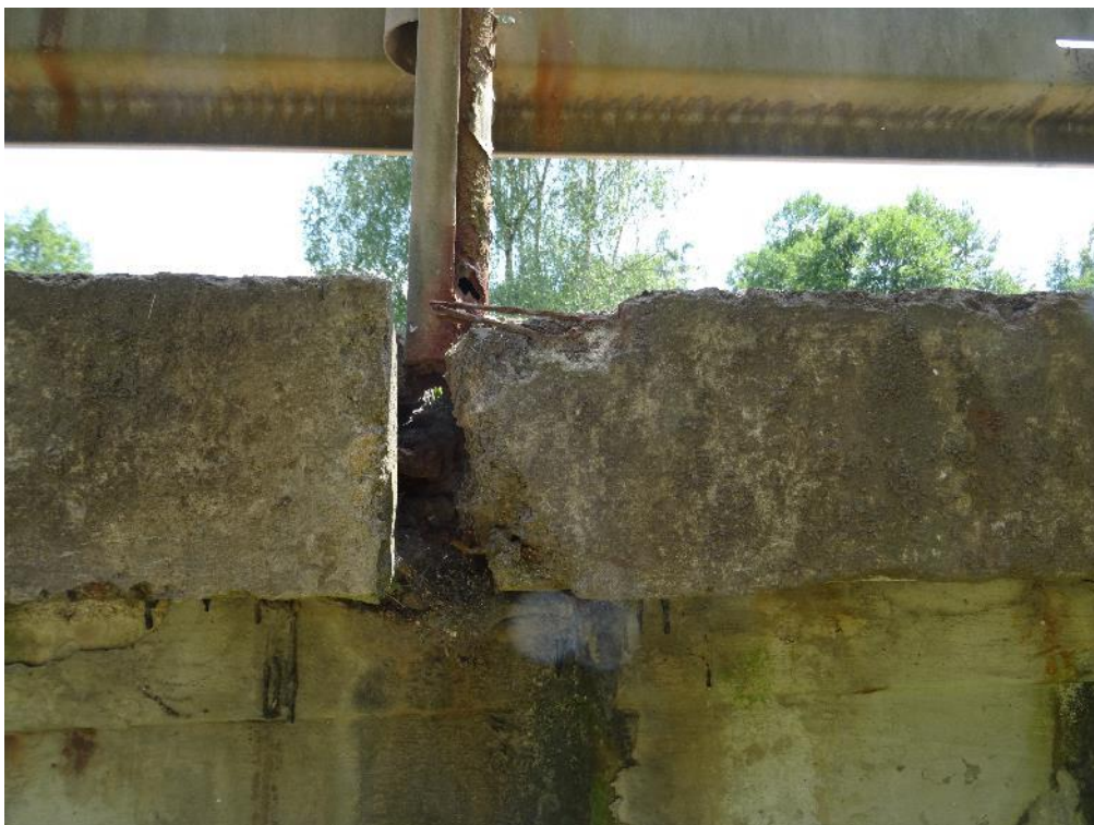
Obr.4.1-26: Zcela nevyhovující stav ukotvení sloupku svodidla ve spáře mezi prefa římsami. Odkorodování kotevní části sloupku svodidla, rozpad betonu římsy v místě spáry.
