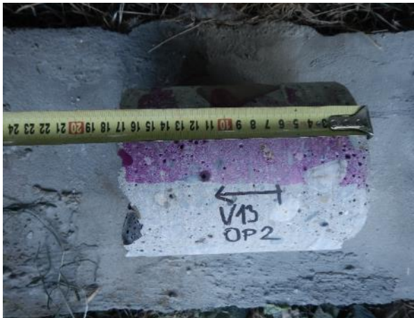
Obr. 5.1-13: Vzorek betonu V13 o \varnothing 150 mm odebraný z Op3.
