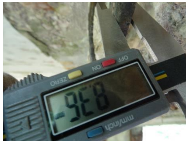
Obr. 48: S ss6 . Zjištěný \varnothing koutové rozděl. výztuže.
