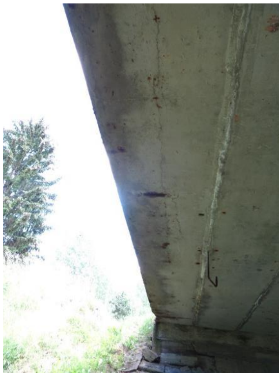
Obr.4.1-5: Pravý (návodní) krajní nosník (N10) v 1.poli. Zřetelná podélná středová trhлина v pohledu nosníku v místě předpokládané trajektorie kabelu předpínací výztuže.
