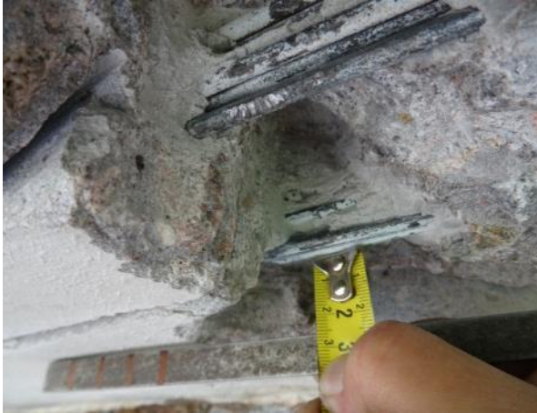
Obr. 55: S NK8 , K4. Minim. krytí kabelu K4 vůči spodnímu povrchu nosníku.
