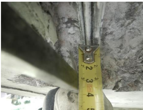
Obr. 35: SNK5, K4. Minim. krytí kabelu K4 vůči spodnímu povrchu nosíku.
