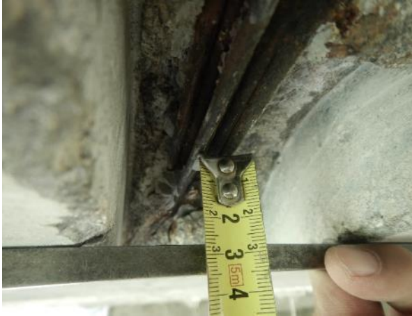
Obr. 61: SNK9, K7. Minim. krytí kabelu K5 vůči spodnímu povrchu nosníku.
