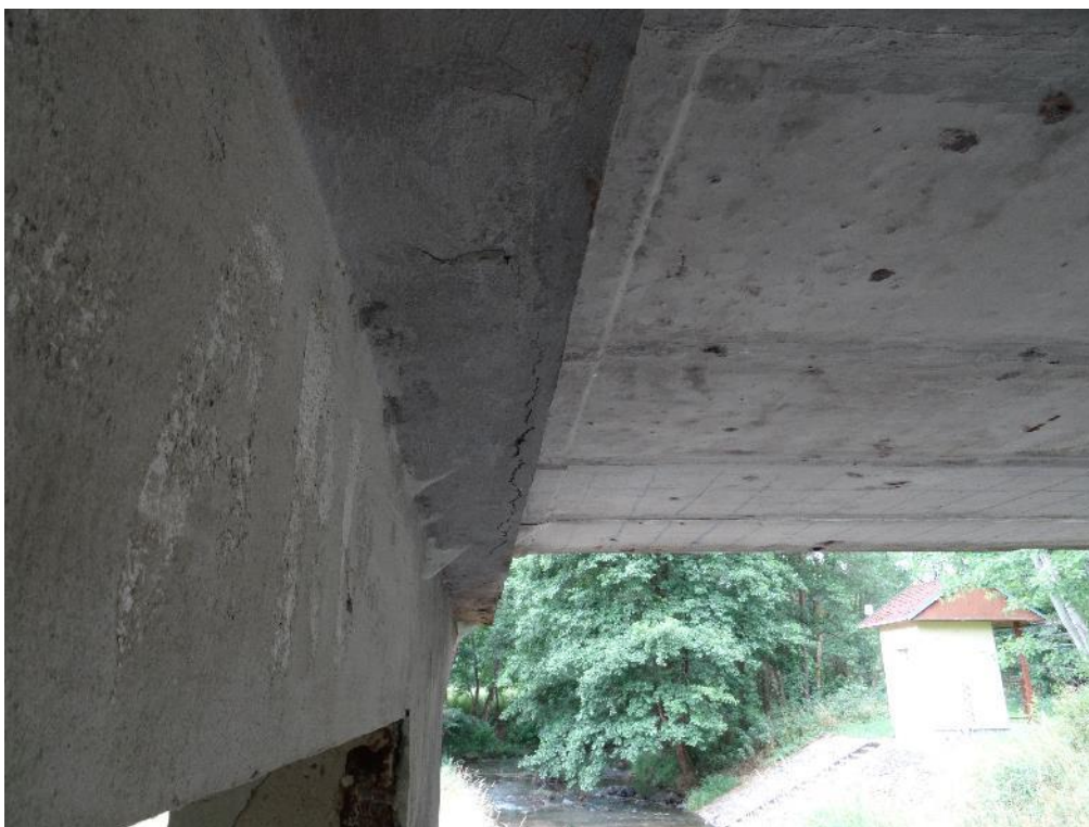
Obr.4.1-12: Pi2 ze strany 2. MO v pohledu z návodní strany mostu. Trhlina na pohledu rozšířené části úložného prahu (ÚP) stativa v místě mezi stojkam. Separace krycí vrstvy výztuže.
