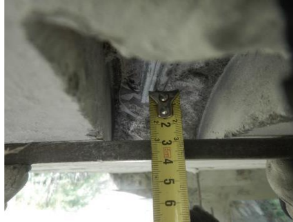
Obr. 38: S NK5 , K7. Minim. krytí kabelu K7 vůči spodnímu povrchu nosníku.
