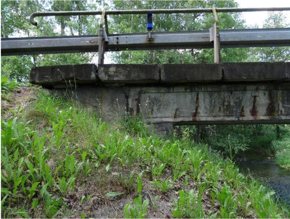
Obr.4.1-15: Konec krajního nosníku N1 (povodní strana) nad Op3. Degradace betonu na fasádní ploše krajních nosníků – mapy intenzivních zátoků do fasády spárou mezi prefa římsami, lokální opady krycí vrstvy výztuže a její koroze. Lokální odpad zesílené spodní hrany krajního nosníku. Degradace betonu říms, spáry mezi prefa římsami bez spárování, sloupky svodidla kotvené ve spárách říms jsou uvolněné.
