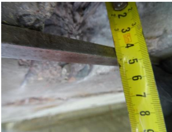
Obr. 113: SNK17, K5. Minim. krytí kabelu K5 vůči spodnímu povrchu nosníku.
