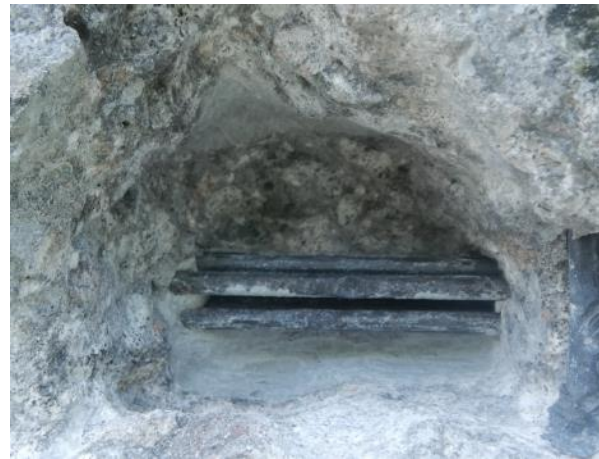
Obr. 82: Sekaná sonda S NK 12, K3. Obnažené dráty kabelu K3. Dráty kroupenaté bodovou korozí. Kanálek zainjektován.
