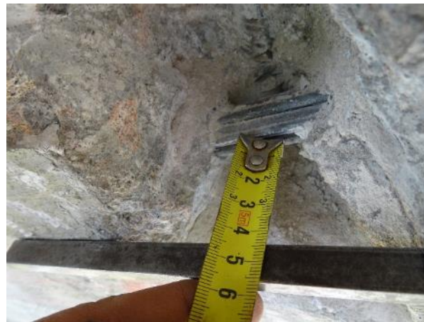
Obr. 6: SNK2, K2. Dráty kabelu bez koroze, kanálek zainjektován.
