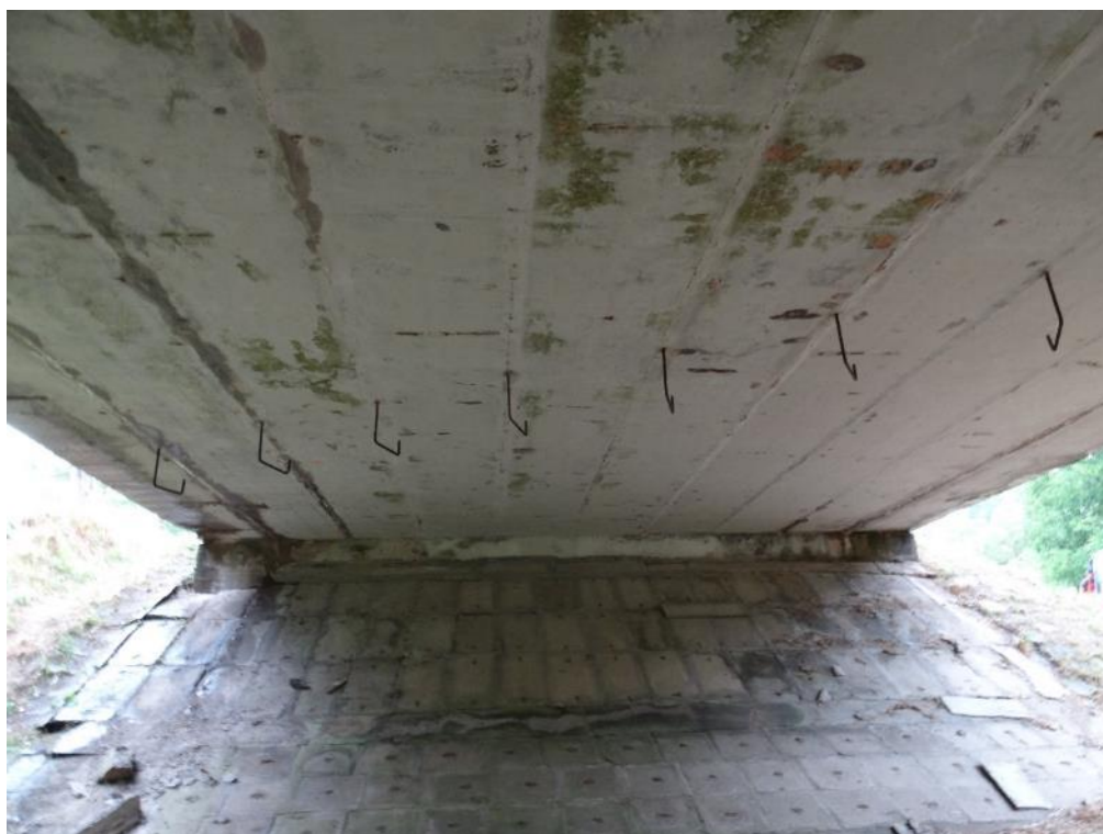
Obr.4.1-4: Opěra 1 (Op1) a zachycená část podhledu NK v 1 poli. Krajové konce Op1 zasaženy silnými zátokami přes dilatační spáru konce NK nad Op a spárami mezi krajními nosníky. Spáry krajních nosníků po celé délce prosakují (porucha izolace mostovky).
