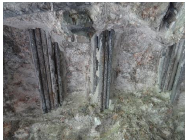
Obr. 42: S NK7 , K4P – K6P. Obnažené kabely K4 – K6 v bližším pohledu. Na drátech přítomnost korozních zplodin.
