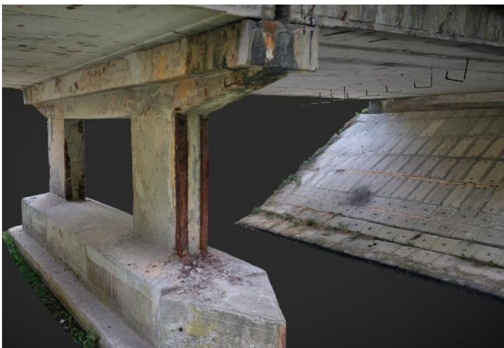
Obr.4.1-10: Pi2 v pohledu z pravé (návodní) strany mostu. Kozolovitá část Pi2 zasažena silnými zátoky přes dilatační spáru mezi poli NK. Degradace betonu, odpad krycí vrstvy výztuže, její koroze.
