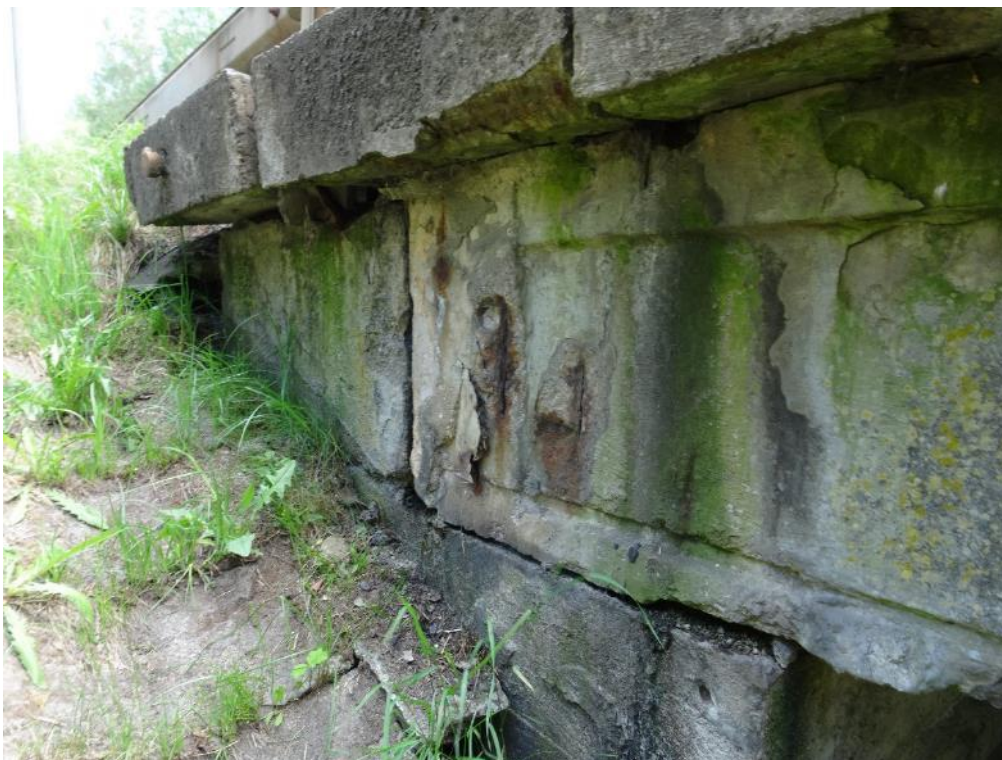
Obr.4.1-3: Konec krajního nosníku N10 (návodní strana) nad Op1. Degradace betonu na fasádní ploše krajních nosníků – mapa intenzivních zátoků do fasády spárou mezi prefa římsami, lokální opad krycí vrstvy výztuže a její koroze. Lokální odpad zesílené spodní hrany krajního nosníku. Degradace betonu říms, odpad její spodní okapové hrany.
