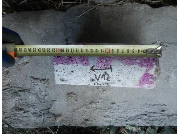
Obr. 5.1-12: Vzorek betonu V12 o \varnothing 100 mm odebraný z Op3.
