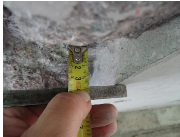
Obr. 46: S NK7 , K6P. Minim. krytí kabelu K6 vůči spodnímu povrchu nosníku.
