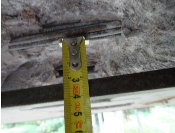
Obr. 121: SNK18, K5. Minim. krytí kabelu K5 vůči spodnímu povrchu nosníku. Na drátech přítomnost korozních zplodin.
