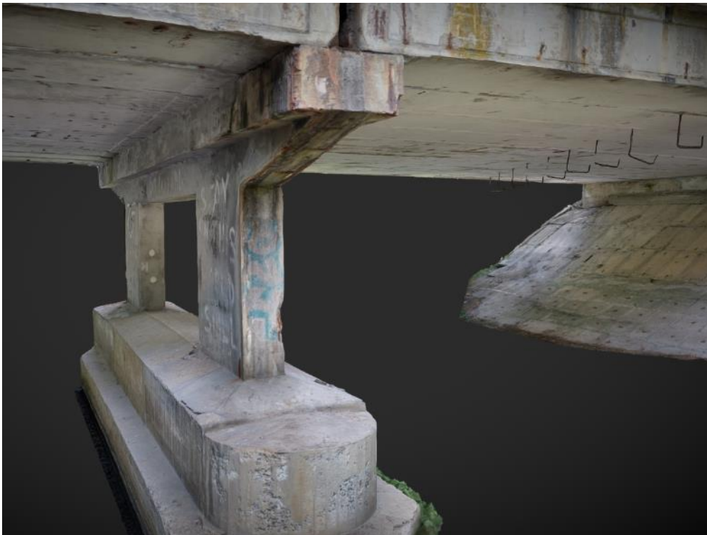
Obr.4.1-9: Pi2 v pohledu z levé (povodní) strany mostu. Kozolovitá část Pi2 zasažena silnými zátoky přes dilatační spáru mezi poli NK. Degradace betonu, odpad krycí vrstvy výztuže, její koroze.
