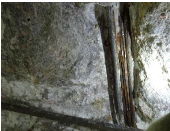
Obr. 59: S NK9 . Obnažené dráty kabelu K7 v bližším pohledu. Zjištěná štěrbinová koroze na středních drátech svazku kabelu.
