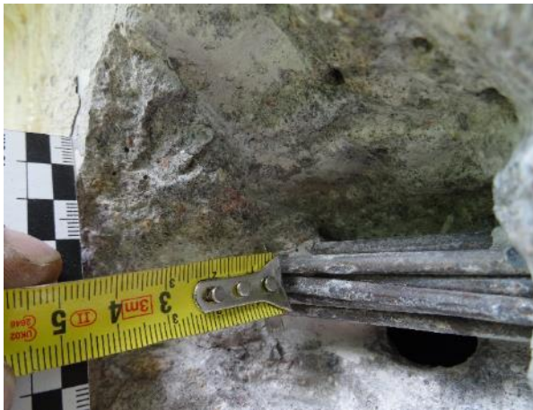
Obr. 87: Na drátech přítomnost korozních zplodin, místy koroze štěrbinová. Změřené minim. krytí kabelu K3 vůči fasádní straně nosníku.
