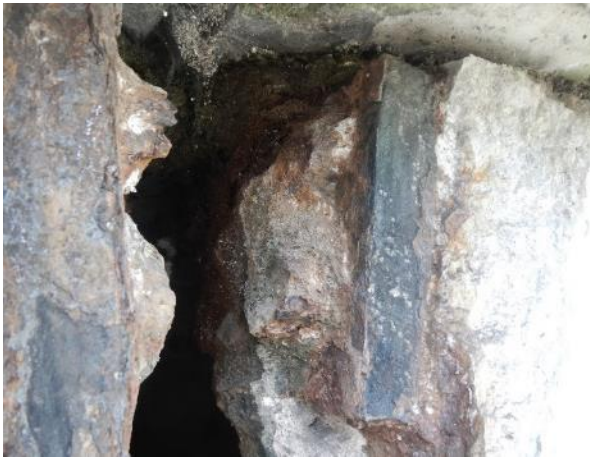
Obr. 39: S NK6 . Konec nosníku N1 nad Pi2 v 1. poli. Horní kotva kabelů předpětí K2 a K3. Stav po částečném očištění vrstevnaté koroze na kotvě. Konce drátů překryty pozůstatky krycí dobetonávky. Prostup korozních zplodin dobetonávky.
