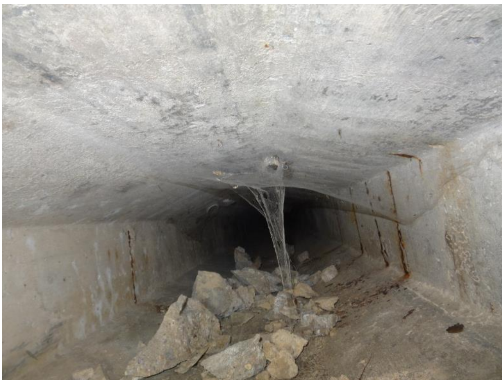
Obr.4.1-24: Pohled do komory krajního nosníku N10 od Pi2 směrem k Op3 (2. pole NK). Lokálně prorýsovaná a korodující měkká výztuž nosníku. Dno komory z části kryté beton. krami – zřejmě pozůstatek z doby výstavby.
