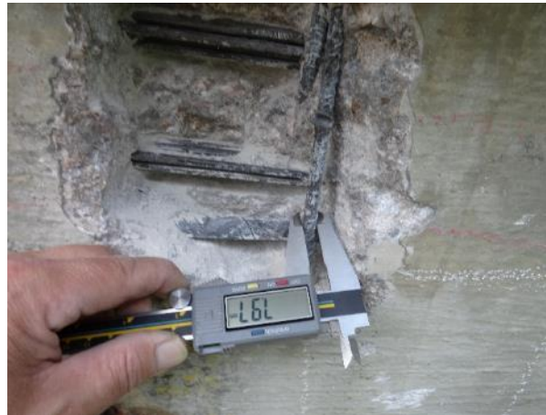
Obr. 76: SNK11. Měření \varnothing obnažené výztuže.
