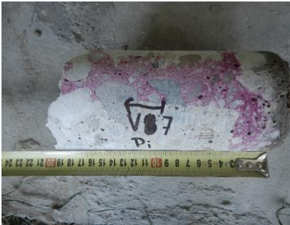
Obr. 5.1-7: Vzorek betonu V7 o \varnothing 100 mm odebraný ze spodní části stativa v oblasti mezi stojkami.
