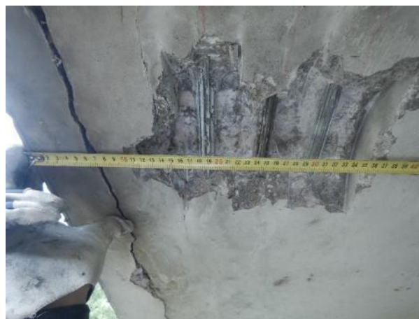
Obr. 30: SNK5, K4 – K6. Obnažené kabely v bližším pohledu. K5 s povrchovou korozí.
