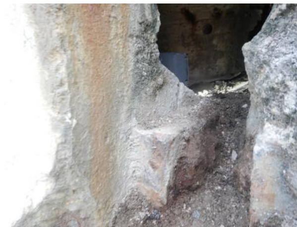
Obr. 96: Levá spodní kotva (s K4–K6) na konci nosíku N1 nad Pi2 ve 2. poli. Obetonávka kotvy (konců drátů kabelů) takřka strávena. Prostup koroz. zplodin, předpokl. silné koroze konců drátů.
