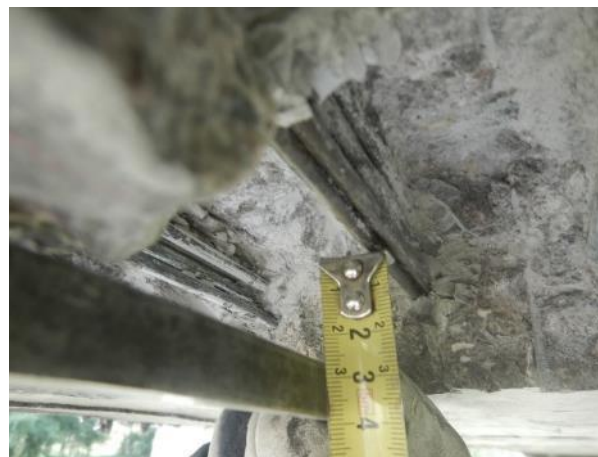
Obr. 36: SNK5, K5. Minim. krytí kabelu K5 vůči spodnímu povrchu nosíku.
