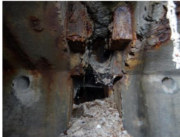
Obr. 94: Mezi nosíky N10 nad Pi2. Koroze kotev, konce drátů nechráněny obetonávkou, přítomnost vlhkosti, mezi nosíky nánosy degrad. materiálu.
