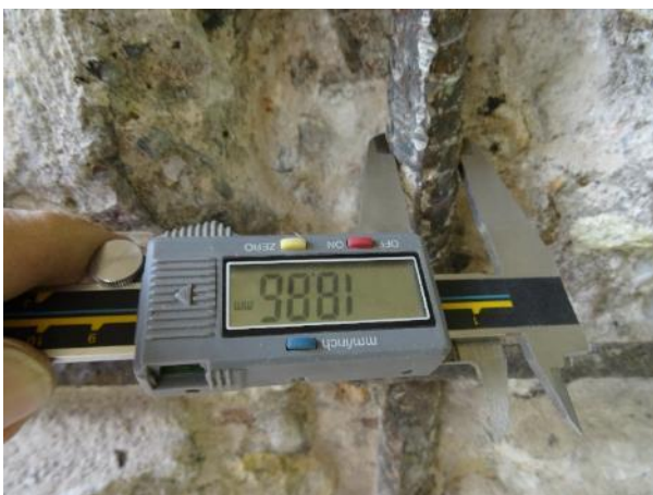
Obr. 5.3-17: Sss8. Zjištěný \varnothing svislé výztuže.
