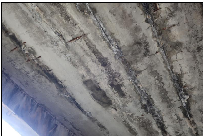
podhled NK trhliny na spodním líci, separace krycí vrstvy nad korodující výztuží
