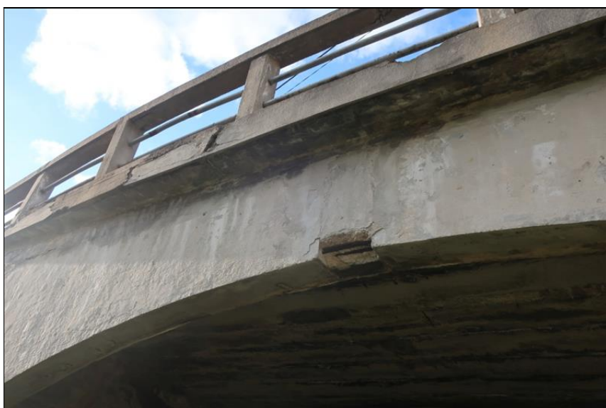
obnažená korodující výztuž pravé plentovací zdi v místě odpadlé krycí vrstvy
