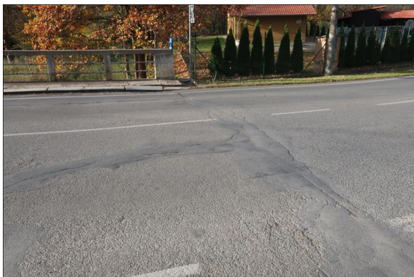
příčná trhlina v krytu vozovky za O2
