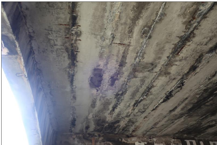
podhled NK lokálně korodující konstrukční výztuž na spodním líci nosníků
