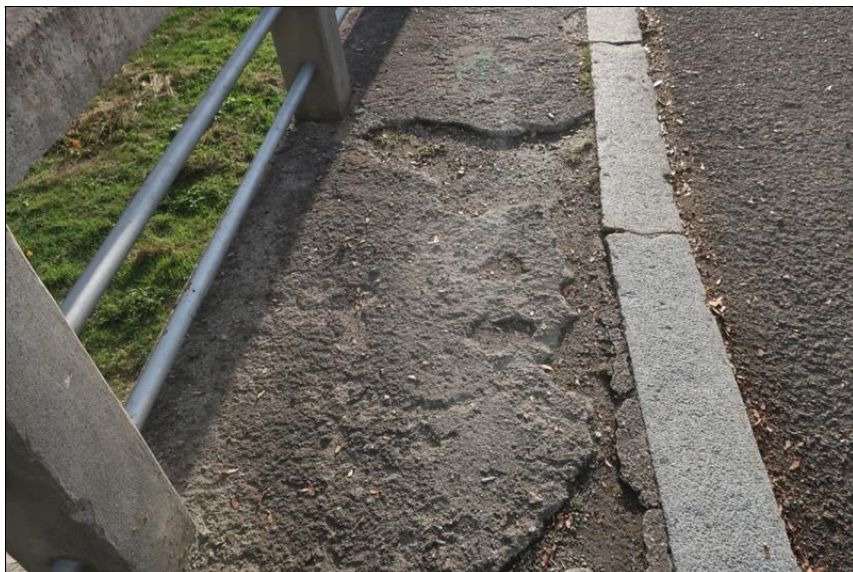
degradace krytu pravého chodníku
