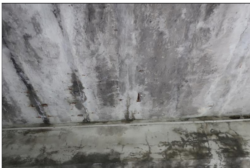
obnažená korodující nosná výztuž
