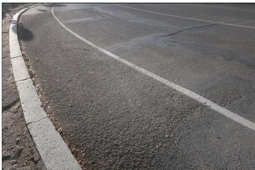
degradace krytu vozovky
