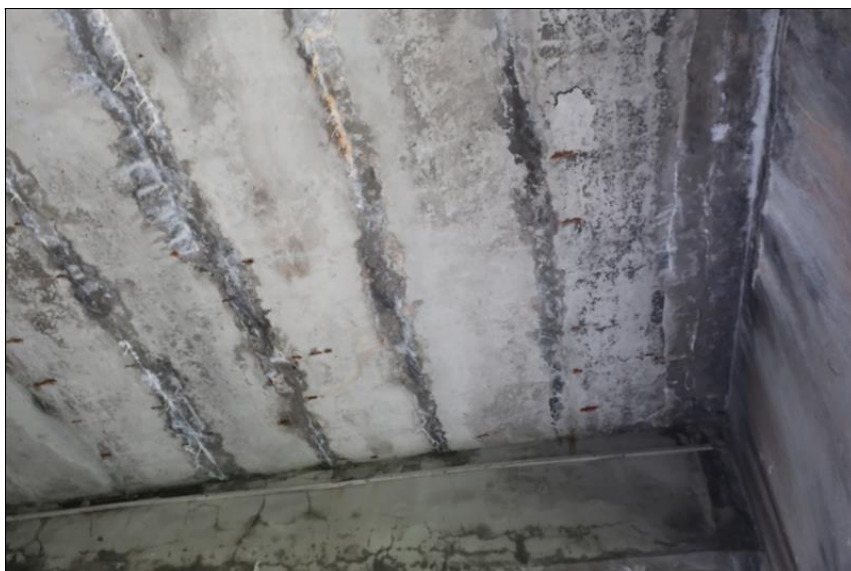
drobné stopy po průsacích s výluhy pojiva v místech spar mezi nosníky
