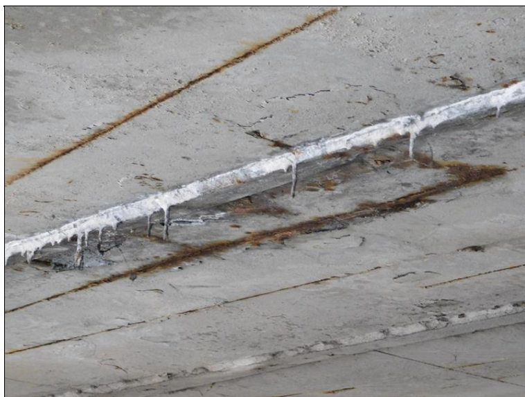
Průsaky nosnou konstrukcí
