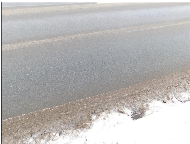
Trhliny v krytu vozovky
