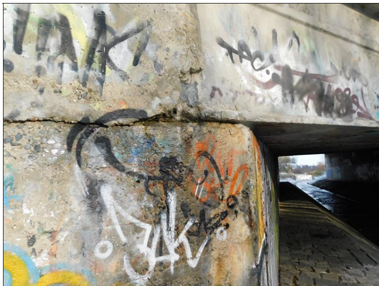
Detail zatékání na levé straně Op2
