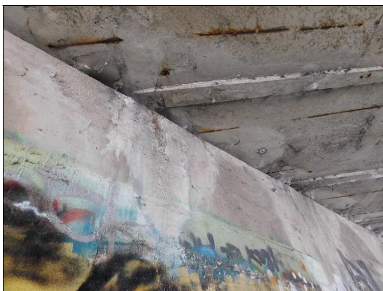
Průsaky nosnou konstrukcí
