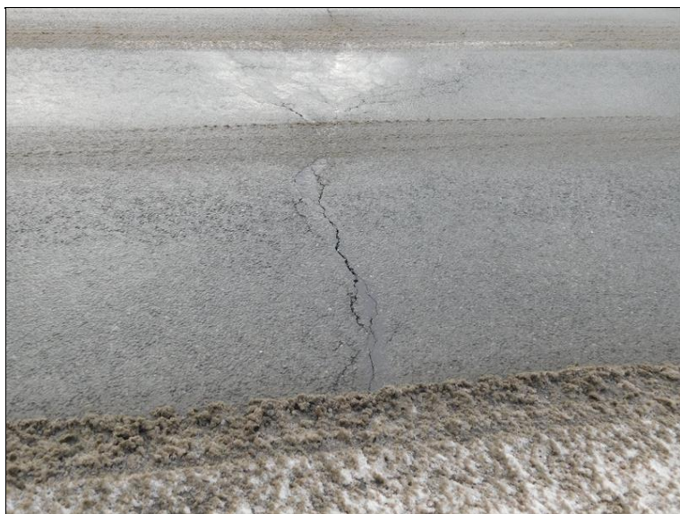
Příčné trhliny v krytu mostovky
