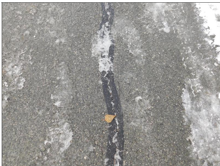
Trhlina v krytu chodníku
