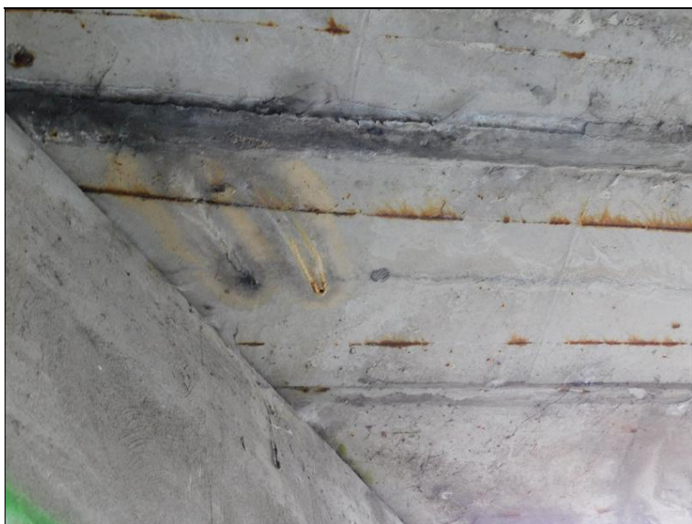
Průsaky na spodním líci konstrukce
