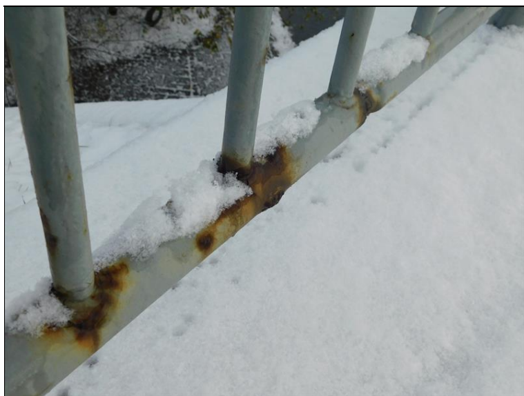
Detail stavu zábradlí
