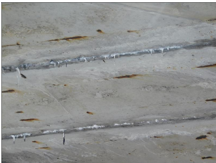
Průsaky spárami na spodním líci konstrukce
