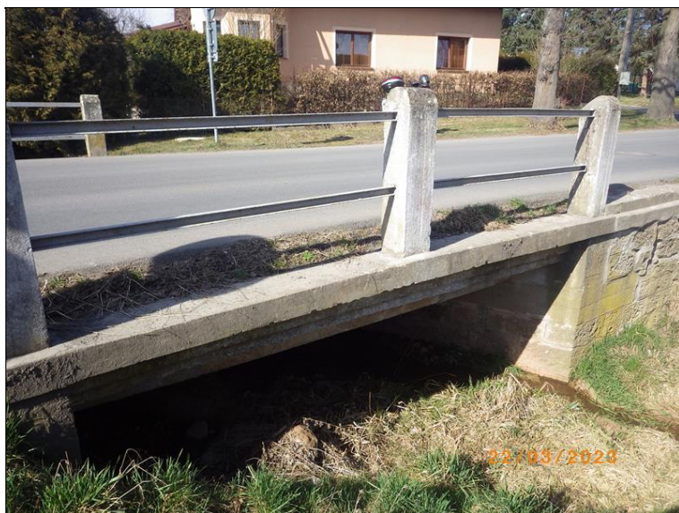
Pohled na most zprava, výrazné několikeré převýšení vrstev vozovky nad úroveň římsy
