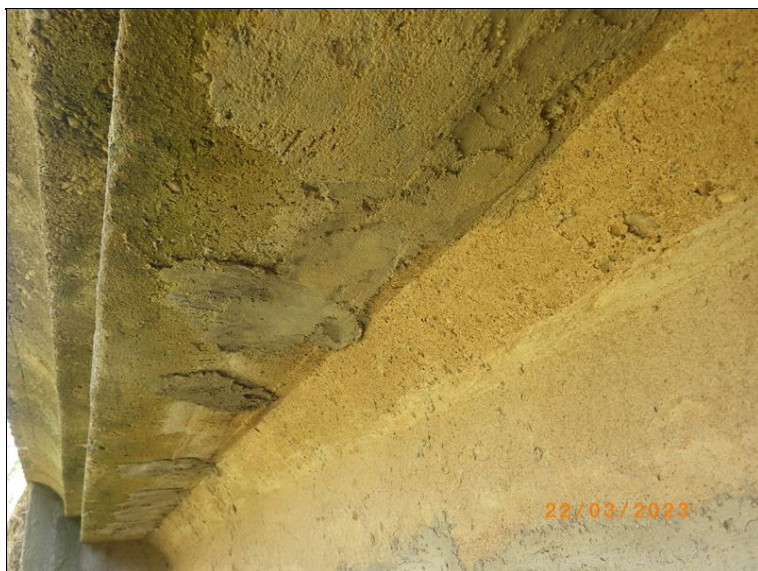
Podhled levé konzoly NK - lokální neodborné opravy
