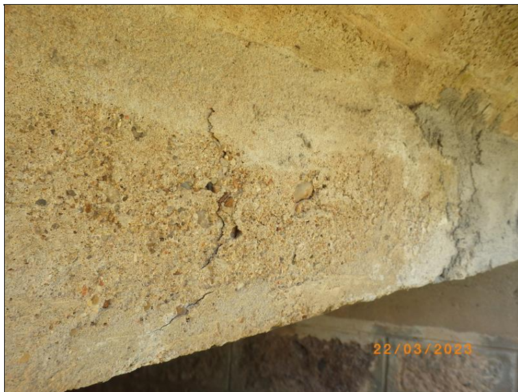
Trhlínky v trámu, neodborné opravy povrchu
