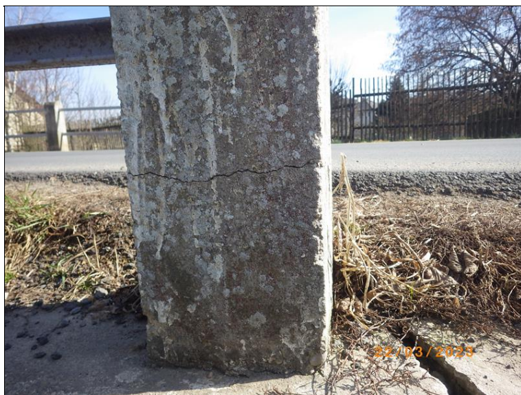
Prasklý 1. levý sloupek zábradlí
