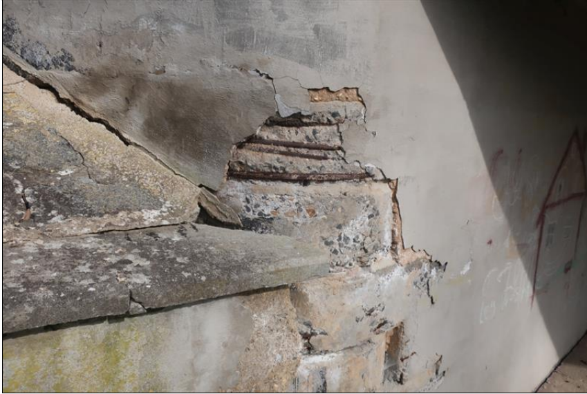
levý bok opěry O2 - poruchy sanací, koroze obnažené výztuže
