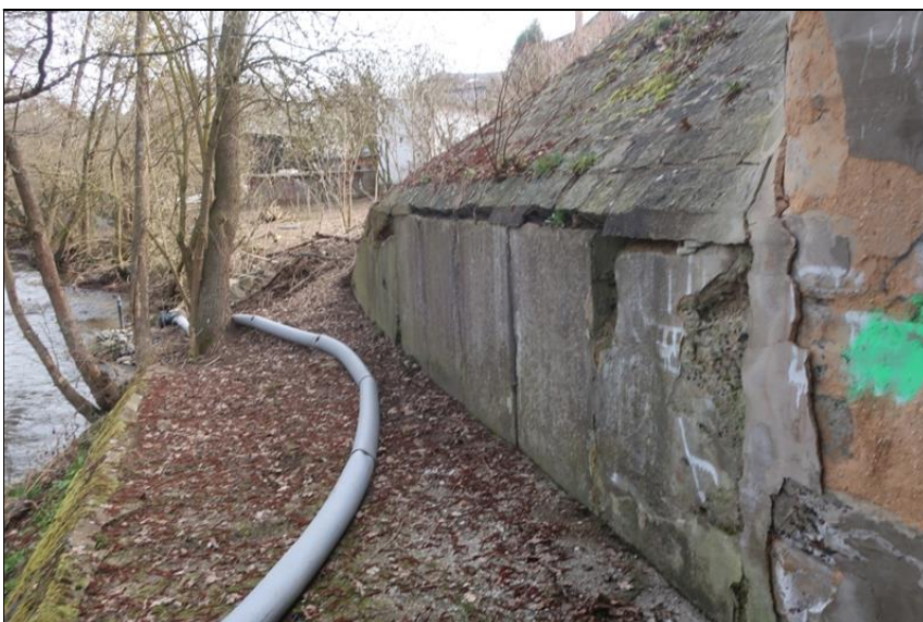
rozpad betonu pravého křídla O1
