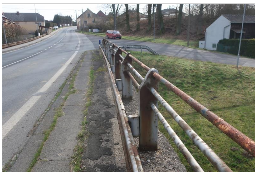
korozí sloupků a výplně levého zábradelního svodidla
