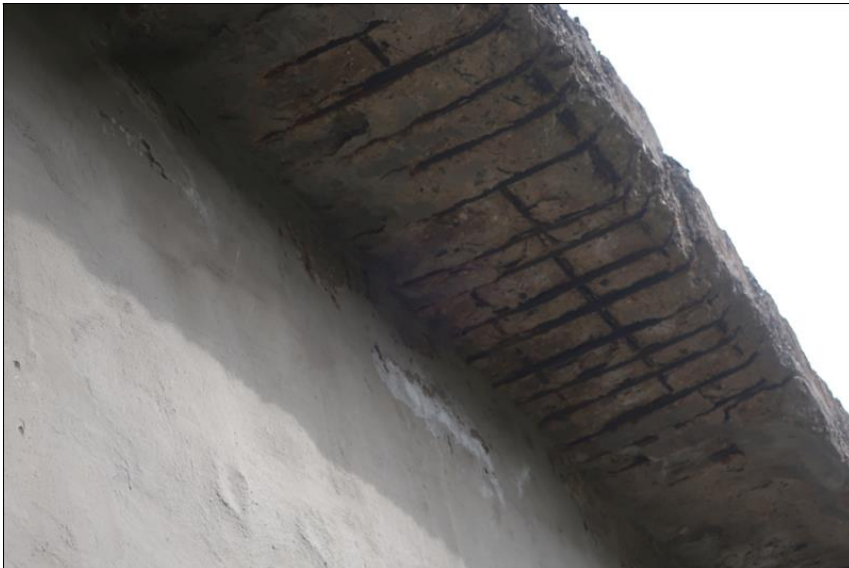
hloubková degradace betonu a intenzivní koroze výztuže na spodním líci levé římsy
