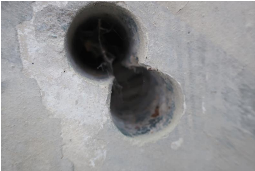
při odvrtávání dutin nosníků došlo k poškození předpínací výztuže nosníků
