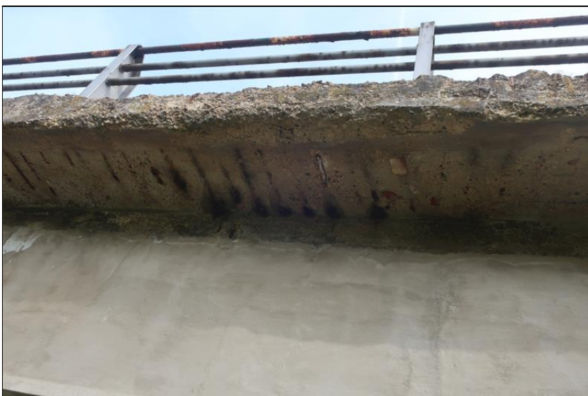
degradace betonu levé římsy
