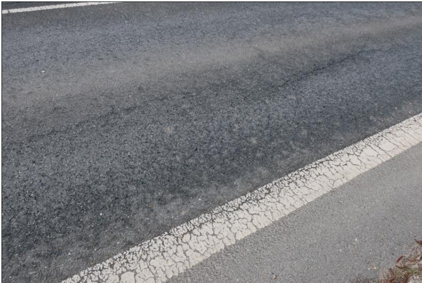
deformace krytu vozovky
