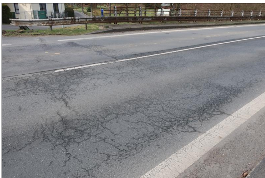
nepravidelné trhliny v krytu vozovky před opěrou O1
