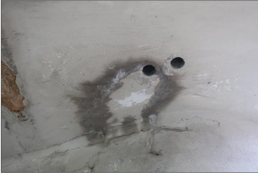
stopy po průsaku z dutiny nosníku u O2
