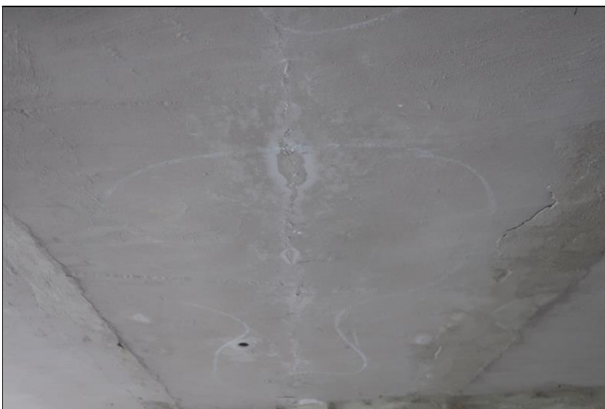
podélná trhlina se stopami po průsacích na spodním líci nosníku kopíruje trajektorii předpínací výztuže
