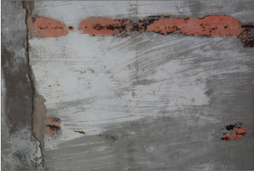
podélná trhlina na spodním líci nosníku kopíruje trajektorii předpínací vzýtuže
