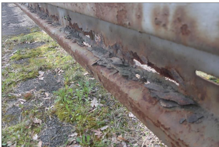
prorezlá svodnice levého zábradelního svodidla
