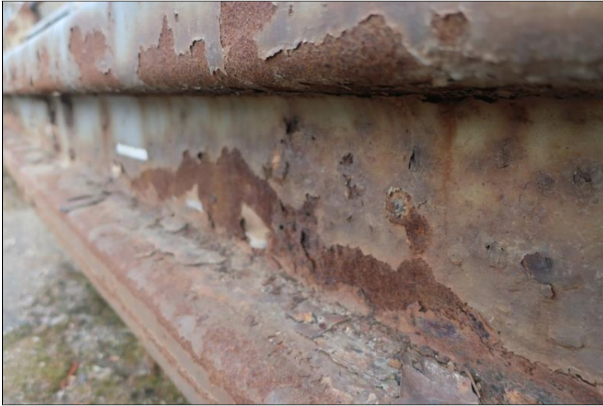
totální koroze svodnice
