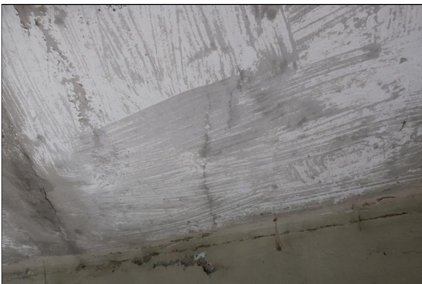
zavhlé trhliny na spodním líci nosníků kopírují trajektorii předpínací výztuže
