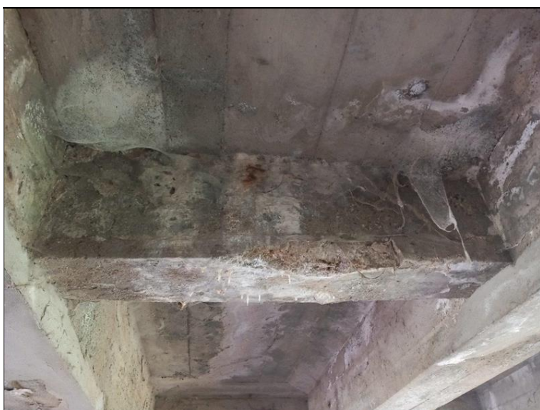
Příčník mezi 2. a 3. trámem zprava u OP1 - silné stopy od zatékání, výluhy pojiva s tvorbou krápníčků, hloubková degradace betonu
