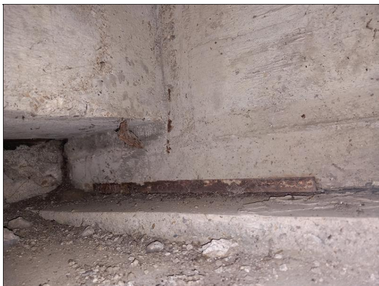
Koroze ocelové desky v místě uložení 3. trámu zprava na OP2 - pohled z boku.
