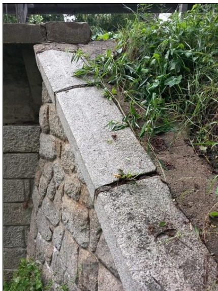
L křídlo u OP1 - degradace výplně spár mezi římsovými deskami, uchycená vegetace ve spárách
