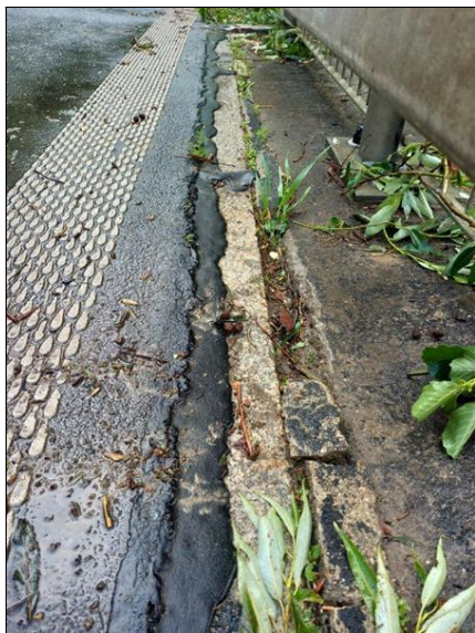
Detail pravé římsy - vozovka na mostě přebalená až přes horní hranu kamenného obrubníku, beton římsy podél kamenné obruby odtržený, uchycená vegetace.
