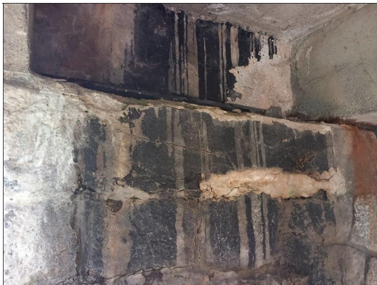
Úl. práh OP2 mezi 1. a 2. trámem zleva - hloubková degradace betonu vlivem zatékání a působení mrazu, výluhy pojiva, znečištění povrchu od asfaltu
