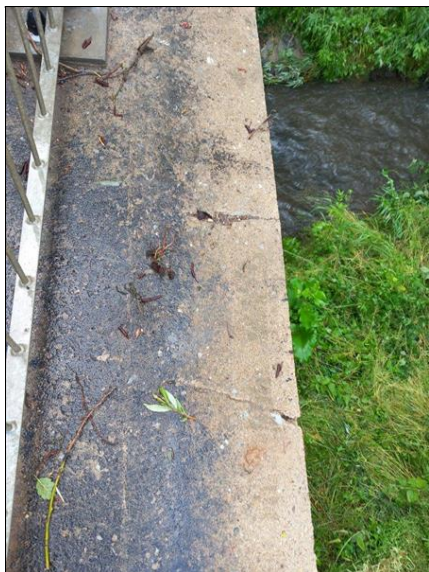
Příčné trhliny v levé římse.
