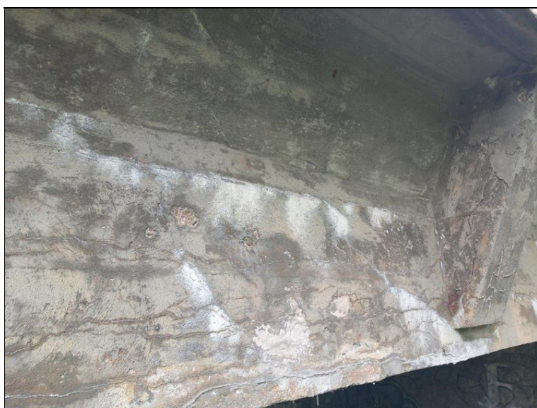
Detail poruch na boku levého krajního trámu u OP2 - hustá soustava zavlhklých rozvětvených vodorovných trhlin, s výluhy pojiva a místy s vyplavenou rží
