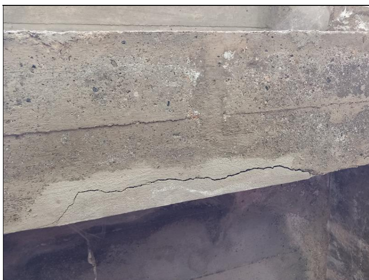
Odtržená sanace na pohledu pravého krajního trámu u OP1
