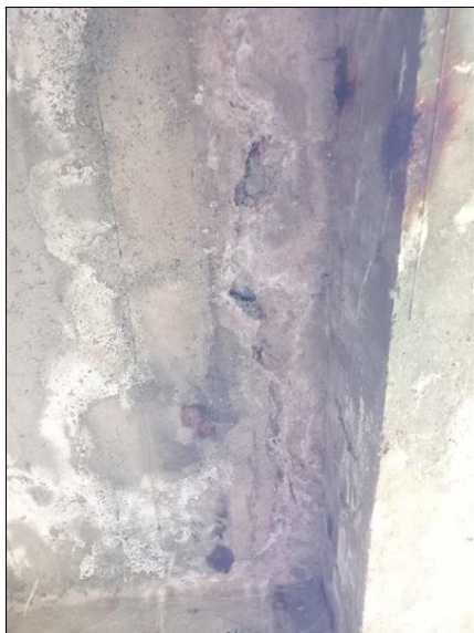
deska NK u krajního levého trámu u OP2 - v náběhu deska/trám souvislá trhlina s vytrženými kusy betonu, průsaky s vyplaveným pojivem, lokálně vyplavená rez
