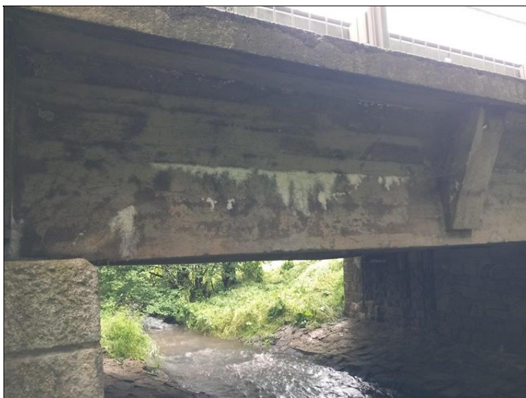
Pohled na pravý krajní trám u OP1 - podélná trhlina na styku trám/deska s výluhy pojiva
