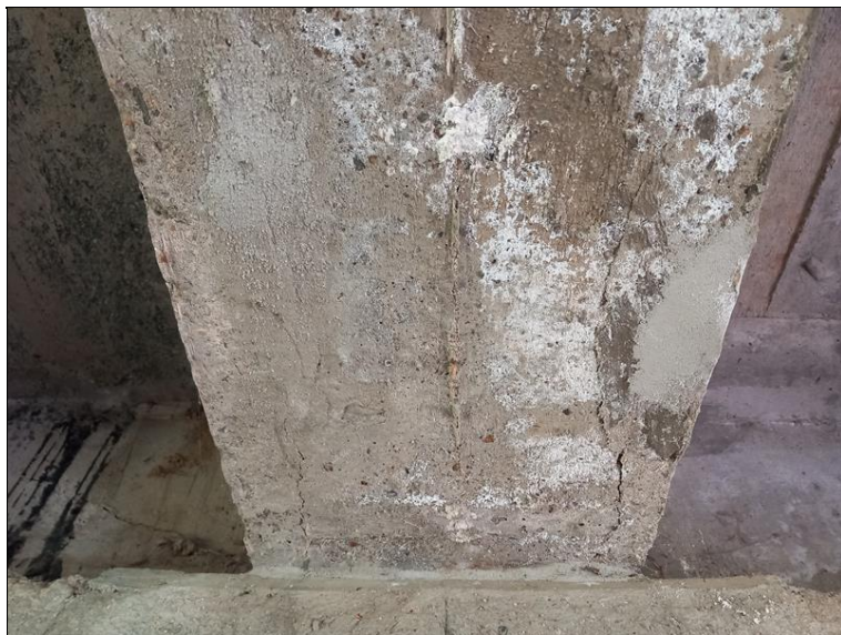
Spodní líc 3. trámu zprava - podél obou hran probíhá souvislá trhлина od uložení na OP1 do vzdálenosti 2,5m od líce OP1
