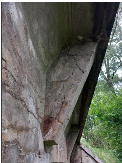
Detail porušení žebra na boku levého krajního nosníku u OP2
