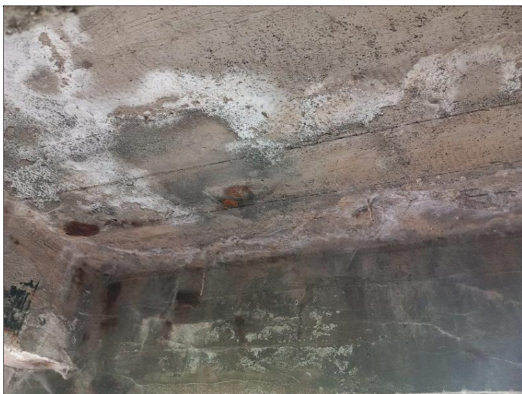
Vnitřní bok levého krajního trámu/příčnick/podhled desky - černé stopy od zatékání s výluhy pojiva a vyplavenou rzi z korodující výztuže
