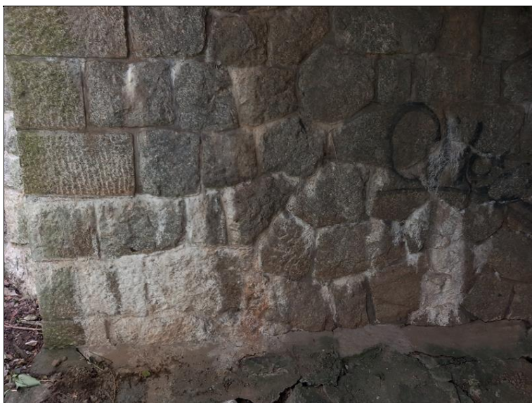
Detail OP1 na pravé straně v líci - stopy od zatékání z rubu doprovázené výluhy pojiva
