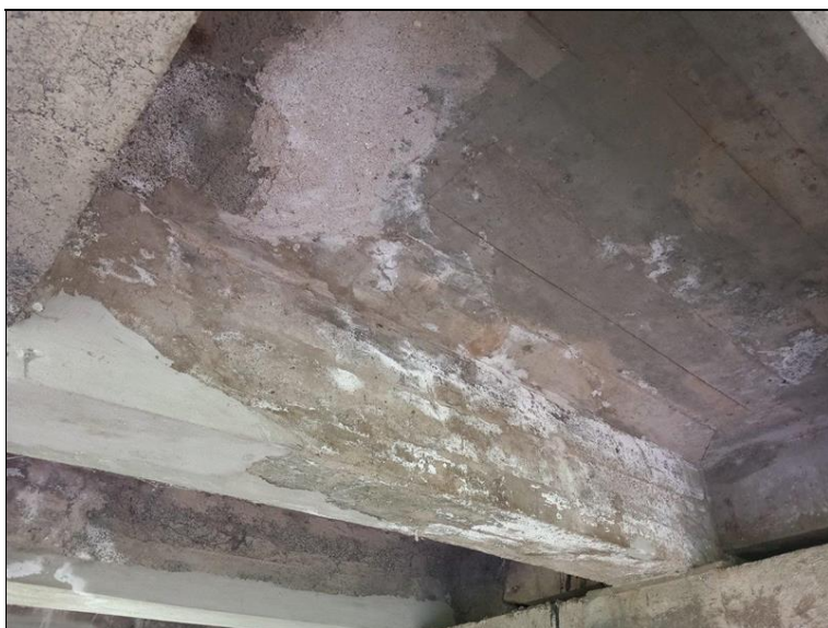
3. trám zprava u OP1 - plošné průsaky doprovázené vápennými výkvěty a výluhy pojiva
