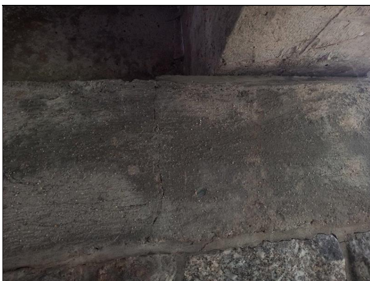
Úložný práh OP2 u pravého krajního trámu - svislá trhlina na celou výšku
