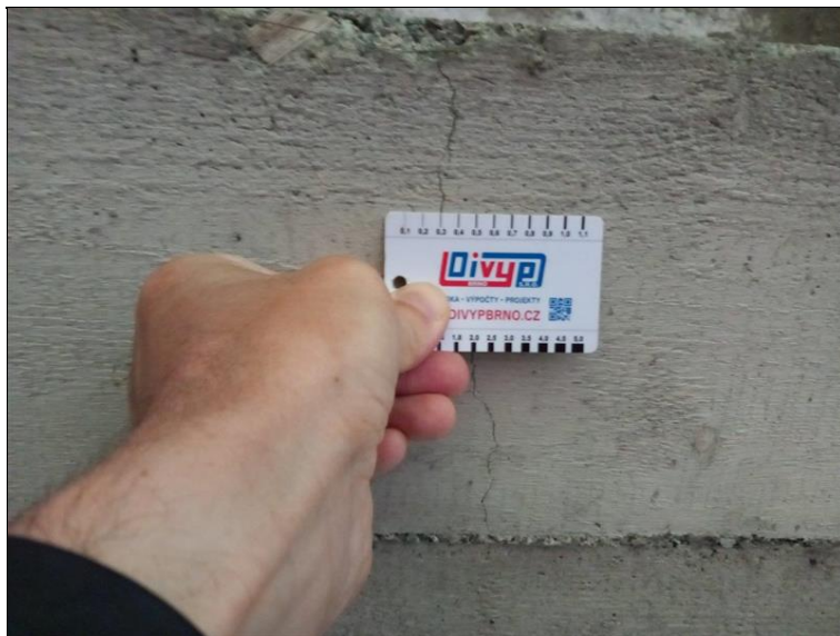
Příčná tahová trhлина na boku 2. trámu zleva v úseku mezi koncovým příčným OP2 a příčným před
