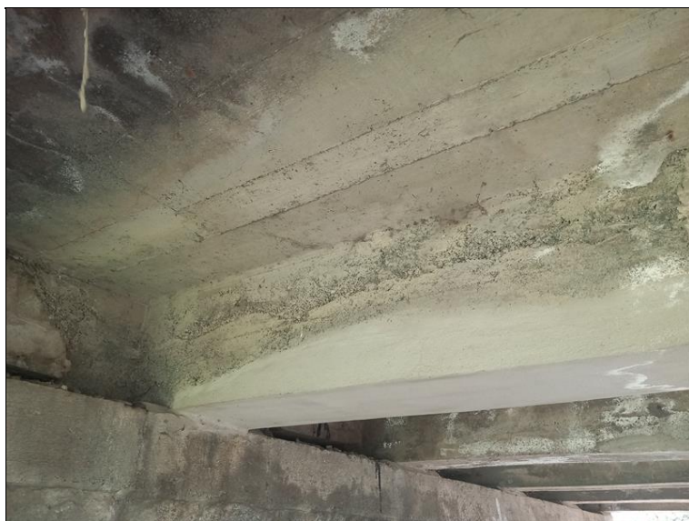
Na svislých plochách 2. trámu zprava u OP1 a částech přilehlého konc. příčníku jsou souvislá štěrková hnízda z doby výstavby.
