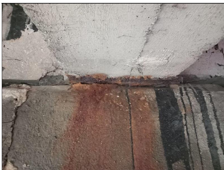
Silná koroze desky v uložení 5. trámu zprava na OP2 - pohled zepředu.
