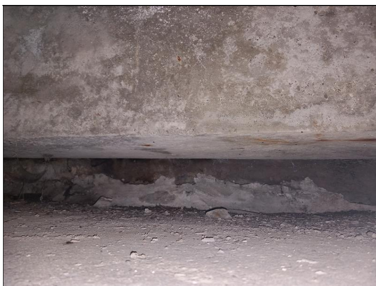
Detail záv. zídky OP2 mezi 1. a 2. trámem zprava - vodorovná trhlina při patě zídky, v minulosti reprofilováno sanační hmotou
