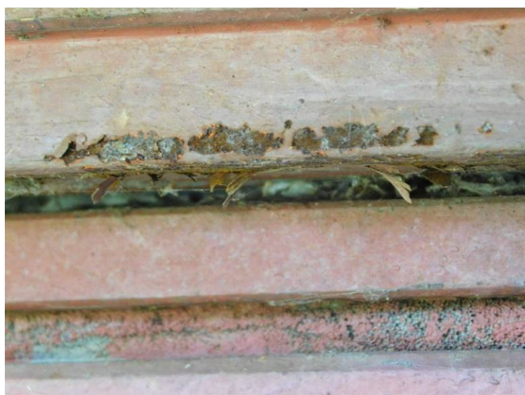
Pi2-L Koroze ocelových prvků
