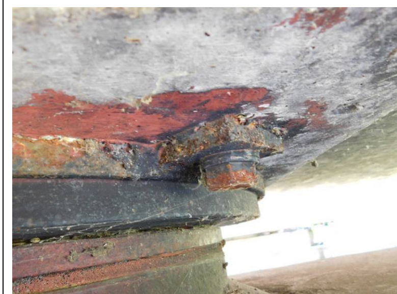
Pi3-L Koroze ocelových prvků
