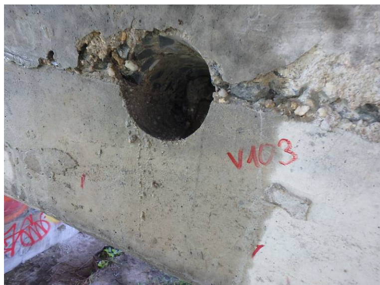
Pohled na spáru s místem zkušebního odvrtu
