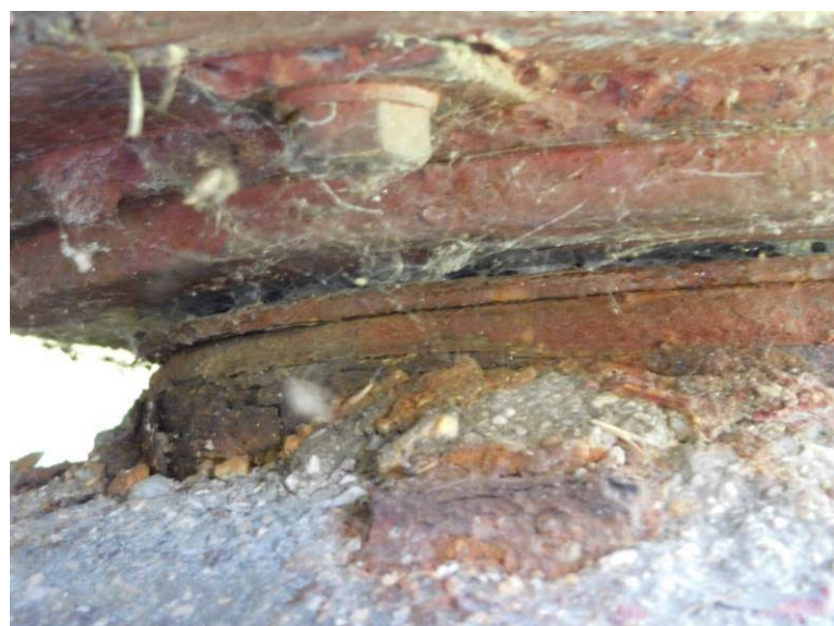
OP1-P Koroze ložiska
