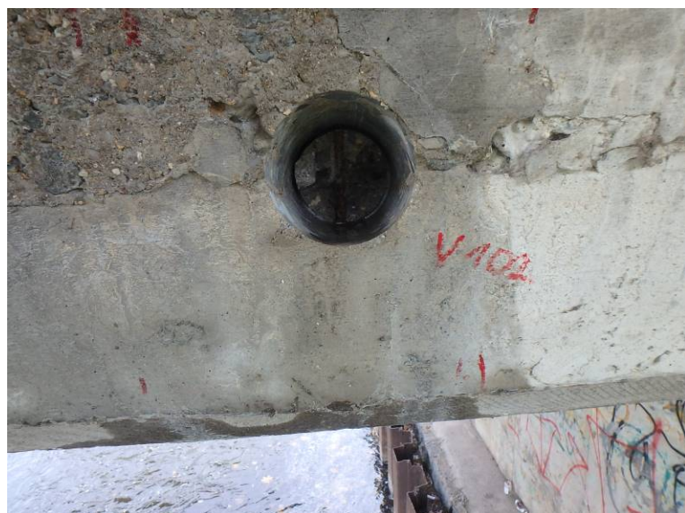
Pohled na spáru s místem zkušebního odvrtu
