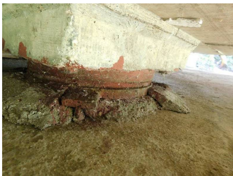
OP1-L Rozpad podbetonování
