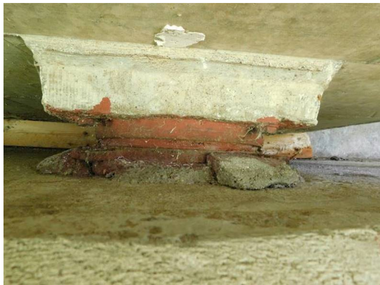
OP1-L Pohled na ložisko čelní
