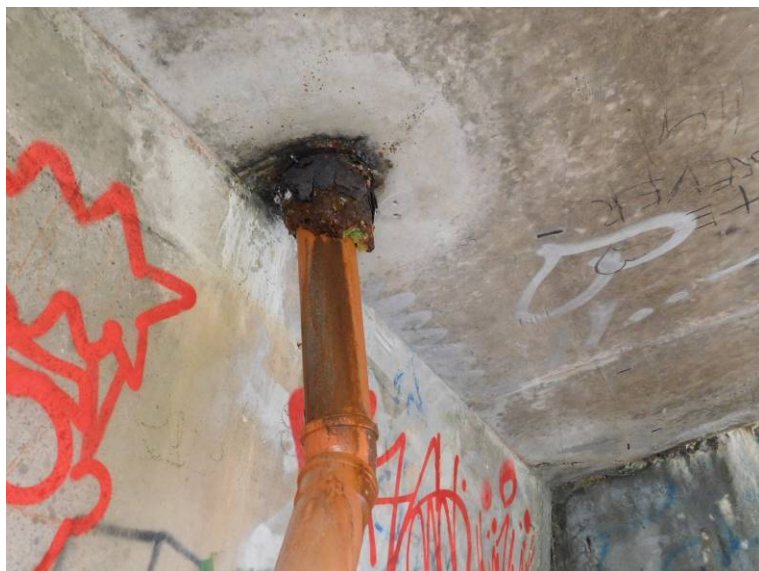
Obecně – koroze svodů odvodnění, v okolí průsaky
