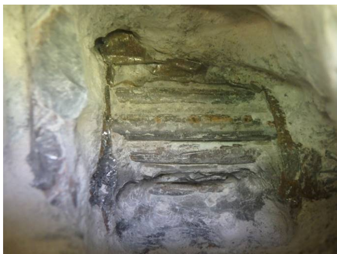
Sonda PV 11 – dráty jsou po odstranění injektáže zcela bez koroze s výjimkou výše uvedeného drátu
