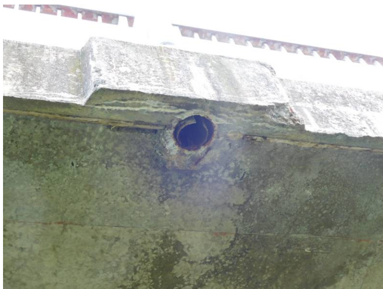
Obecně – průsaky v místě konzol stožárů veřejného osvětlení
