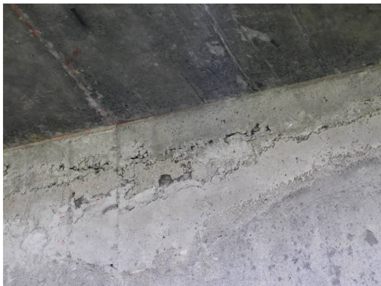
Pole 1 – štěrková hnízda pod pravou konzolou
