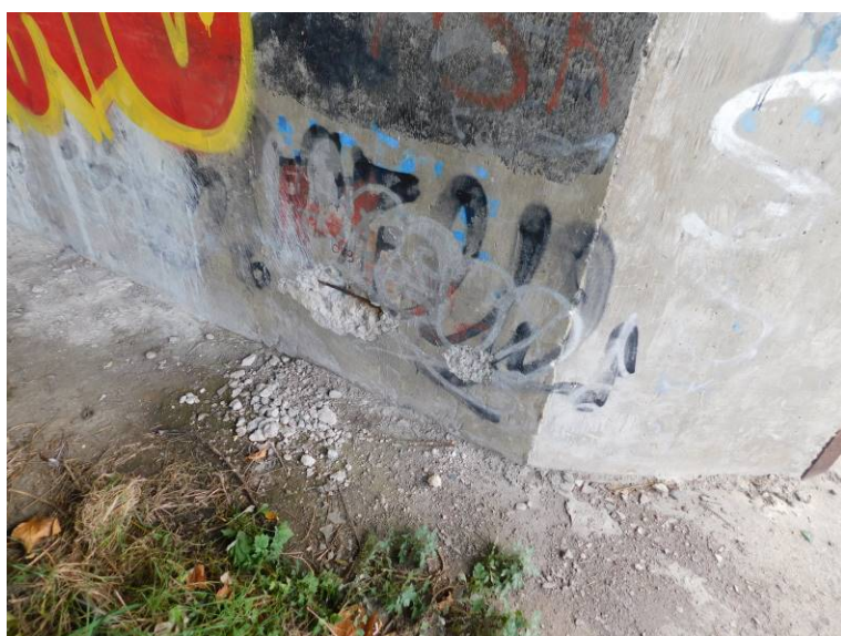
Pilír 2 - separace krycí vrstvy betonu
