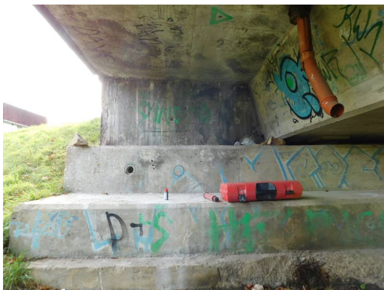
Opěra 4 – zatékání na povrch opěry z dilatační spáry
