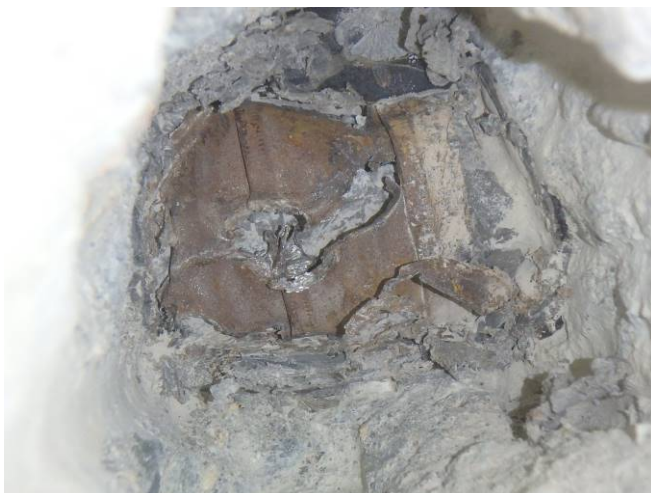
Sonda PV 16 – plošně korodující vnější povrch chráničky Sandrik.
