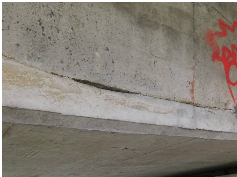
Pole 1 – kaverna v místě spáry po přerušení betonáže
