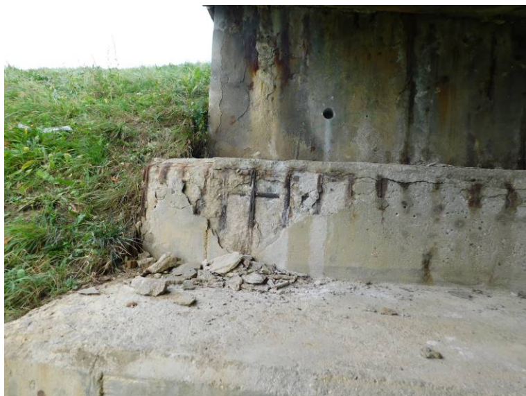
Opěra 1 – degradace betonu v místech zatékání z dilatační spáry
