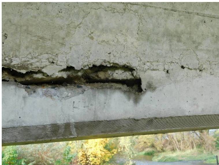
Pole 3 – poruchy v místě spáry po přerušení betonáže
