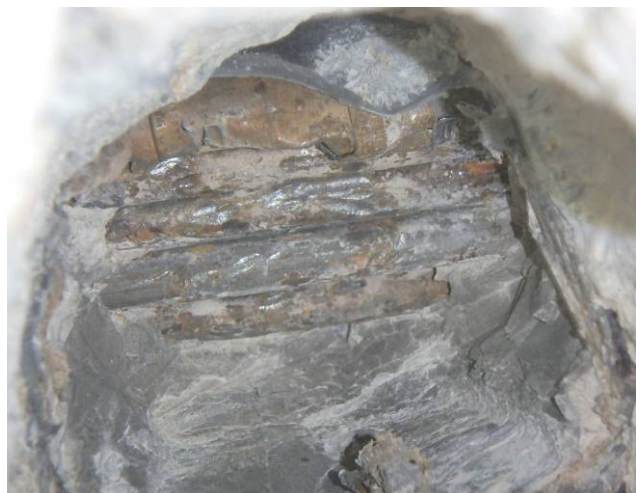
Sonda PV 16 – po otevření chráničky byl kanálek zcela zainjektovaný, dráty povrchově korodují bez oslabení.
