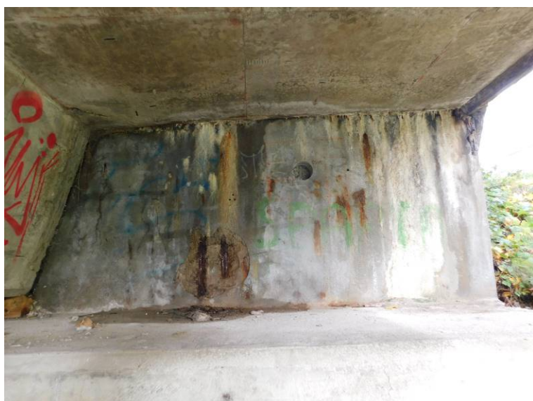
Opěra 1 – zatékání z dilatační spáry
