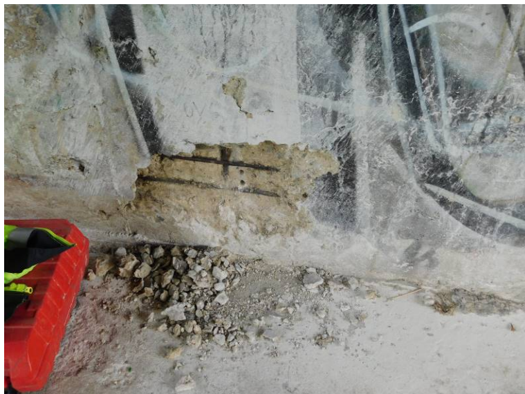
Pilíř 3 - separace krycí vrstvy betonu
