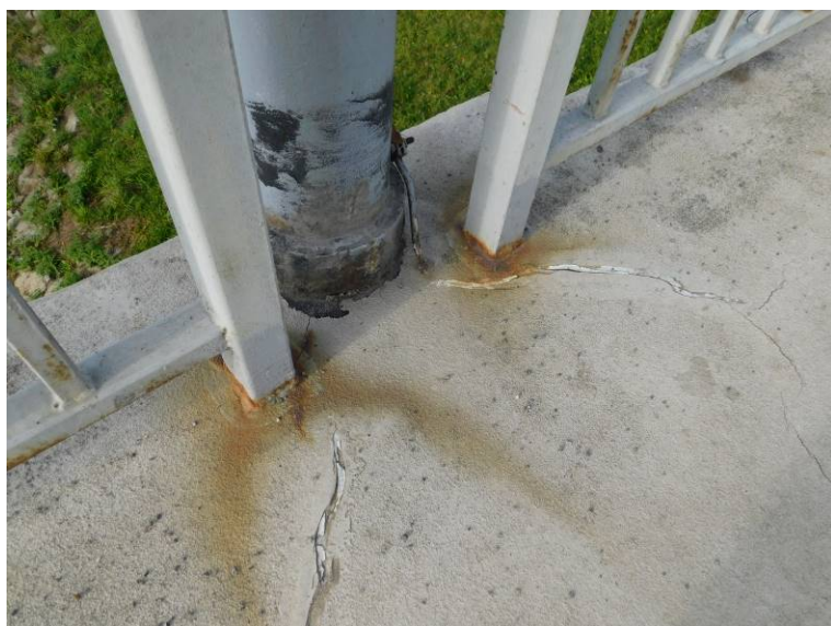
Poruchy přímopochozí izolace chodníků, koroze prvků zábradlí
