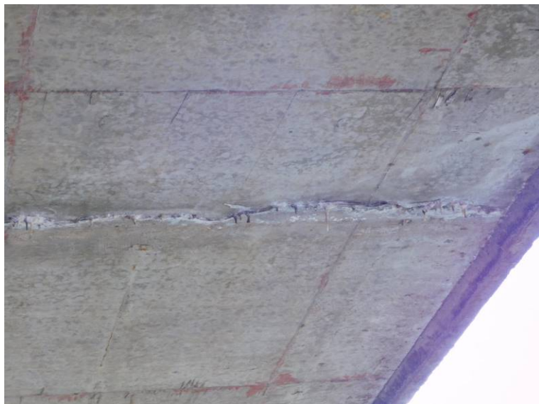
Pole 2 – průsaky v místě příčné pracovní spáry – chodníkové konzoly
