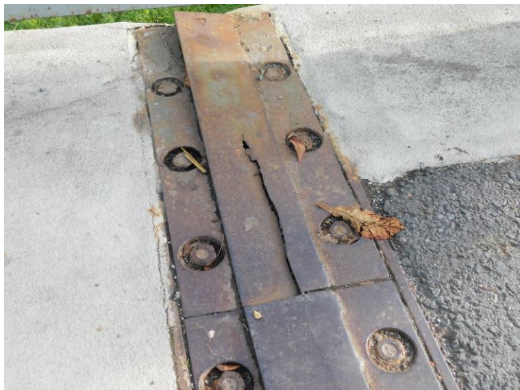
Stav mostního závěru nad Op4
