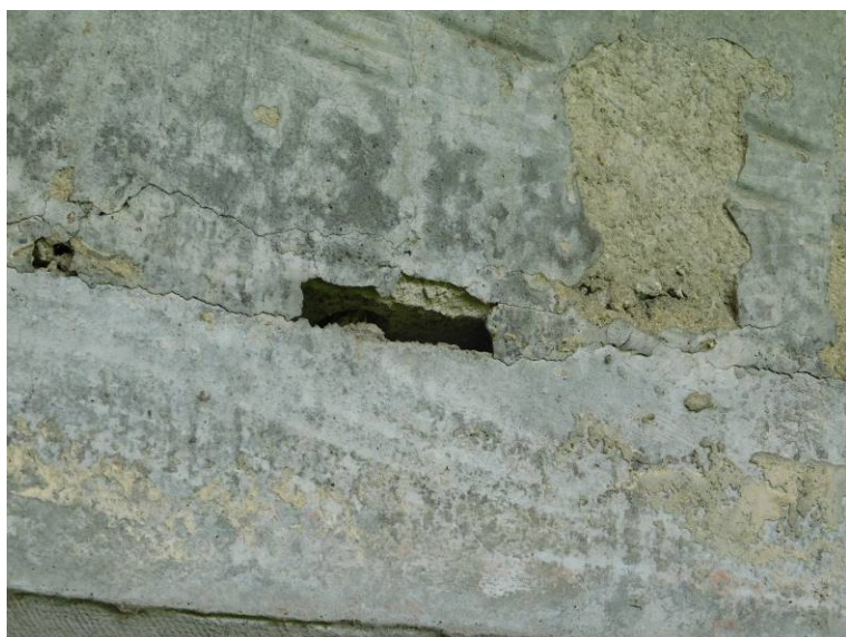
Pole 1 – částečně přesanovaná kaverna v místě spáry po přerušení betonáže
