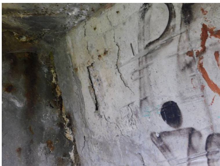
Pole 1 – separace krycí vrstvy na boku konstrukce v místě průsaků u Op 1
