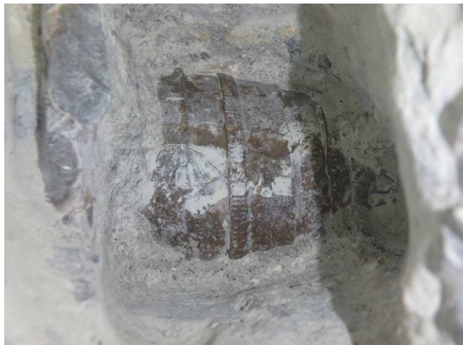
Sonda PV 11 – plošně korodující vnější povrch chráničky Sandrik.
