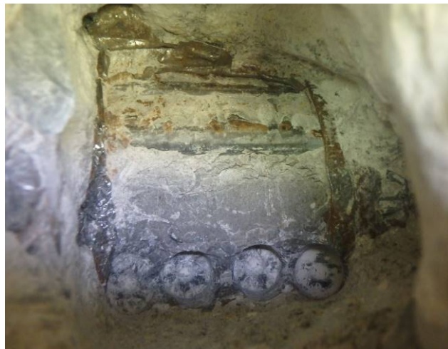
Sonda PV 11 – po otevření chráničky byl kanálek zcela zainjektovaný, jeden z drátů vystupoval na povrch injektáže a dotýkal se korodujícího vnitřního povrchu chráničky Sandrik.
