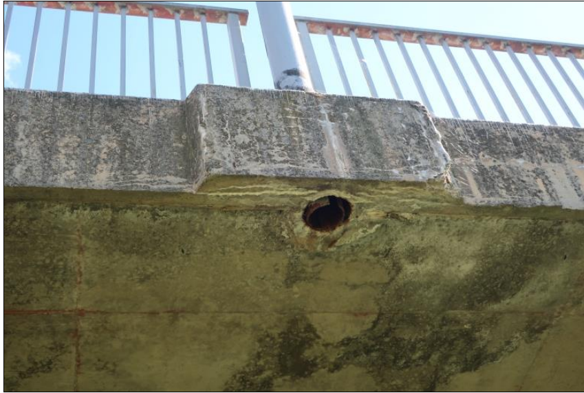
mrazový rozpad betonu pravé konzoly v místě vetknutí sloupu VO u P3
