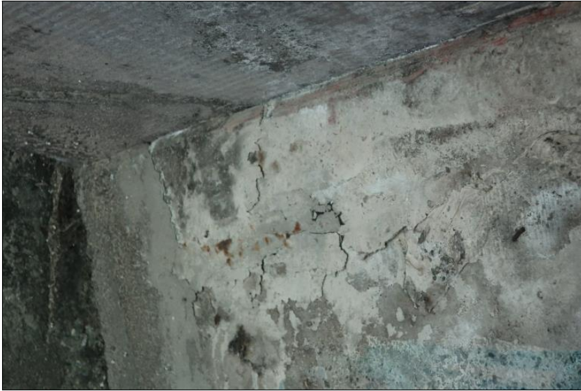
separace krycí vrstvy nad korodující výztuží na levém boku desky nad O4
