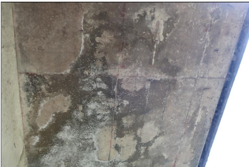
rozsáhlé výkvěty na spodním líci levé konzoly v oblasti P3
