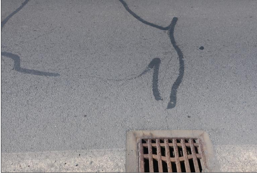
nepravidelné trhliny v krytu vozovky v okolí odvodňovače
