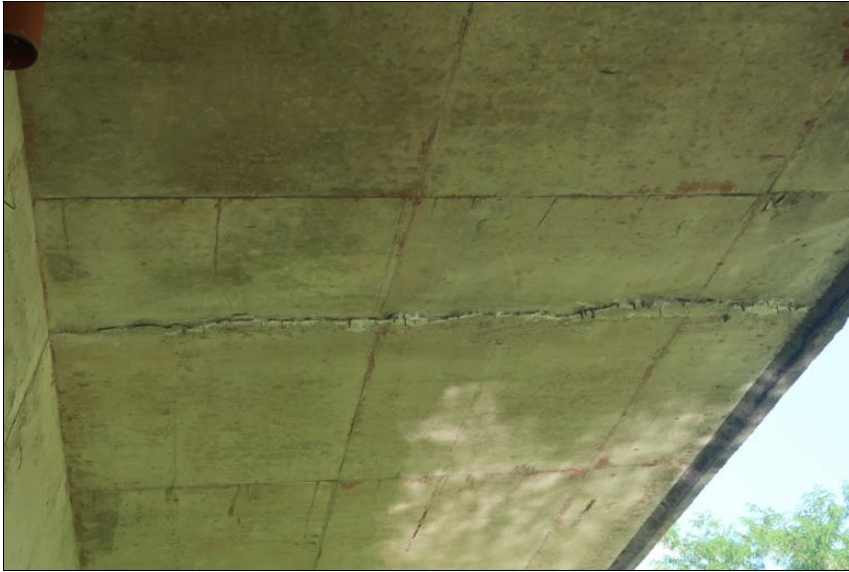
stopy po průsaku příčnou sparou mezi betonážními závěry na spodním líci levé konzoly ve 2. poli
