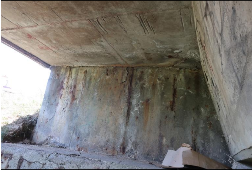
stopy po průsacích se stopami koroze výluhů pojiva na líci ZZ O1 vpravo
