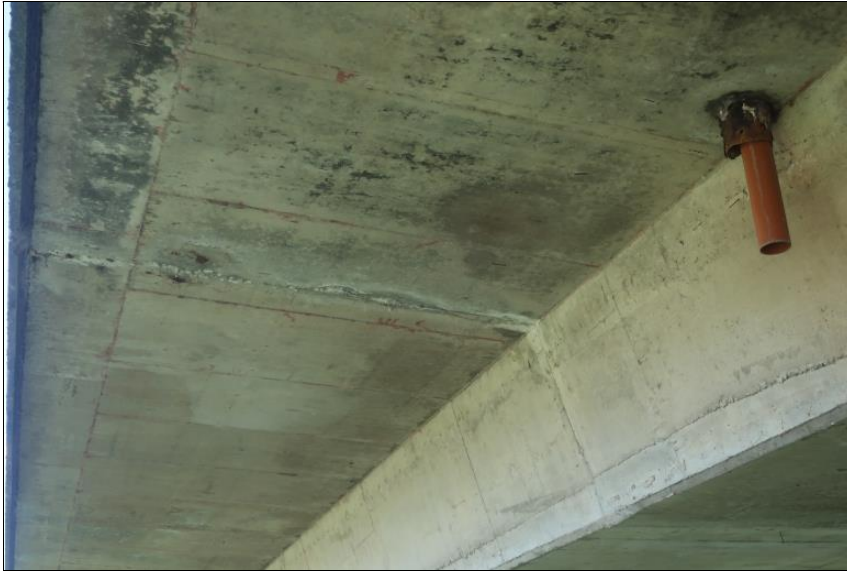
stopy po průsaku příčnou sparou mezi betonážními závěry na spodním líci pravé konzoly ve 2. poli
