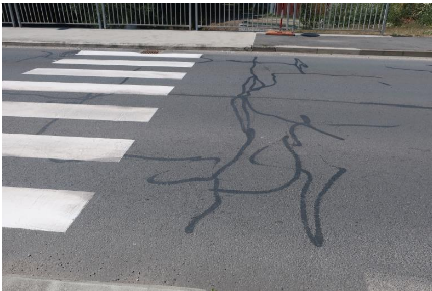
příčné trhliny v krytu vozovky nad O4
