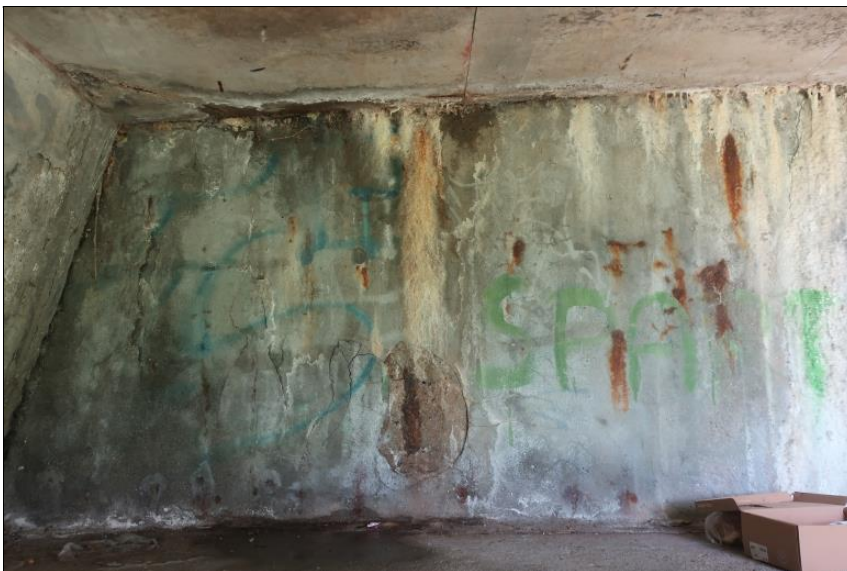
stopy po průsacích se stopami koroze výluhů pojiva na líci ZZ O1 vlevo
