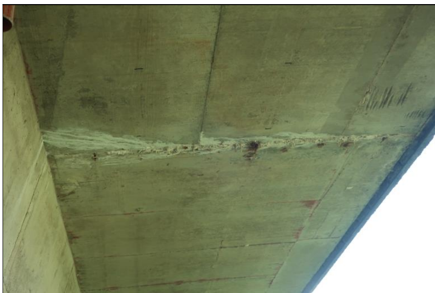
stopy po průsaku příčnou sparou mezi betonážními závěry na spodním líci pravé konzoly ve 2. poli (u P2)
