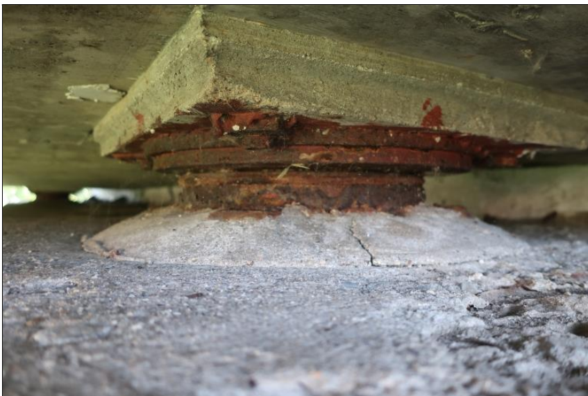
pravé ložisko O4 oříčná trhlina v podkladním bloku
