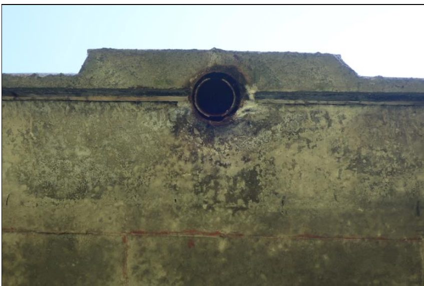
stopy po průsaku na spodním líci pravé konzoly v okolí sloupu VO v místě P3
