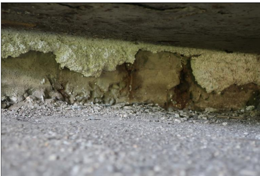
obnažená korodující výztuž v oblasti vetknutí závěrné zídky do úložného prahu u O4
