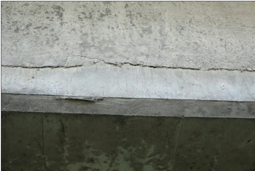
otevřená spára v oblasti přerušené betonáže na boku NK
