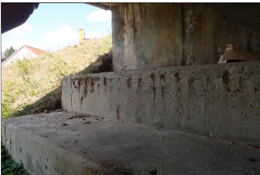
hloubková degradace betonu a intenzivní koroze výztuže ÚP O1 vpravo
