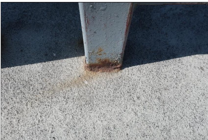
korozí sloupku zábradlí
