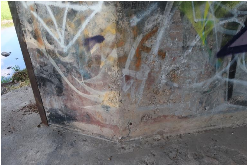
povrchová degradace betonu na líci P3
