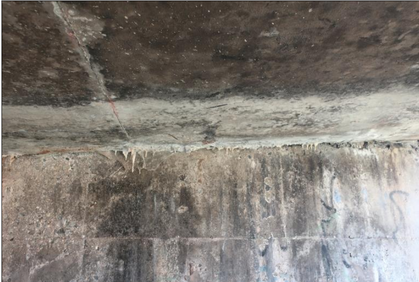
stopy po průsaku s výluhy pojiva na spodním líci pravé konzoly pod MZ O4
