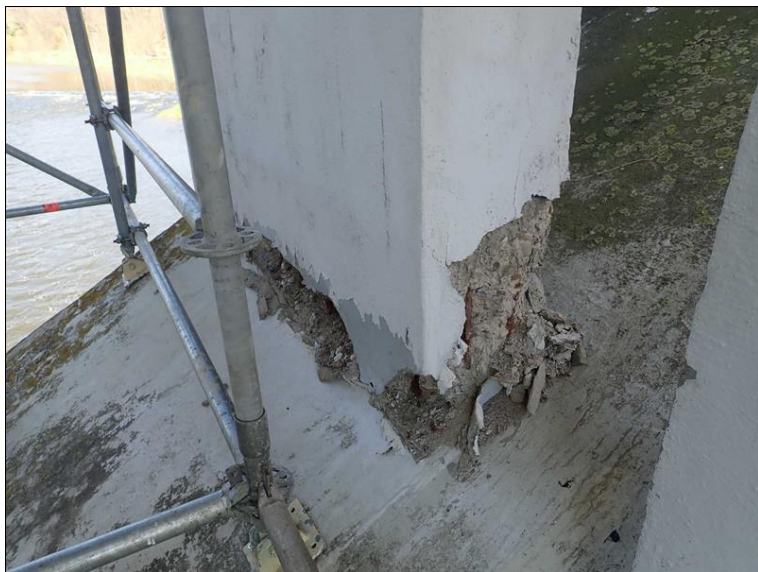
Stojka B, pole 4/1 - rozpad betonu, koroze výztuže s oslabením (viz diagnostický průzkum).
