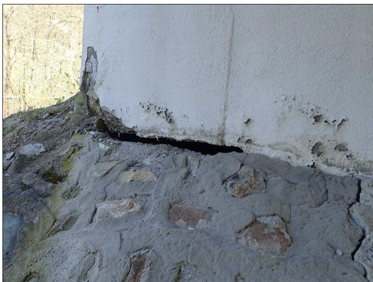
OP1 vlevo - degradace betonu, kaverna.
