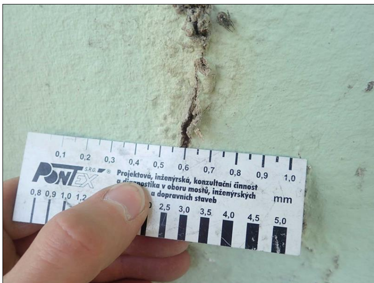
Šířka trhliny v bolouku přecházející do pilíře je 0.6 mm.
