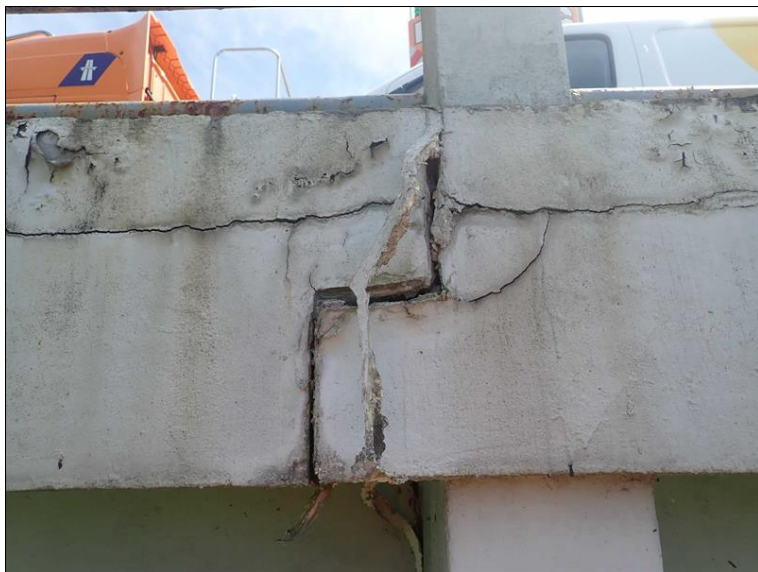
Pohled na dilatační spáru - odpadlé těsnění, degradace betonu.
