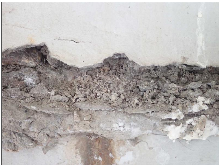
Degradace betonu příčniku u stojky P5 vlevo.
