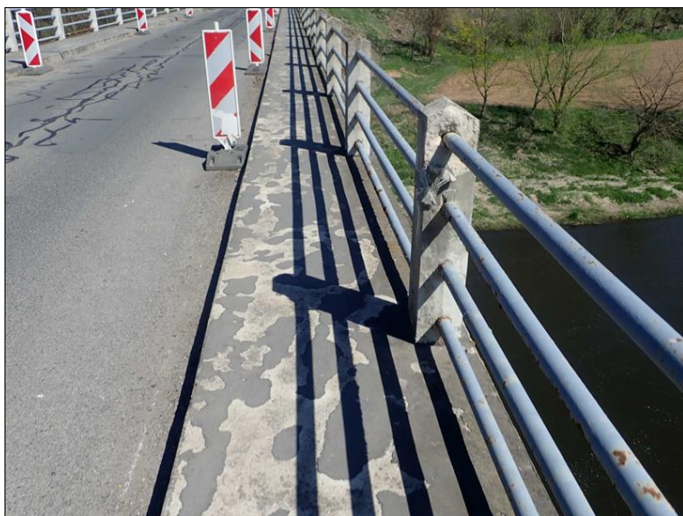
Loupe se izolace chodníku.
