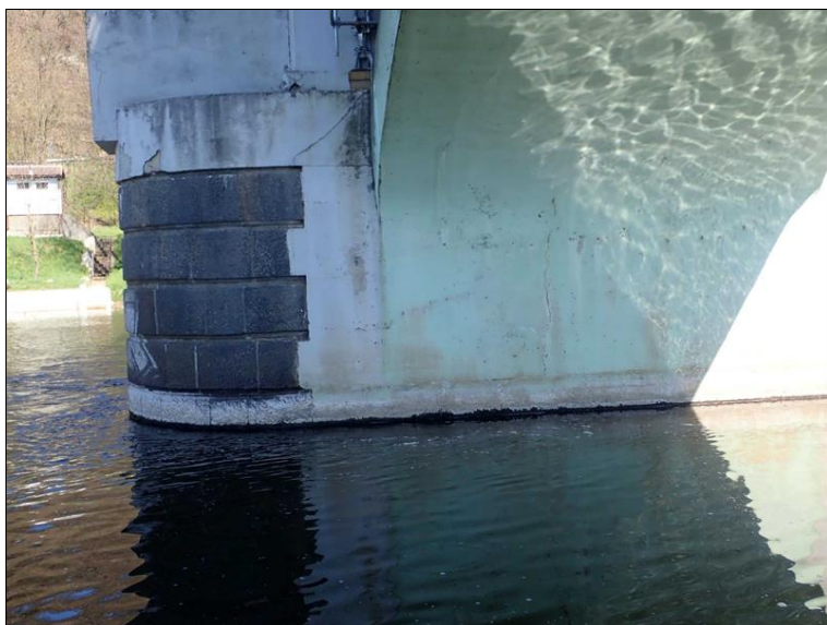
P4 vlevo - svislé trhliny s výluhy, šikmá trhlina mezi obloukem a pilířem
