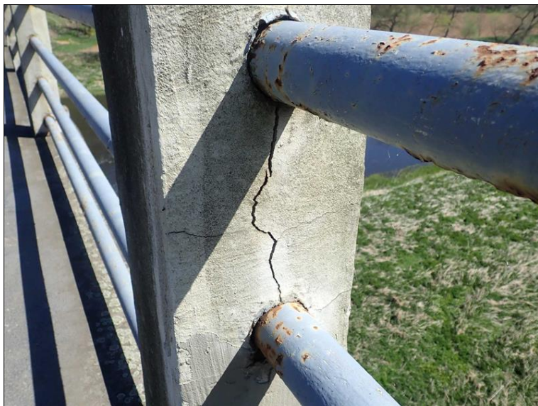
Trhlina ve sloupku zábradlí.
