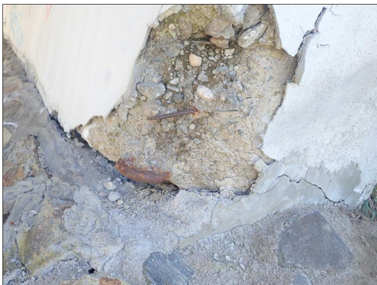
Degradace betonu na OP1 vlevo.
