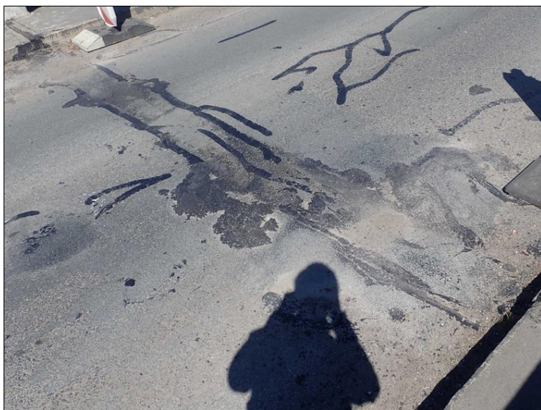
Nerovnosti vozovky u mostního závěru nad P4.
