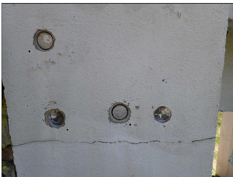
Vodorovná trhlina v OP1 vlevo.
