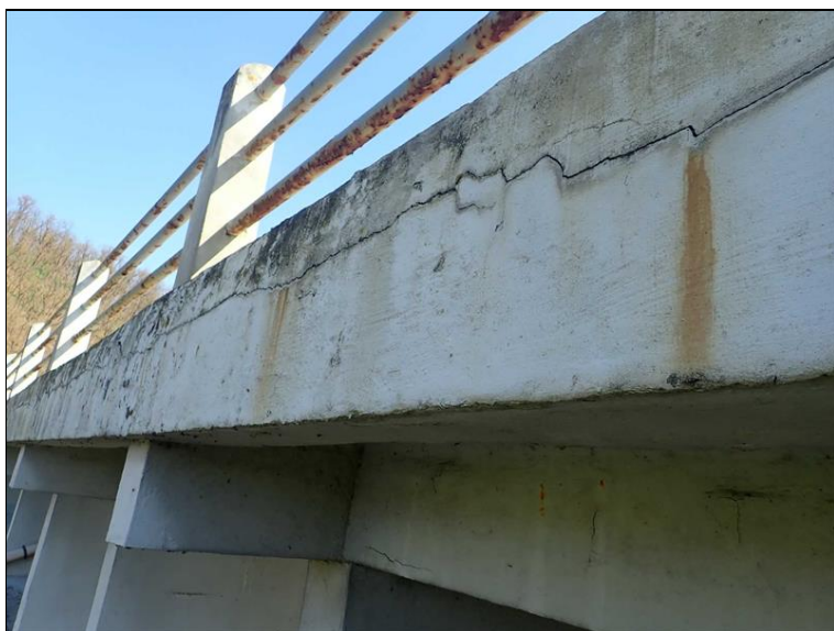
Oddělení římsy od nosné konstrukce.
