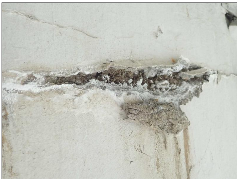
Degradace betonu příčniku u stojky P5 ve středu šířky.
