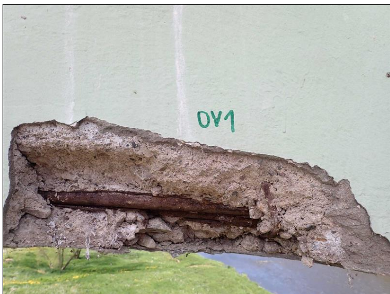
Podélné trhliny na dolním líci oblouku v poli 3 indikovaly závadu - odpadnutí celé hrany. Objevuje se vrstevnatá koroze výztuže.
