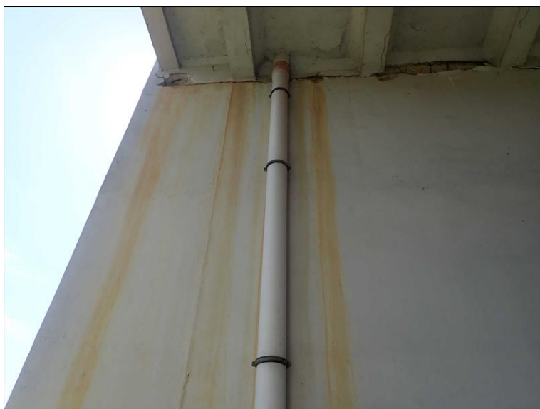
Zatékání z uložení stojky P3.
