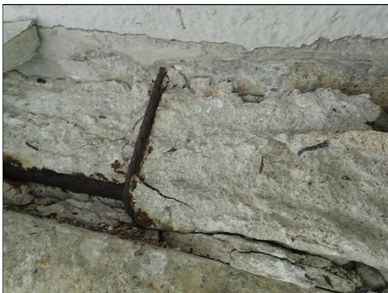
Příčník nad stojkou P3 vpravo - odpadlé kusy betonu až 8 cm + celá sanace.
