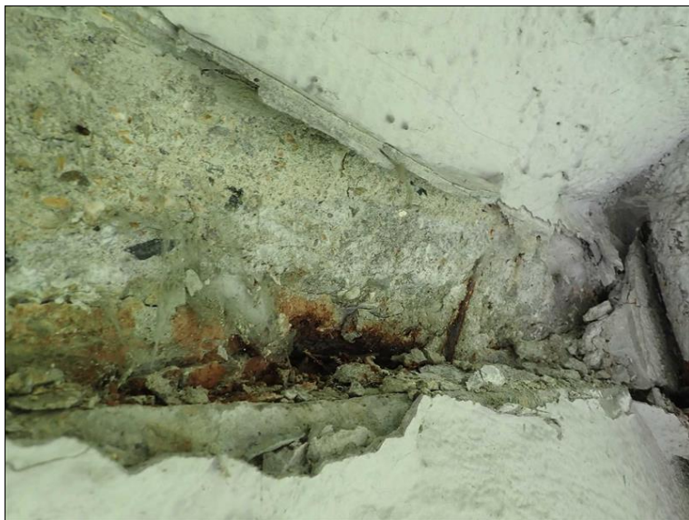
Příčnick nad stojkou P3 střed šířky- odpadlé kusy betonu až 8 cm + celá sanace.
