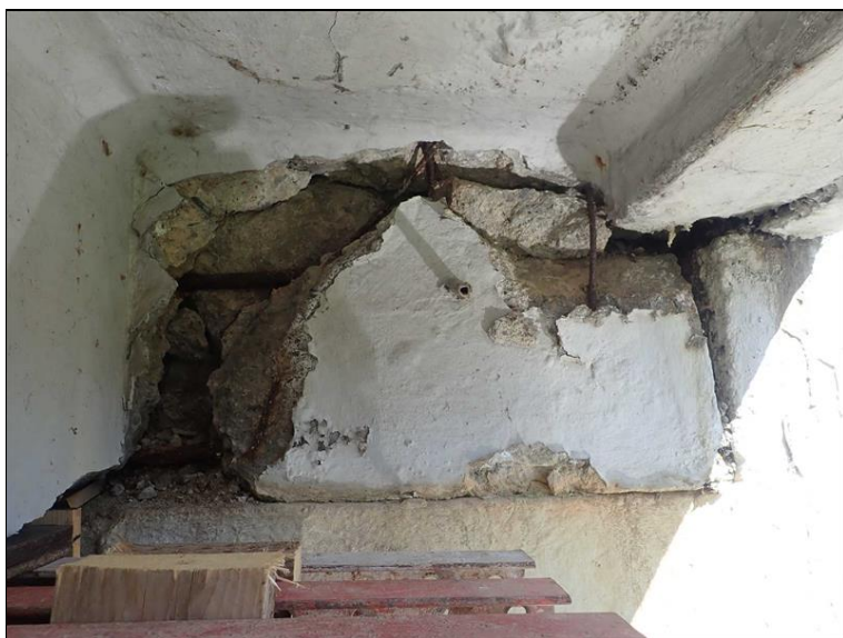
Hlavní závadou NK jsou rozpadající se příčnicky. Viz předchozí MPM - 24.03.2021.
