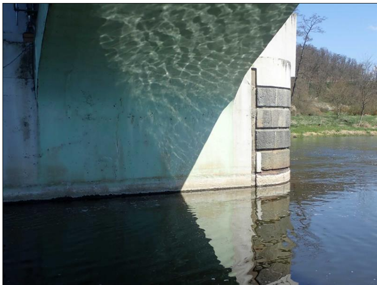
P4 vpravo - svislé trhliny s výluhy, šikmá trhlina mezi obloukem a pilířem
