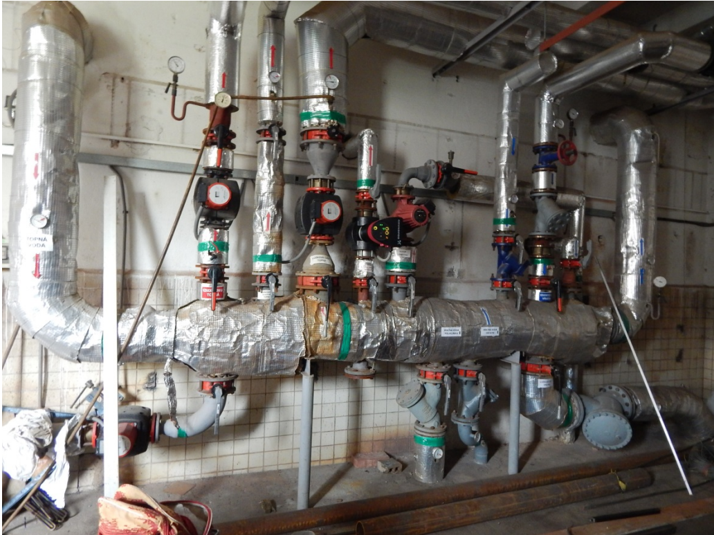
7. Strojovna rozvodu TV v 1.NP u kotelny-hlavní rozvod do systému
