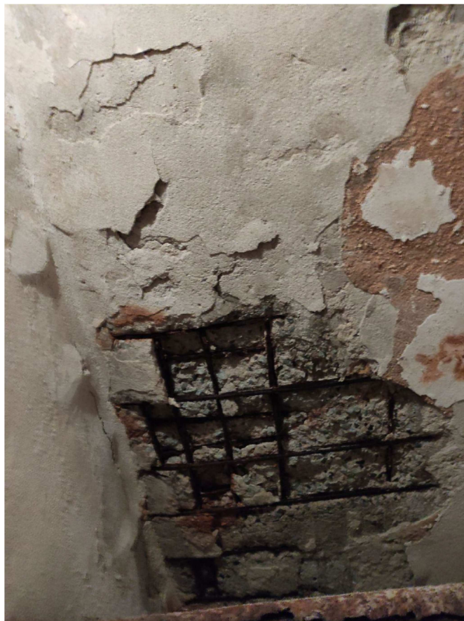
11. Narušené stavební konstrukce v 1.PP
