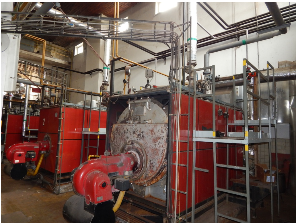
2. Teplovodní kotle v 1.NP
