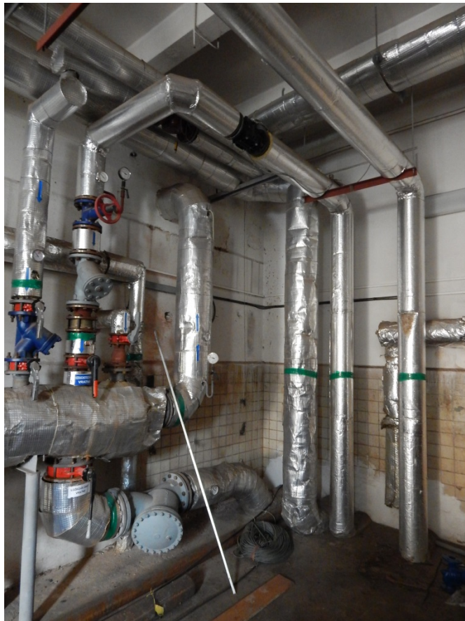
8. Strojovna rozvodu TV v 1.NP u kotelny-hlavní rozvod do systému
