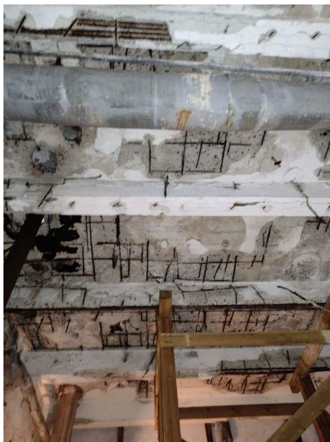
10. Narušené stavební konstrukce v 1.PP
