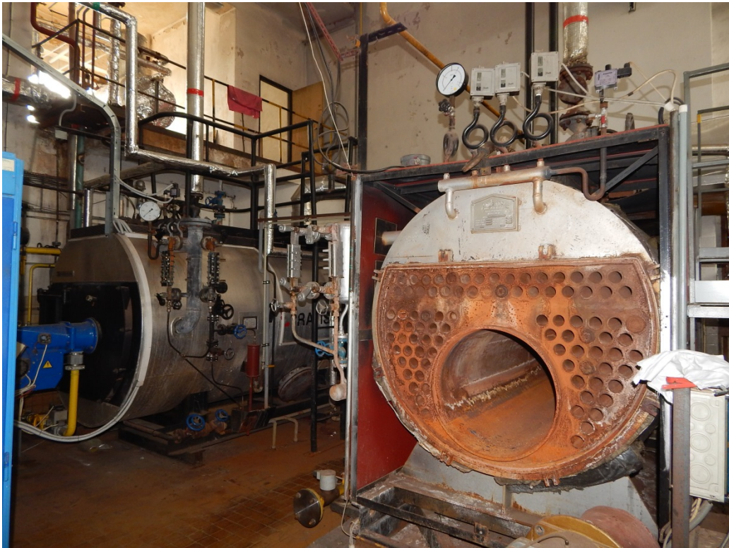
1. Parní kotle v 1.NP
