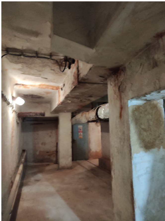
9. Narušené stavební konstrukce v 1.PP
