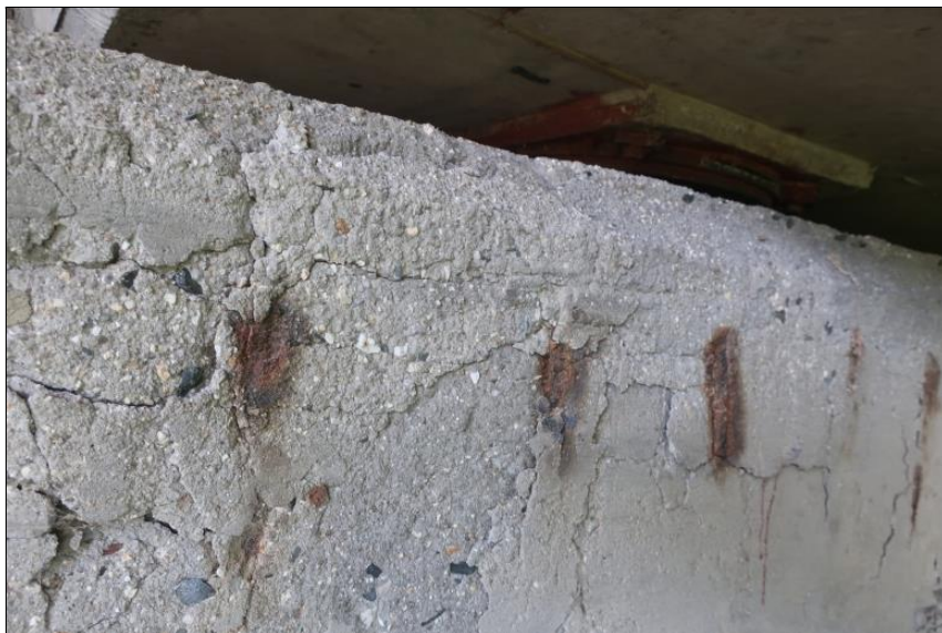
detail poruch v hraně ÚP O1
