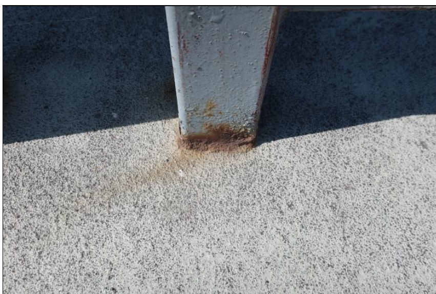
koroze sloupku zábradlí
