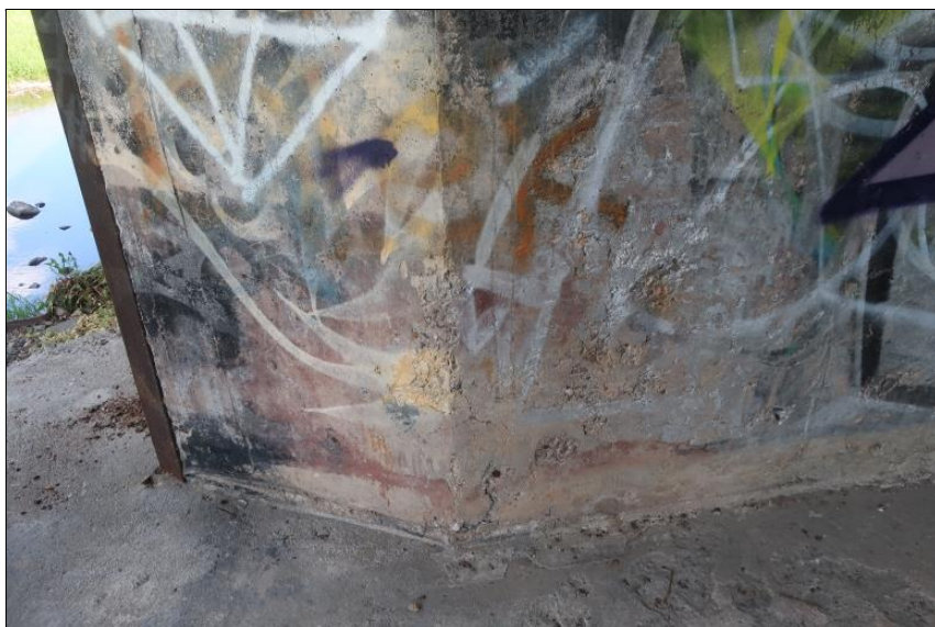
povrchová degradace betonu na líci P3
