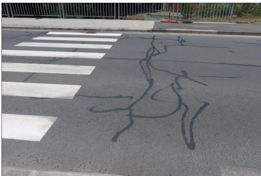
příčné trhliny v krytu vozovky nad O4
